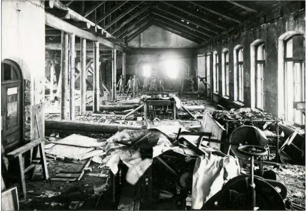
105. Внутренний вид цеха до восстановления (современный корпус лит. В). До 1924 г. // Музей фабрики «Светоч».
