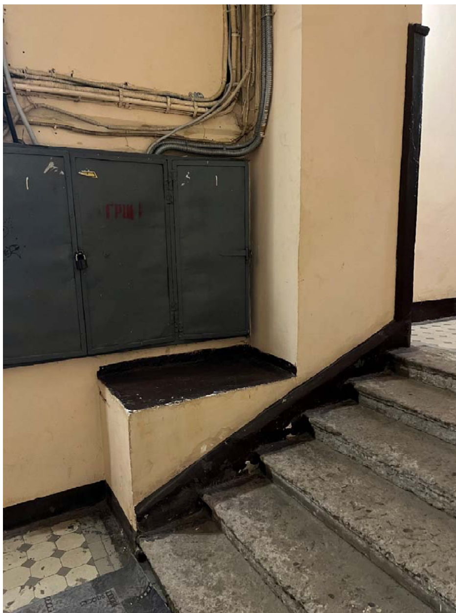
Фото №7. Вестибюль лестничной клетки 1ЛК, ступени лестничного марша, распределительный щит.
