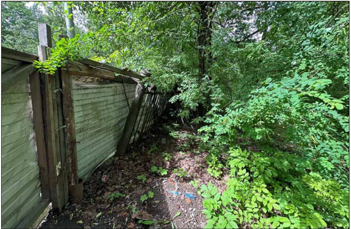
52. Фрагмент ограды с западной стороны выявленного объекта культурного наследия «Офицерское собрание лейб-гвардии 1-го Стрелкового полка (с садом)». Вид с юго-востока. 12.06.2024 г.
