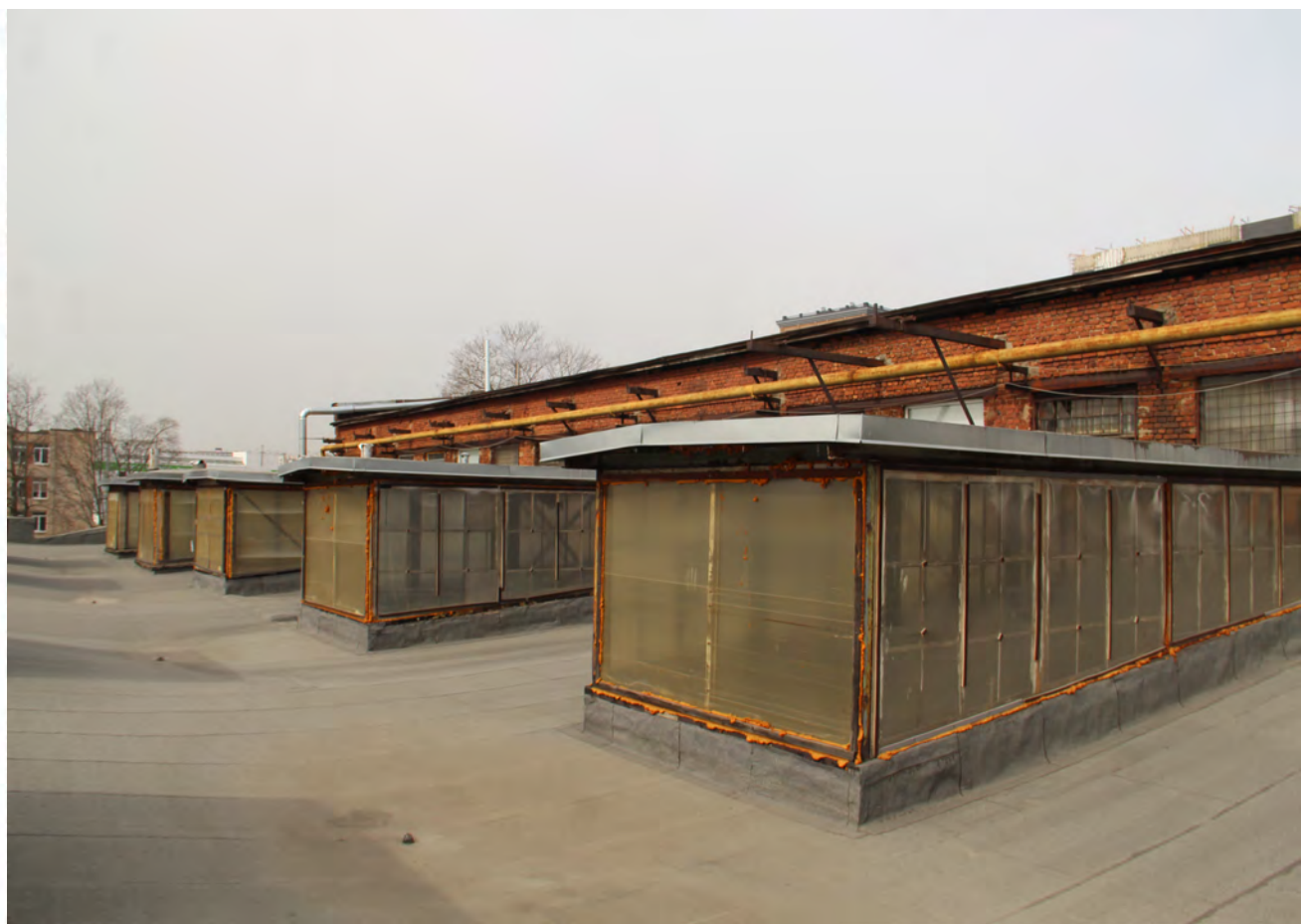
Фотография 13. Выявленный объект культурного наследия «Комплекс построек Кожевенного завода Товарищества «И. А. Осипов и Ко»». Адрес: Санкт-Петербург, переулок Декабристов, дом 7, литера Т. Фрагмент кровли с видом световые фонари. Дата фотофиксации 18.04.2024 г.
