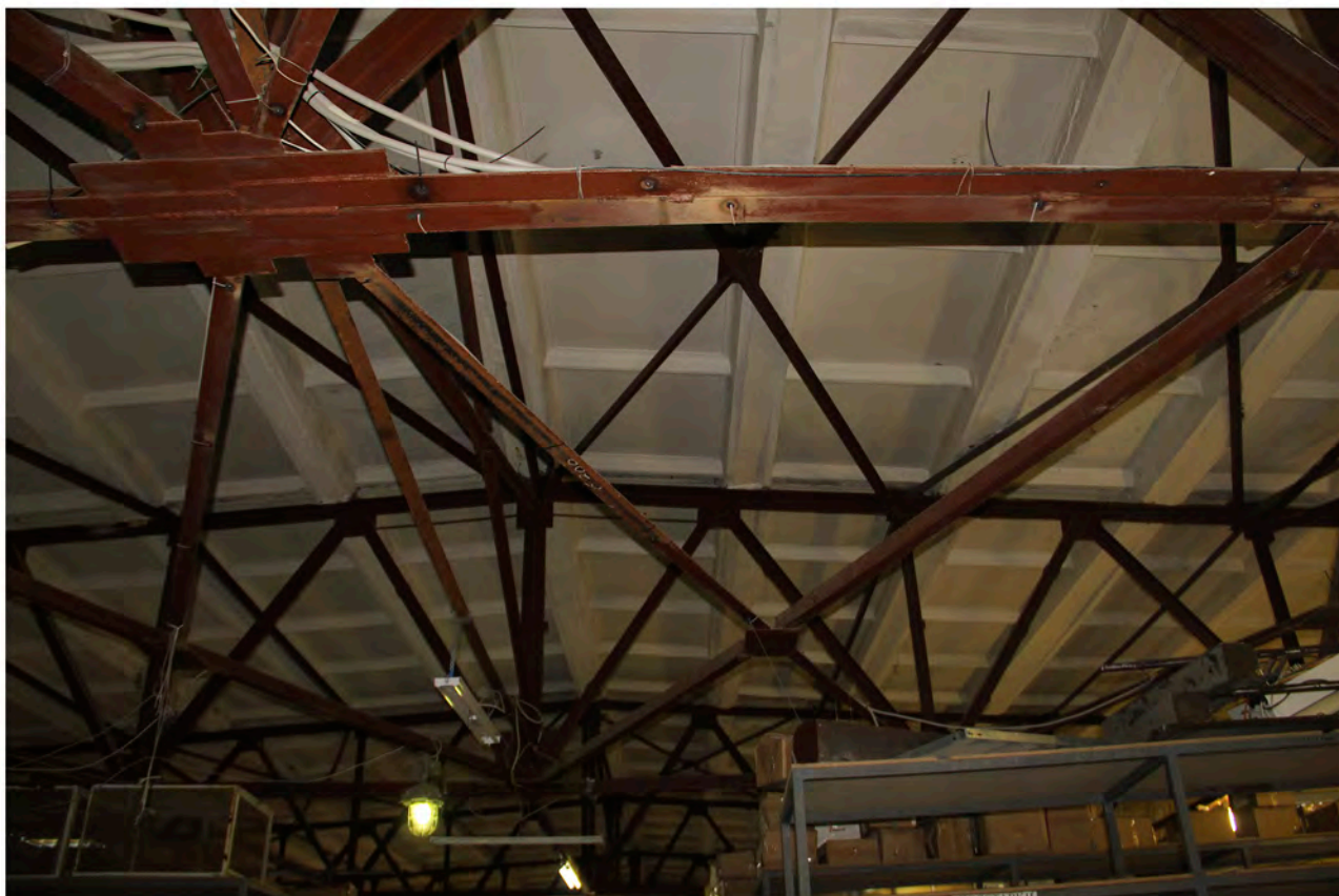
Фотография 60. Выявленный объект культурного наследия «Комплекс построек Кожевенного завода Товарищества "И. А. Осипов и Ко"». Адрес: Санкт-Петербург, переулок Декабристов, дом 7, литера Т. Вид на металлические фермы, 3-ий этаж. Дата фотофиксации 18.04.2024 г.
