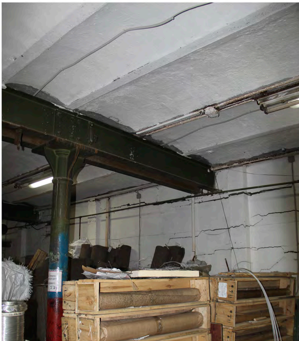
Фотография 61. Выявленный объект культурного наследия «Комплекс построек Кожевенного завода Товарищества "И. А. Осипов и Ко"». Адрес: Санкт-Петербург, переулок Декабристов, дом 7, литера Т. Вид на своды и колонну, 1-ый этаж. Дата фотофиксации 18.04.2024 г.
