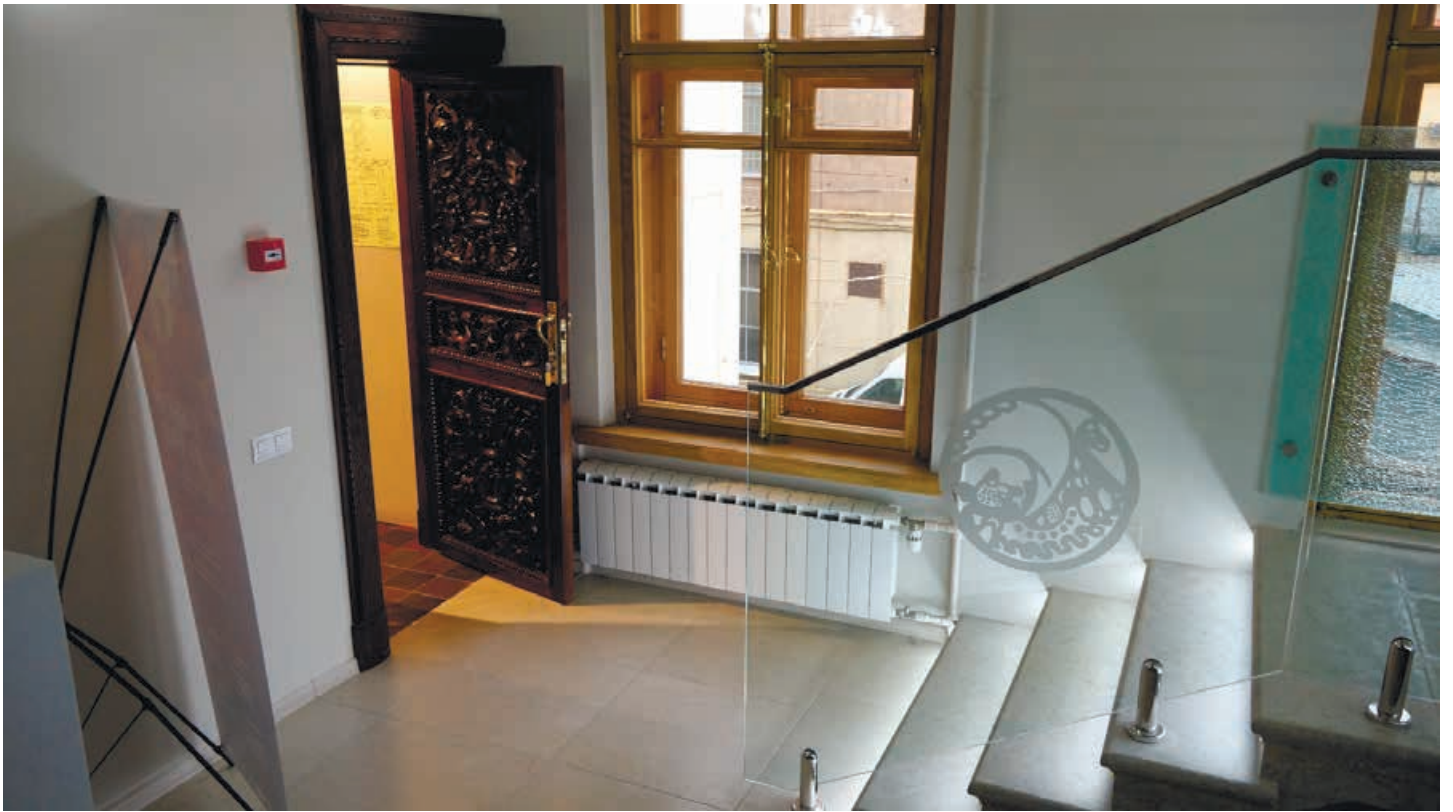
Фото 47. Секционный радиатор в помещении 209. Общий вид. Дата фотофиксации: 15.05.2024
