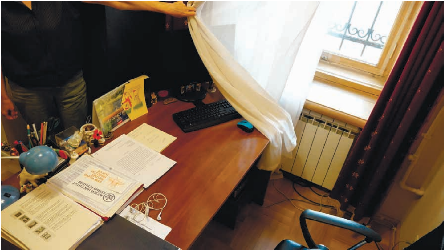
Фото 43. Секционный радиатор в помещении 113. Фрагмент. Дата фотофиксации: 15.05.2024
