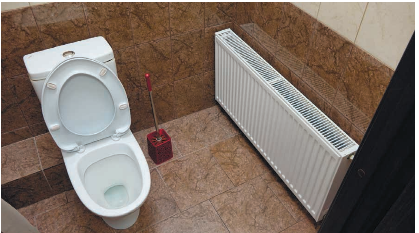
Фото 30. Радиатор и туалет в помещении 105. Общий вид. Дата фотофиксации: 15.05.2024
