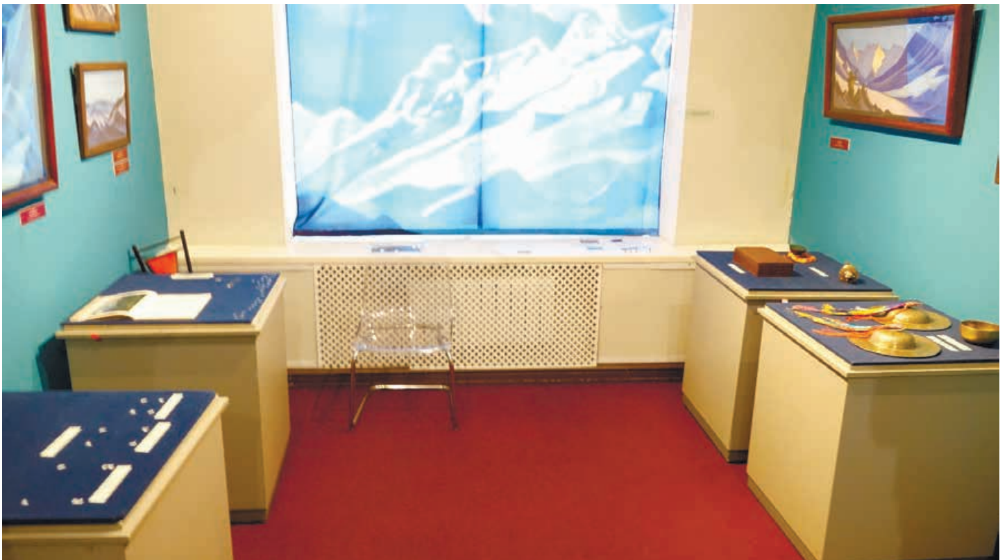
Фото 72. Секционный радиатор за декоративной решёткой в помещении 310. Общий вид. Дата фотофиксации: 15.05.2024
