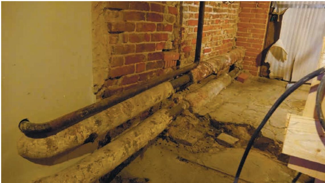
Фото 9. Стальной трубопровод в помещении 17, не окрашен. Теплоизоляция магистрали отсутствует. Дата фотофиксации: 15.05.2024
