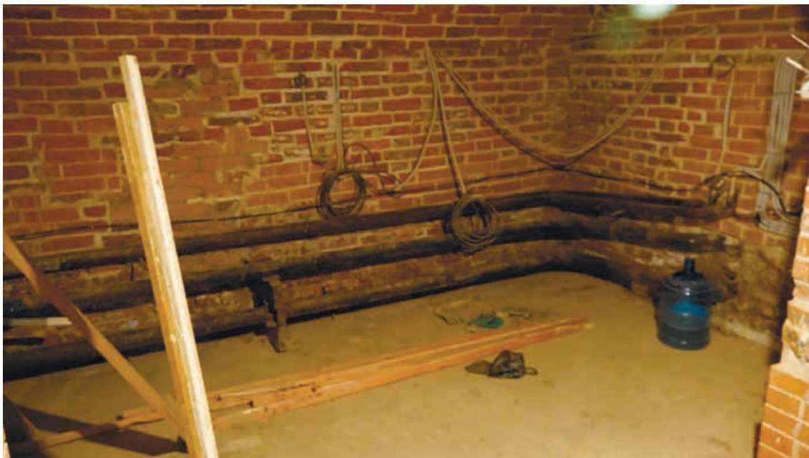
Фото 10. Стальной трубопровод в помещении 18, не окрашен. Теплоизоляция магистрали отсутствует. Дата фотофиксации: 15.05.2024
