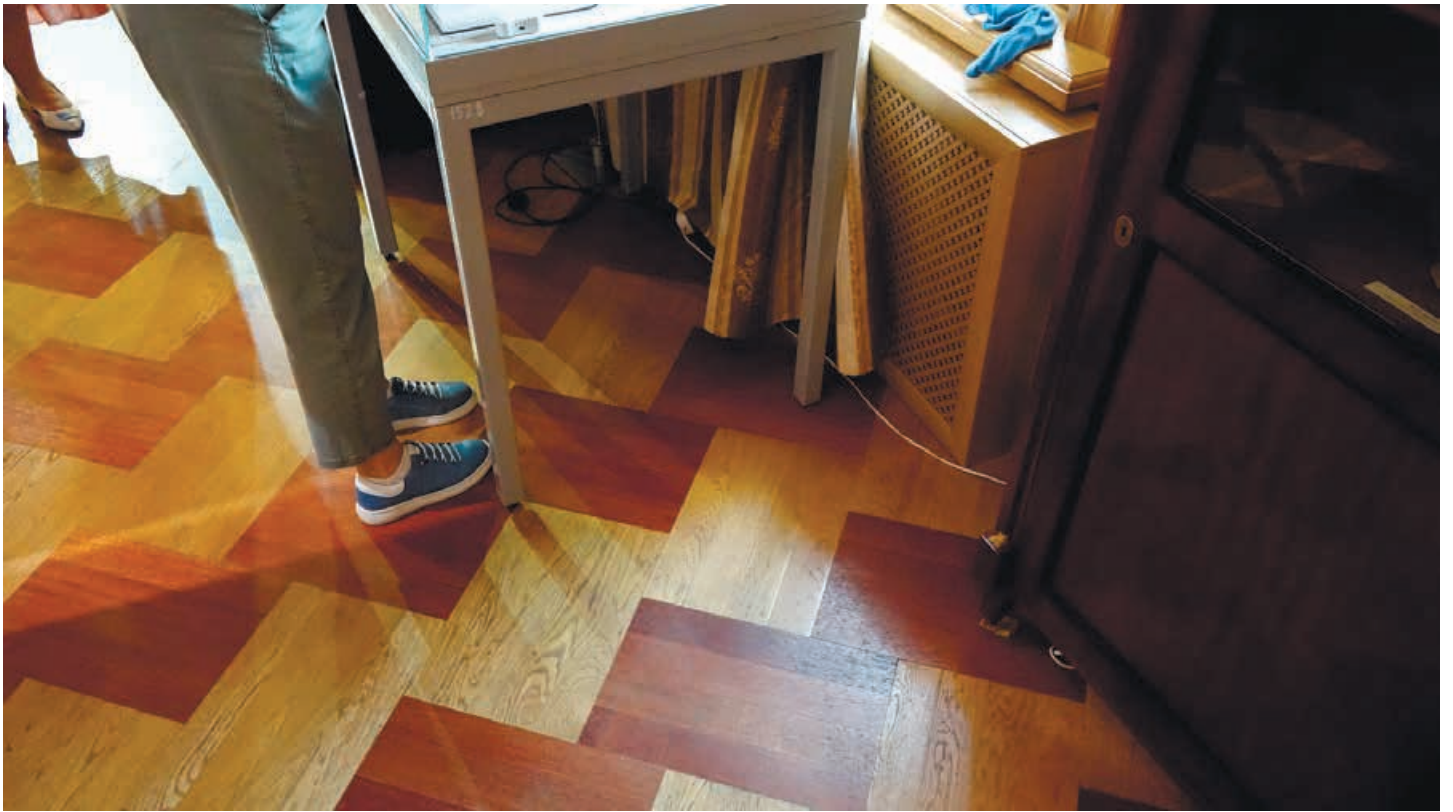
Фото 53. Радиатор за декоративной решёткой в помещении 215. Дата фотофиксации: 15.05.2024
