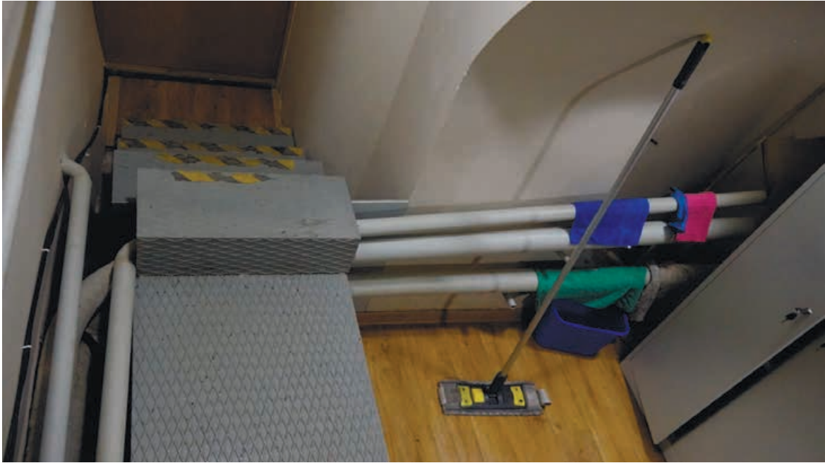
Фото 7. Окрашенный трубопровод в помещении 16. Теплоизоляция магистрали отсутствует. Дата фотофиксации: 15.05.2024
