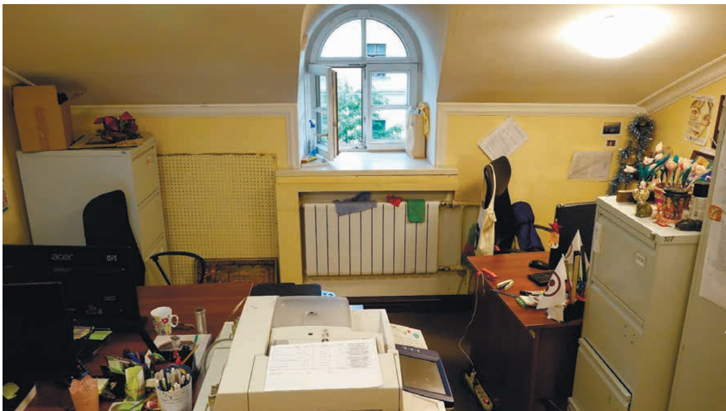
Фото 65. Секционный радиатор в помещении 301. Общий вид. Дата фотофиксации: 15.05.2024
