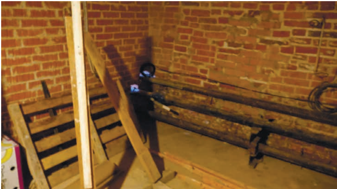
Фото 11. Стальной трубопровод, уходящий за границы помещения 18. Теплоизоляция магистрали отсутствует. Дата фотофиксации: 15.05.2024
