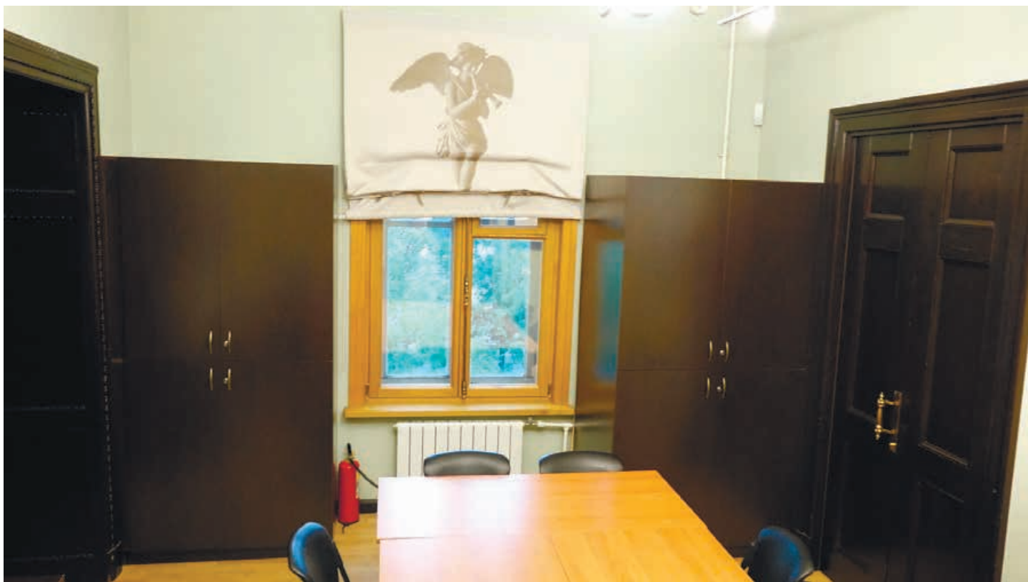
Фото 62. Секционный радиатор в помещении 203. Общий вид. Дата фотофиксации: 15.05.2024
