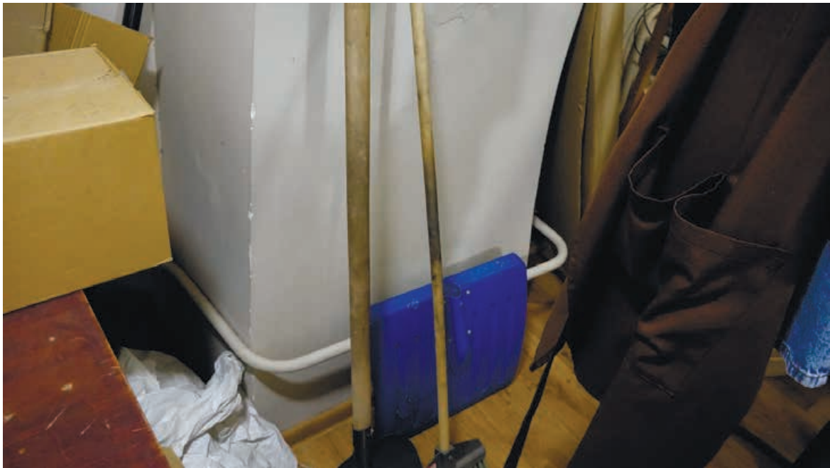
Фото 8. Окрашенный трубопровод в помещении 16. Теплоизоляция магистрали отсутствует. Фрагмент. Дата фотофиксации: 15.05.2024
