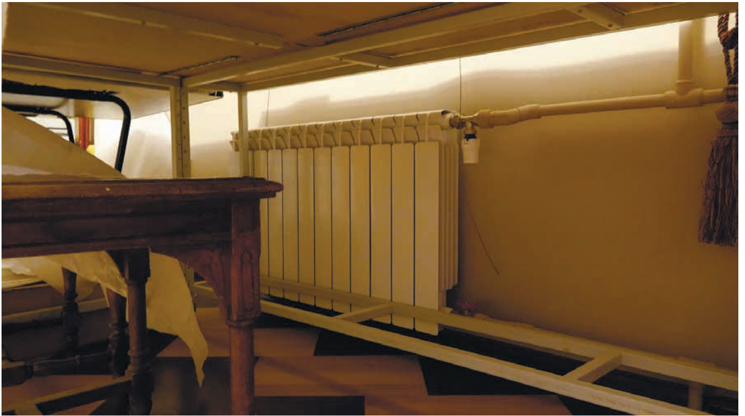
Фото 49. Секционный радиатор в помещении 211. Общий вид. Дата фотофиксации: 15.05.2024
