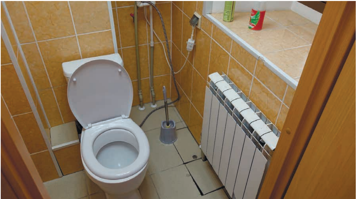
Фото 20. Туалет в помещении 15 и секционный радиатор. Общий вид. Дата фотофиксации: 15.05.2024
