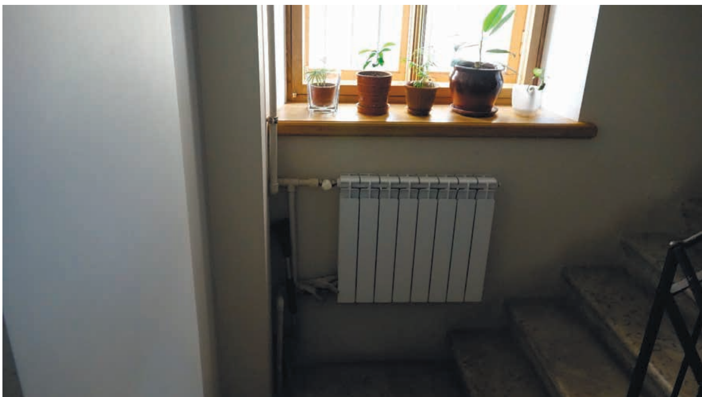
Фото 24. Секционный радиатор в помещении 104. Общий вид. Дата фотофиксации: 15.05.2024
