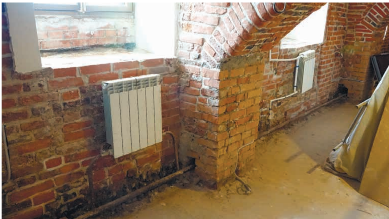
Фото 13. Секционные радиаторы в помещении 5. Общий вид. Дата фотофиксации: 15.05.2024
