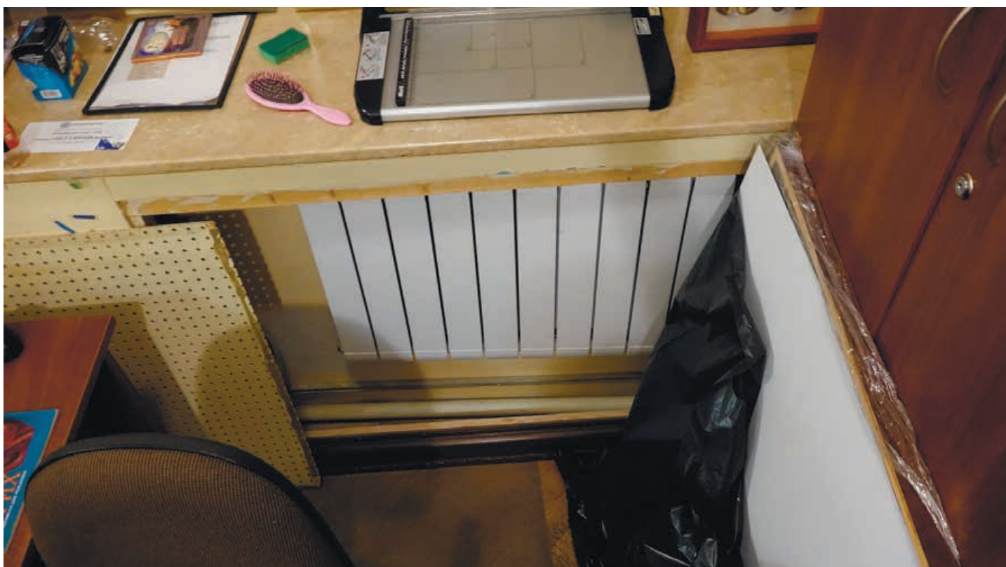
Фото 66. Секционный радиатор в помещении 301. Фрагмент. Дата фотофиксации: 15.05.2024
