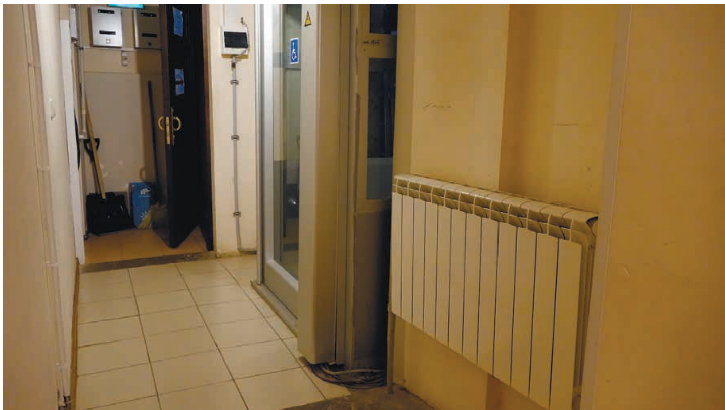
Фото 23. Секционный радиатор в помещении 13. Общий вид. Дата фотофиксации: 15.05.2024
