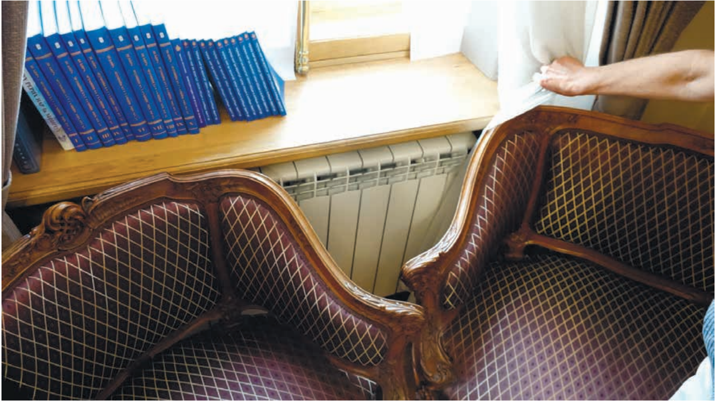
Фото 37. Секционный радиатор в помещении 117. Фрагмент. Дата фотофиксации: 15.05.2024
