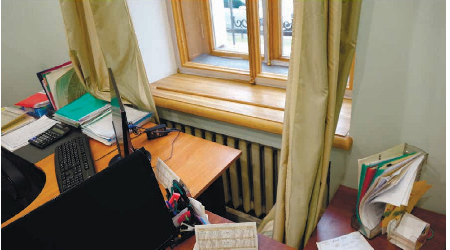
Фото 27. Чугунный радиатор в помещении 101. Фрагмент. Дата фотофиксации: 15.05.2024
