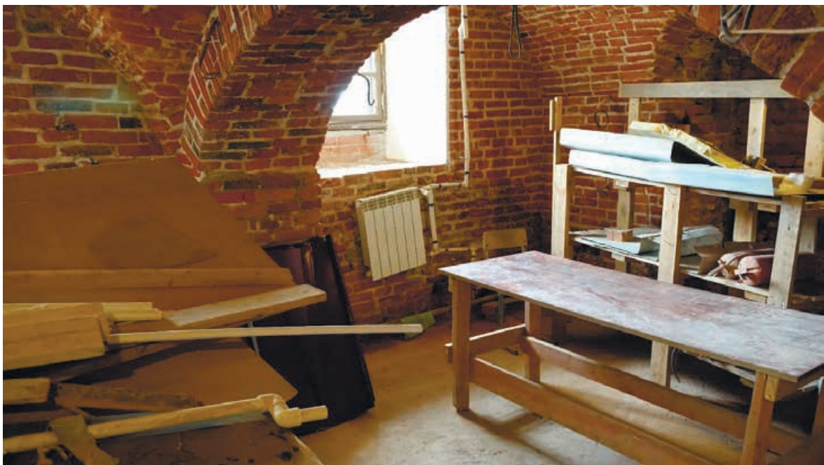
Фото 12. Секционный радиатор в помещении 6. Дата фотофиксации: 15.05.2024
