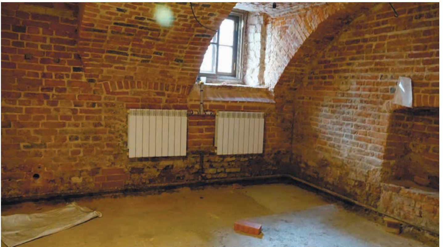
Фото 16. Секционные радиаторы в помещении 3. Общий вид. Дата фотофиксации: 15.05.2024
