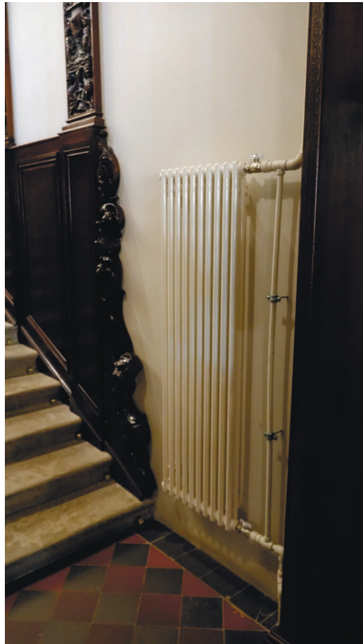
Фото 32. Чугунный радиатор в межлесничном пространстве помещения 108. Общий вид. Дата фотофиксации: 15.05.2024
