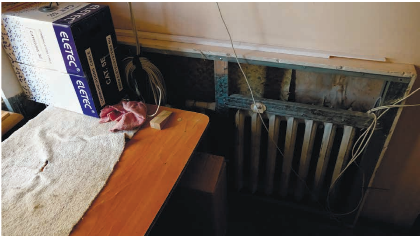
Фото 25. Чугунный радиатор типа MC-140. Общий вид. Дата фотофиксации: 15.05.2024
