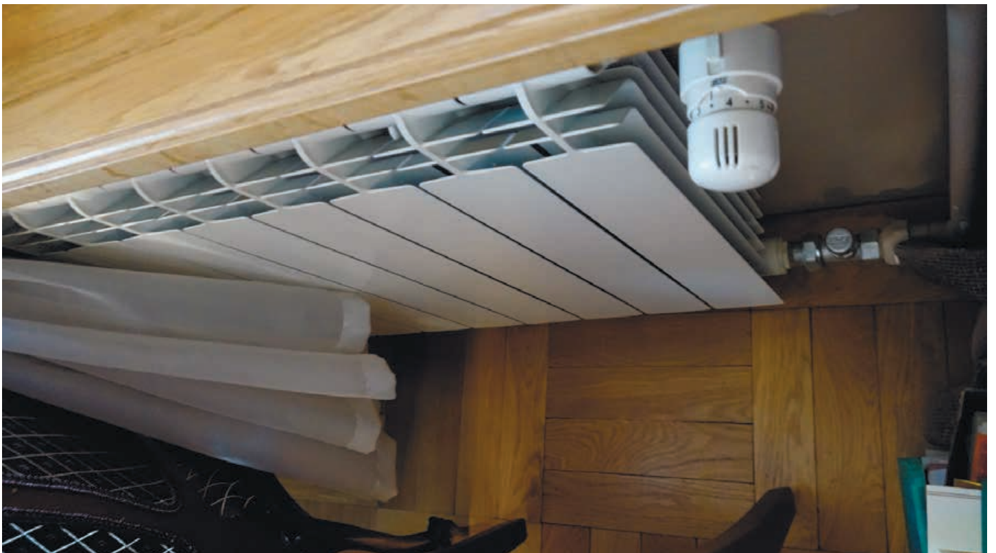
Фото 36. Секционный радиатор в помещении 117. Общий вид. Дата фотофиксации: 15.05.2024
