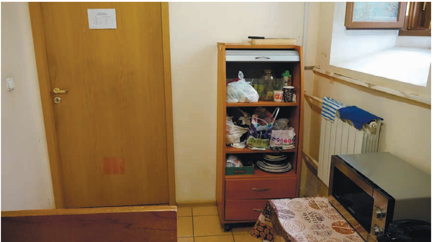
Фото 18. Секционный радиатор в помещении 14. Общий вид. Дата фотофиксации: 15.05.2024
