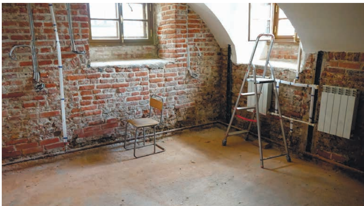
Фото 14. Секционные радиаторы в помещении 1. Общий вид. Дата фотофиксации: 15.05.2024
