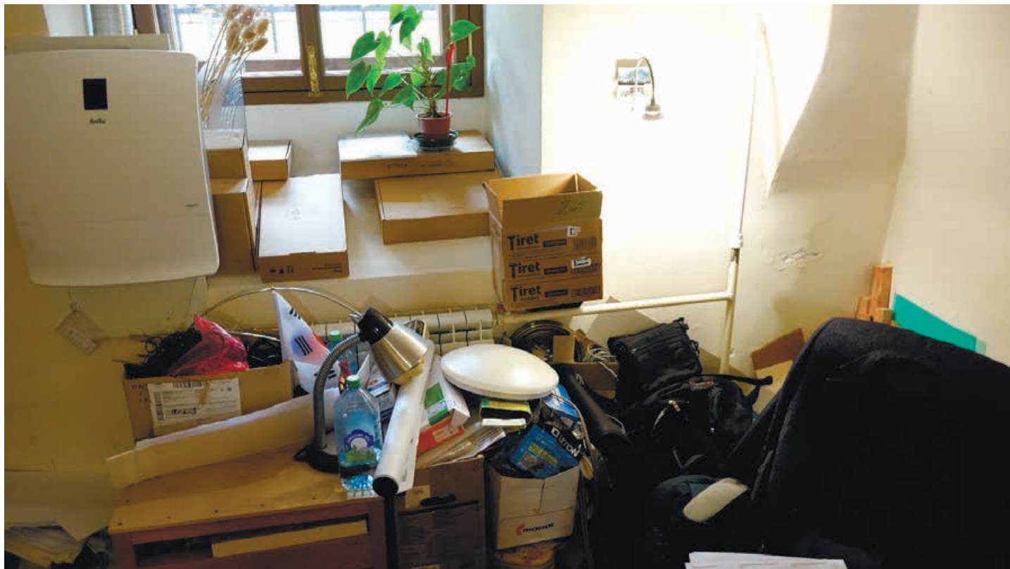
Фото 21. Секционный радиатор в помещении 10. Общий вид. Дата фотофиксации: 15.05.2024
