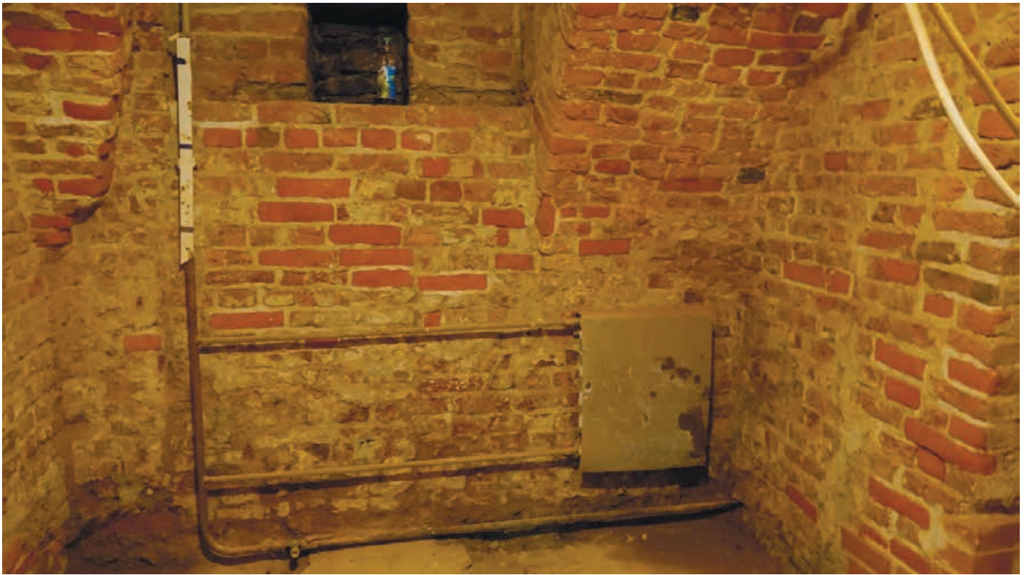
Фото 17. Радиатор в помещении 4. Стальной трубопровод, не окрашен. Теплоизоляция магистрали отсутствует. Дата фотофиксации: 15.05.2024
