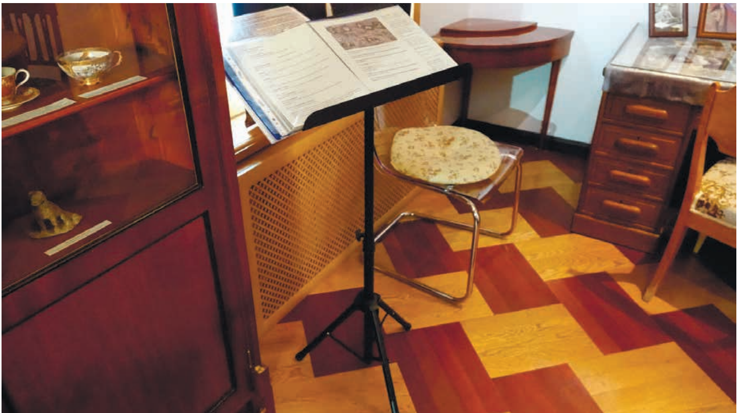
Фото 54. Радиатор за декоративной решёткой в помещении 215. Дата фотофиксации: 15.05.2024
