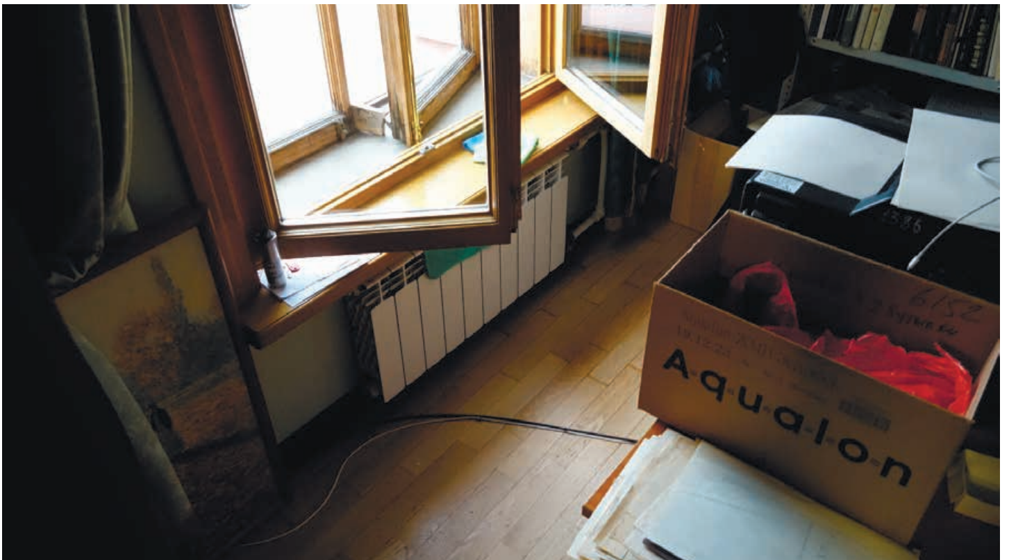
Фото 60. Секционный радиатор в помещении 201. Общий вид. Дата фотофиксации: 15.05.2024
