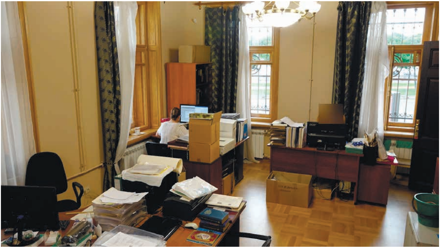
Фото 41. Секционные радиаторы в помещении 112. Общий вид. Дата фотофиксации: 15.05.2024
