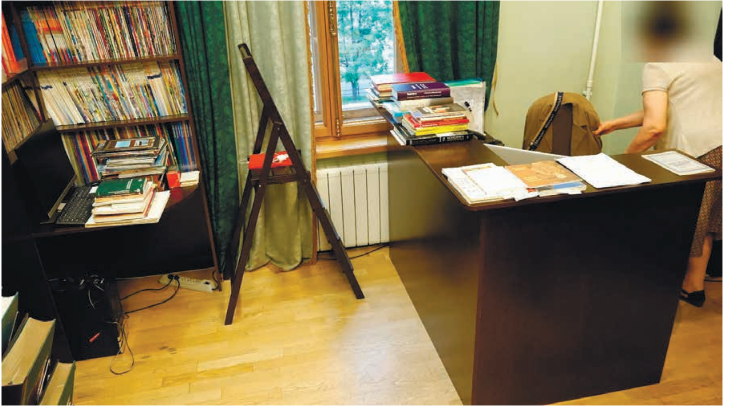
Фото 59. Секционный радиатор в помещении 202. Фрагмент. Дата фотофиксации: 15.05.2024
