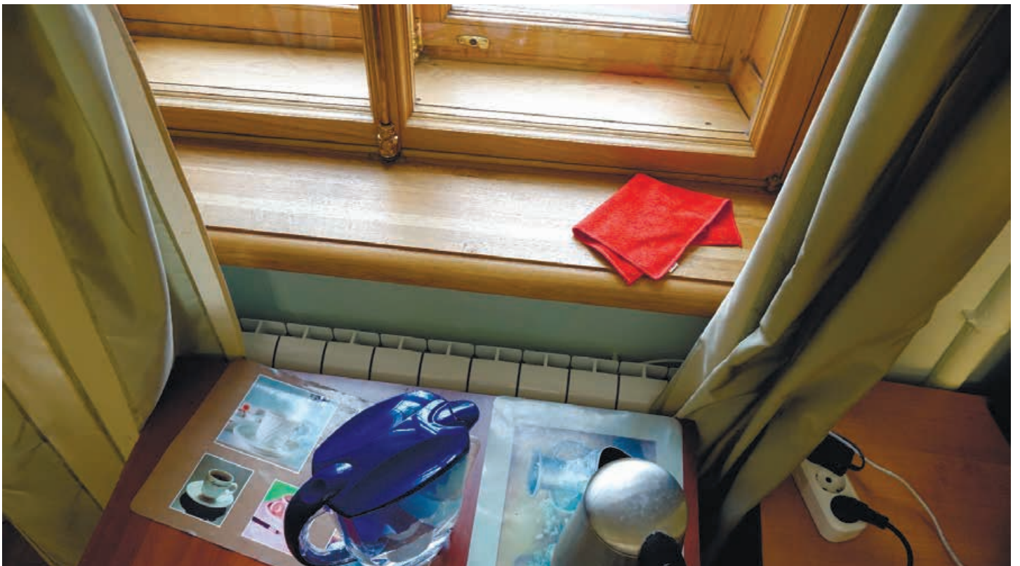
Фото 28. Секционный радиатор в помещении 103. Фрагмент. Дата фотофиксации: 15.05.2024
