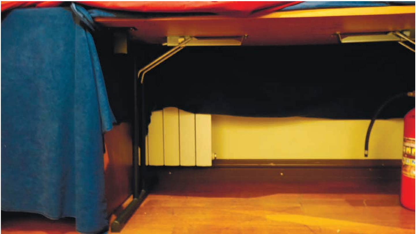
Фото 76. Секционный радиатор за бытовыми предметами в помещении 315. Фрагмент. Дата фотофиксации: 15.05.2024
