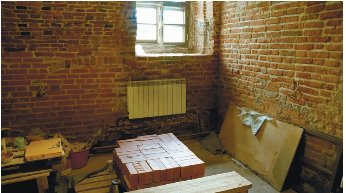
Фото 15. Секционный радиатор в помещении 2. Общий вид. Дата фотофиксации: 15.05.2024
