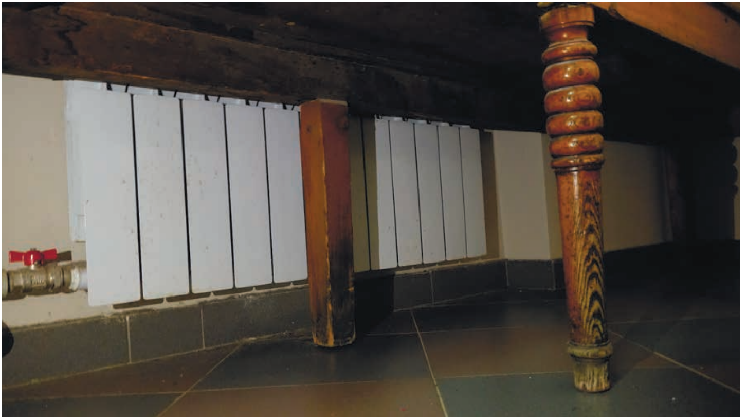
Фото 39. Секционный радиатор в помещении 110. Общий вид. Дата фотофиксации: 15.05.2024
