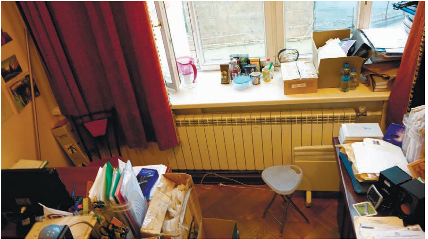
Фото 71. Секционный радиатор в помещении 311. Общий вид. Дата фотофиксации: 15.05.2024
