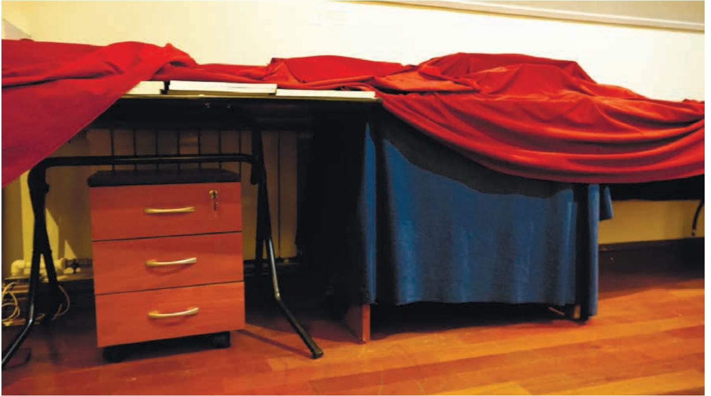
Фото 75. Секционный радиатор за бытовыми предметами в помещении 315. Фрагмент. Дата фотофиксации: 15.05.2024
