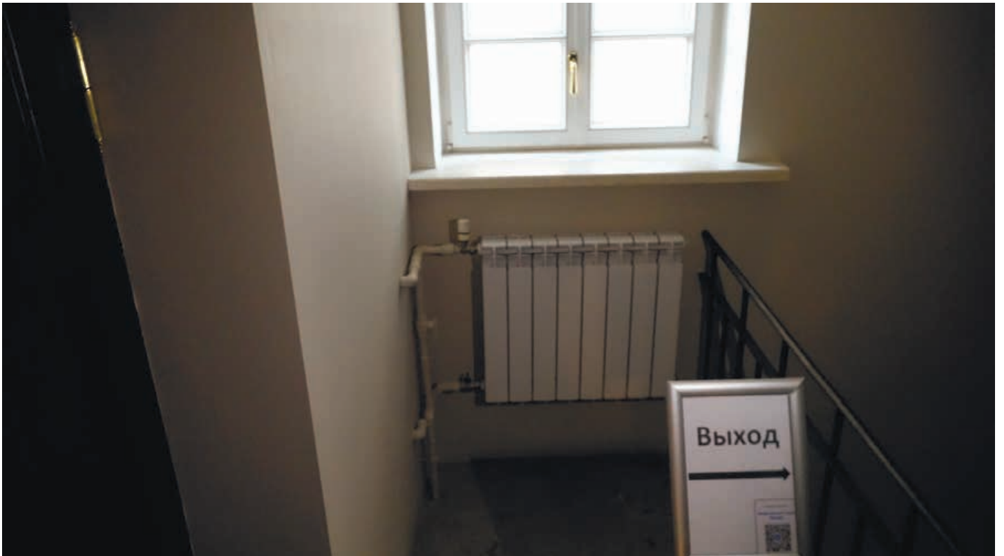
Фото 64. Секционный радиатор в помещении 304. Общий вид. Дата фотофиксации: 15.05.2024
