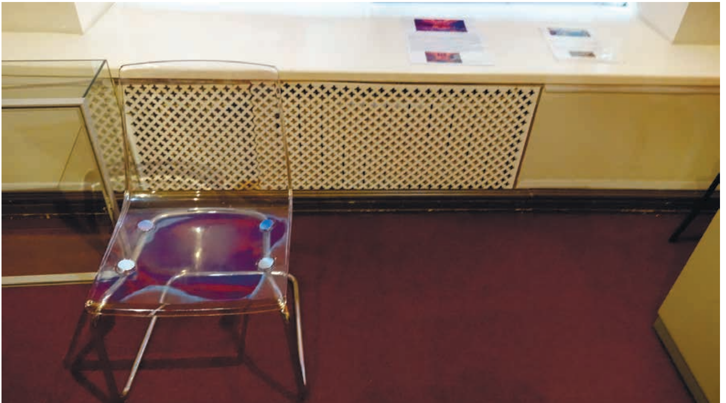
Фото 74. Секционный радиатор за декоративной решёткой в помещении 309. Общий вид. Дата фотофиксации: 15.05.2024
