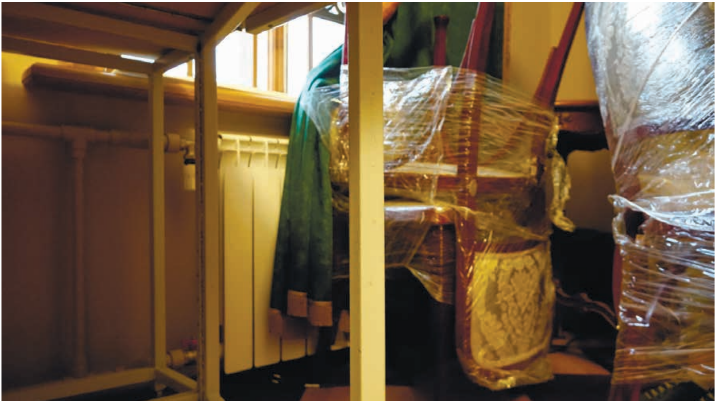
Фото 50. Секционный радиатор в помещении 211. Фрагмент. Дата фотофиксации: 15.05.2024
