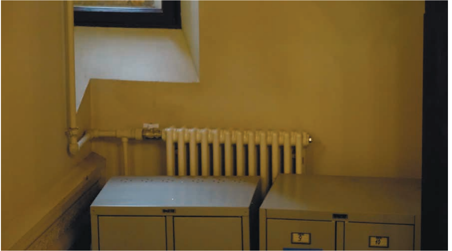
Фото 31. Чугунный радиатор в помещении 108. Фрагмент. Дата фотофиксации: 15.05.2024
