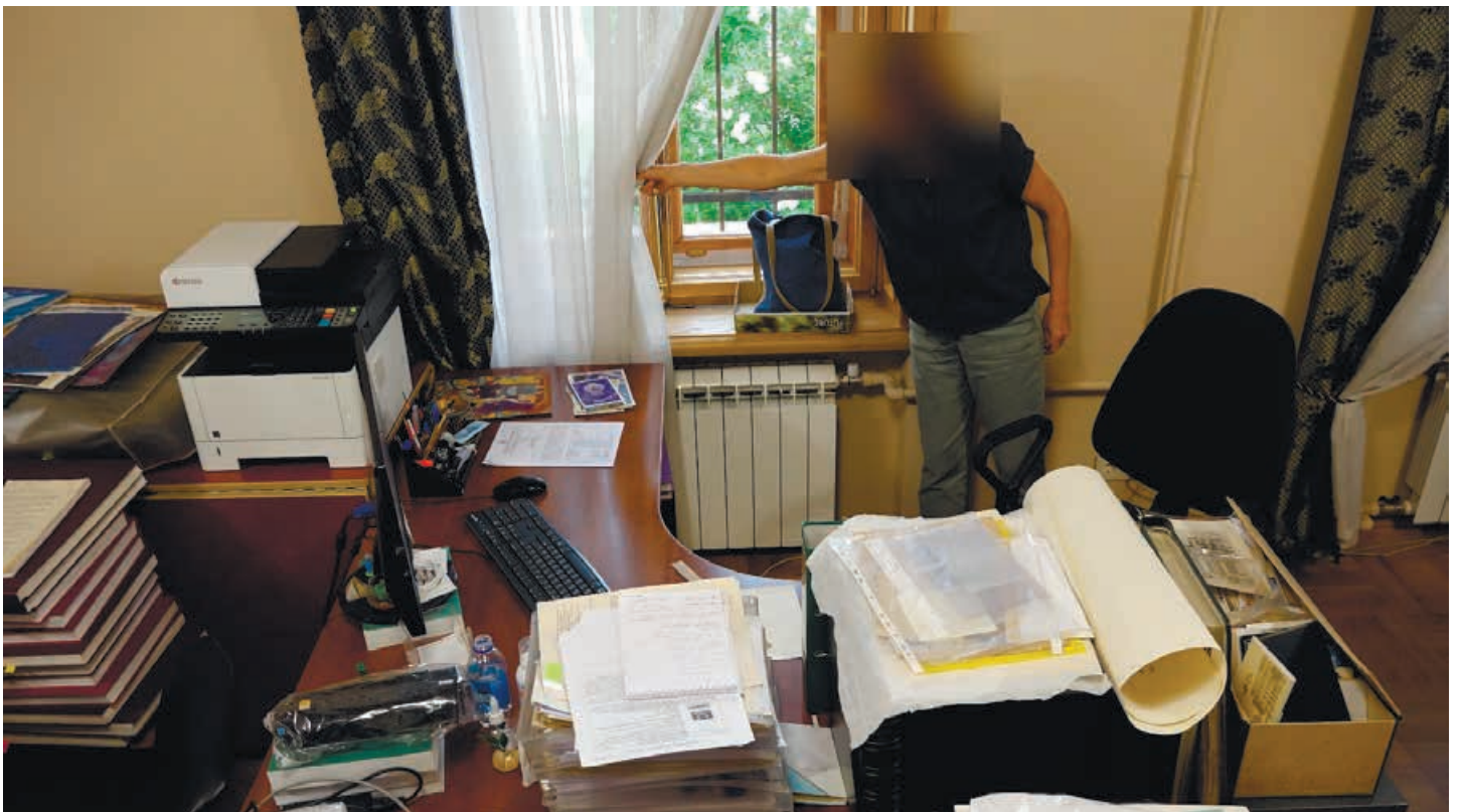
Фото 42. Секционный радиатор в помещении 112. Фрагмент. Трубопровод окрашен. Дата фотофиксации: 15.05.2024
