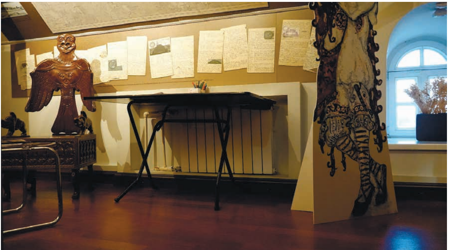
Фото 78. Секционный радиатор в помещении 316. Общий вид. Дата фотофиксации: 15.05.2024
