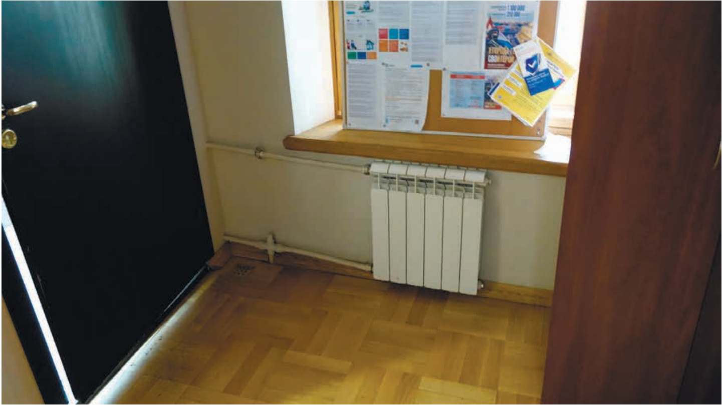
Фото 29. Секционный радиатор в помещении 107. Общий вид. Дата фотофиксации: 15.05.2024
