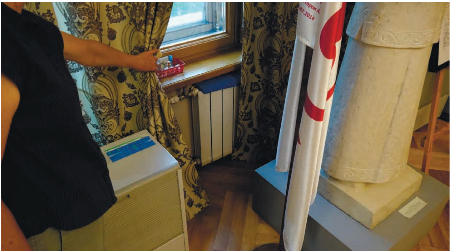
Фото 56. Секционный радиатор в помещении 207. Фрагмент. Дата фотофиксации: 15.05.2024
