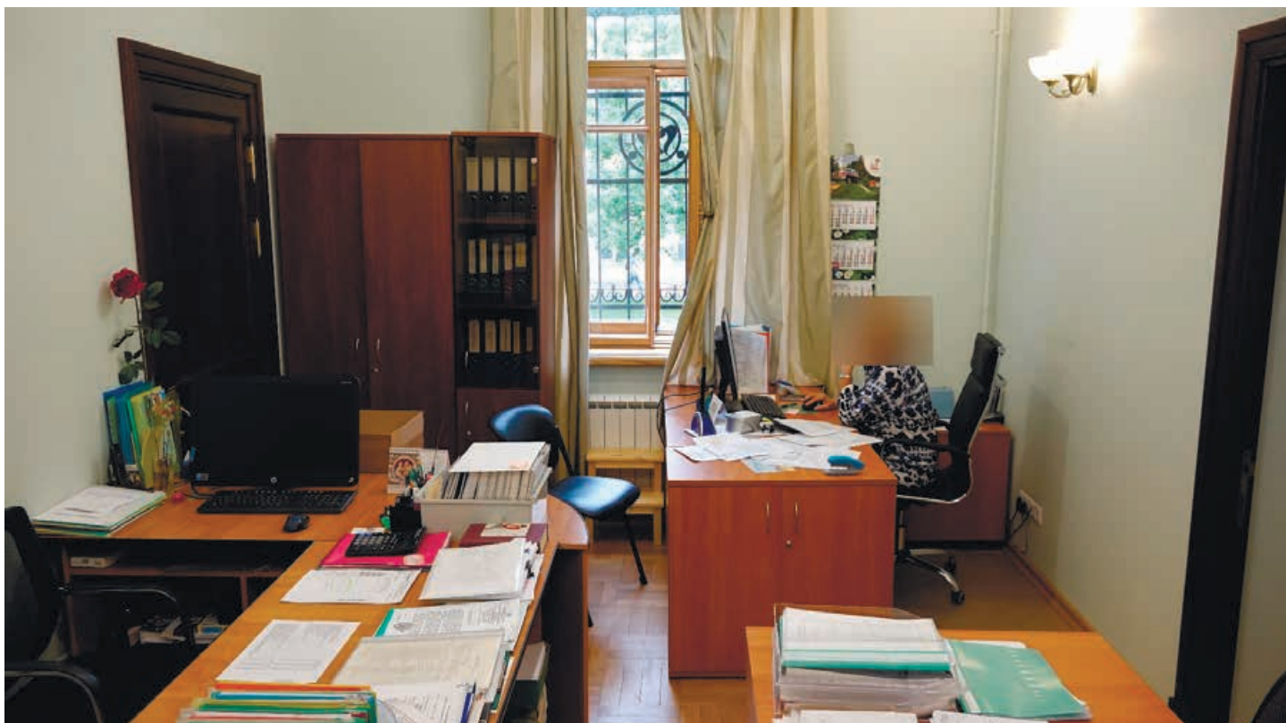
Фото 26. Секционный радиатор в помещении 102. Общий вид. Дата фотофиксации: 15.05.2024
