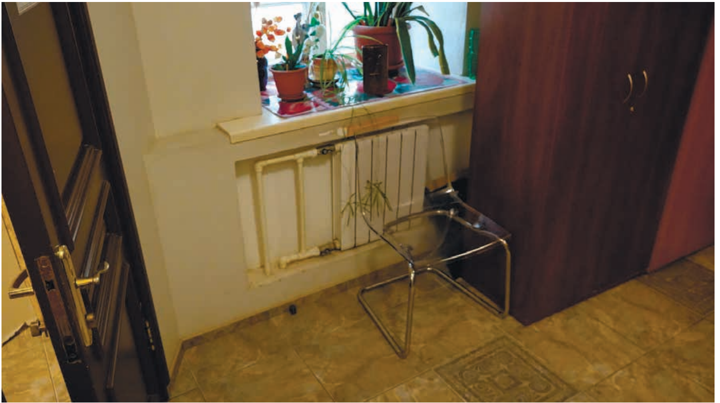
Фото 69. Секционный радиатор в помещении 306. Общий вид. Дата фотофиксации: 15.05.2024
