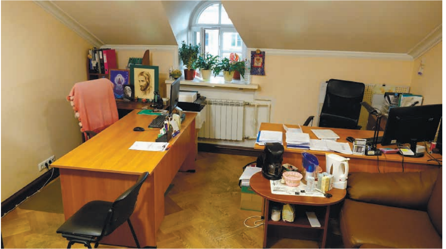
Фото 81. Секционный радиатор в помещении 303. Общий вид. Дата фотофиксации: 15.05.2024
