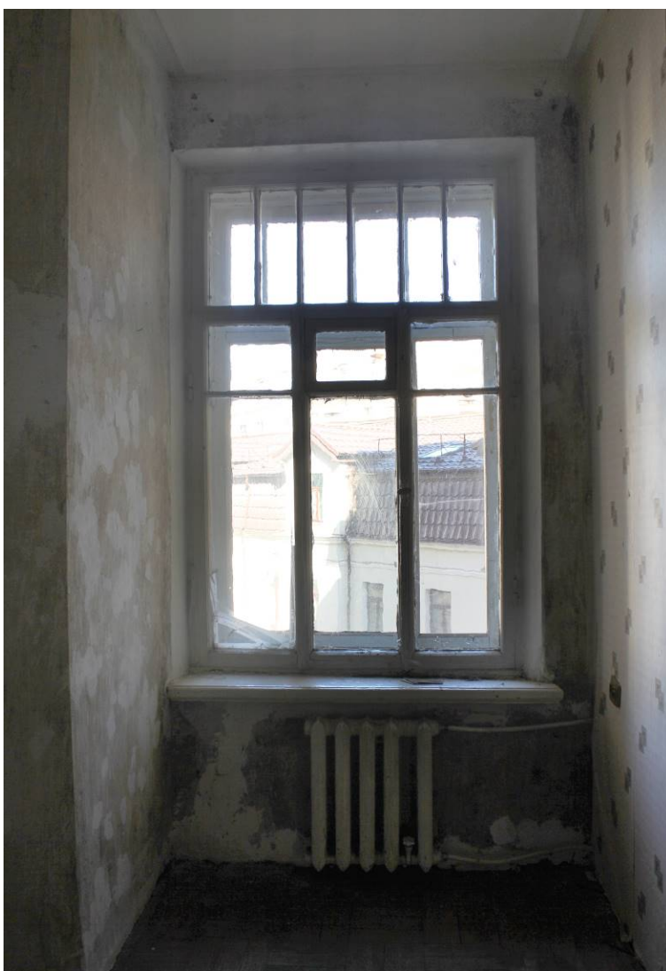
29. Выявленный объект культурного наследия «Дом И.И. Боргмана», по адресу: г. Санкт-Петербург, Съезжинская улица, дом 4, литера А. Квартира №4. Помещение 4. Фрагмент с показом оформления оконного проема, а также оконного заполнения. Дата фотофиксации: 28 августа 2021г.
