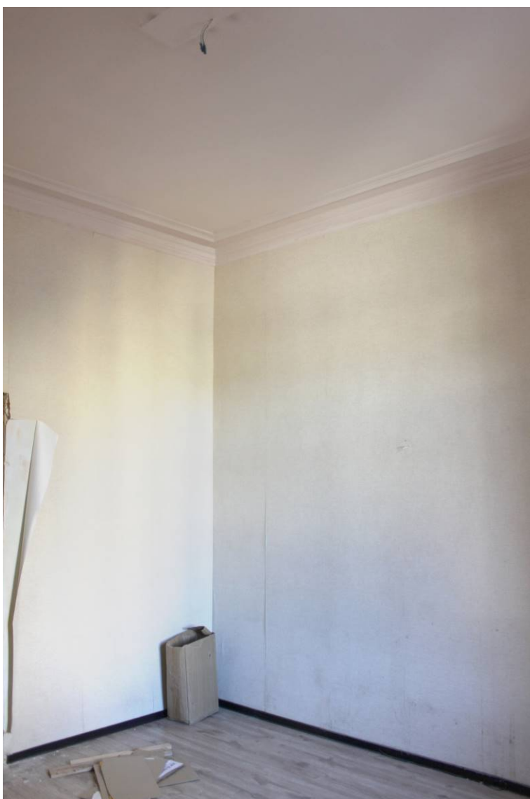
19. Выявленный объект культурного наследия «Дом И.И. Боргмана», по адресу: г. Санкт-Петербург, Съезжинская улица, дом 4, литера А. Квартира №4. Помещение 5. Общий вид помещения. Дата фотофиксации: 28 августа 2021 г.
