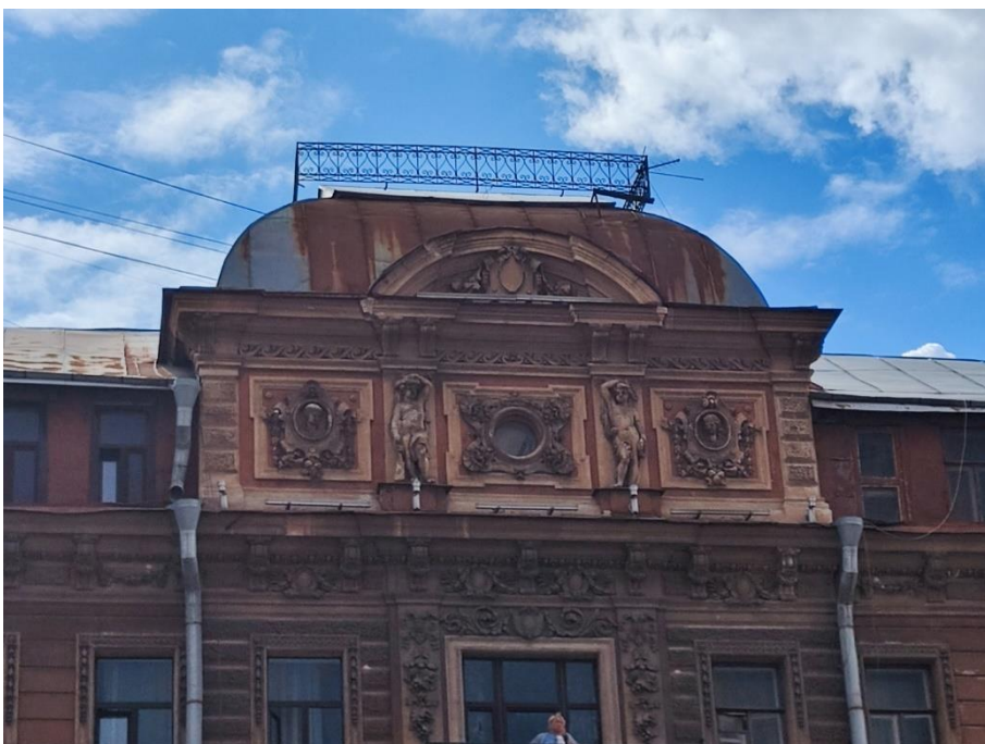
5. «Дом И.Ф. Александровского (Санкт-Петербургского Тульского поземельного банка)», Невский пр., д.63, литера А. Северный фасад. Фрагмент. Фото 19.07.2024г.
