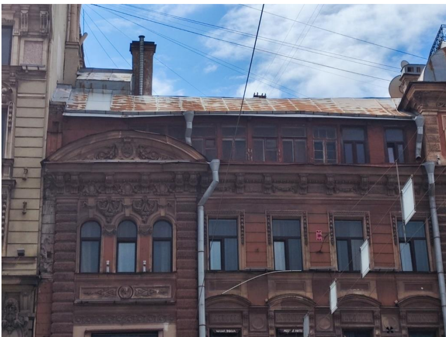
3. «Дом И.Ф. Александровского (Санкт-Петербургского Тульского поземельного банка)», Невский пр., д.63, литера А. Северный фасад. Фрагмент. Фото 19.07.2024г.
