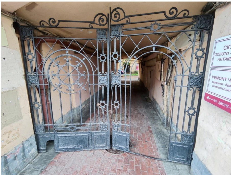
22. «Дом И.Ф. Александровского (Санкт-Петербургского Тульского поземельного банка)», Невский пр., д.63, литера А. Проход во двор. Фрагмент. Фото 19.07.2024г.
