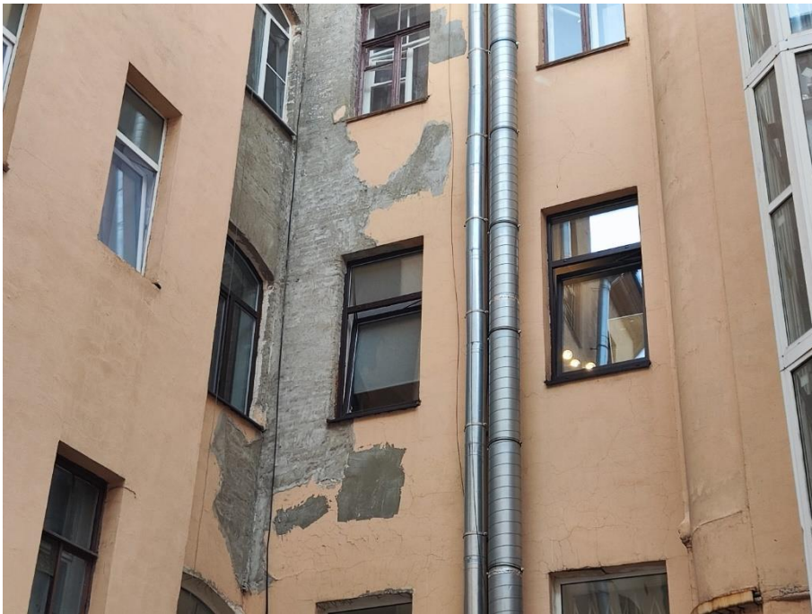
33. «Дом И.Ф. Александровского (Санкт-Петербургского Тульского поземельного банка)», Невский пр., д.63, литера А. Дворовый фасад. Фрагмент. Фото 19.07.2024г.
