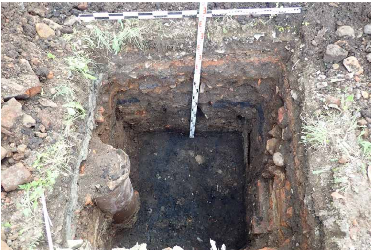
Рис. 27 Земельный участок с кадастровым номером 78:13:0007310:2145 по адресу г. Санкт-Петербург, Курская улица, дом 27. Шурф № 1. Пласт 2. Вид с севера.
