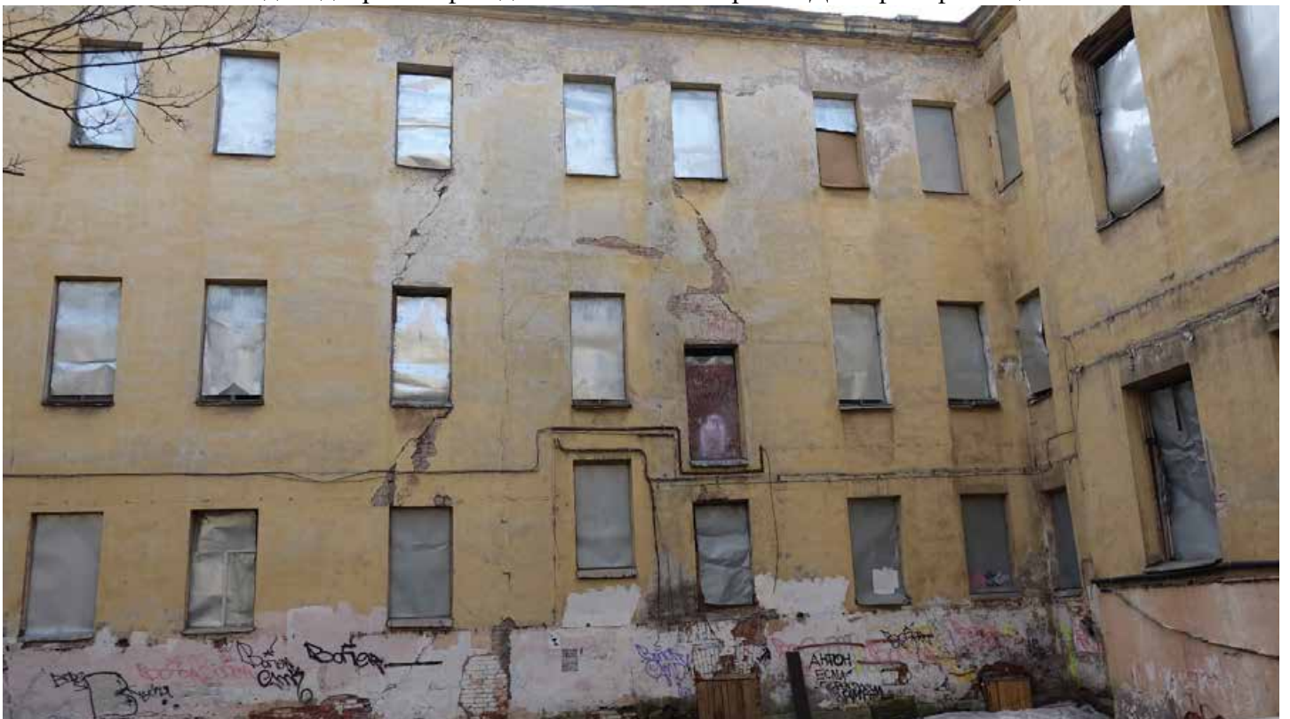
Фото 22. Дворовый фасад центрального объема. Фрагмент с заложеными оконными проемами и приямком по 3й световой оси. Дата фотофиксации: 01.03.24
