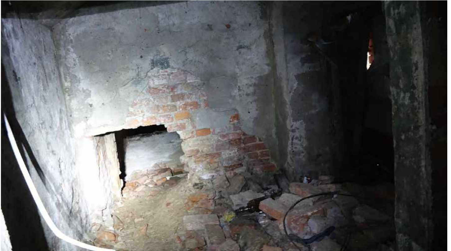
Фото 45. Помещение 7. Фрагмент стены с проломом. Цокольный этаж. Дата фотофиксации: 01.03.24
