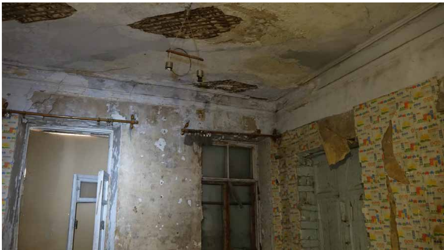
Фото 225. Помещение 130. Карниз и падуга советского периода. Третий этаж. Дата фотофиксации: 01.03.24
