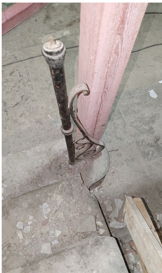
Фото 8. Лестница Л1. Фрагмент сохранившейся детали ограждения. Дата фотофиксации: 01.03.24
