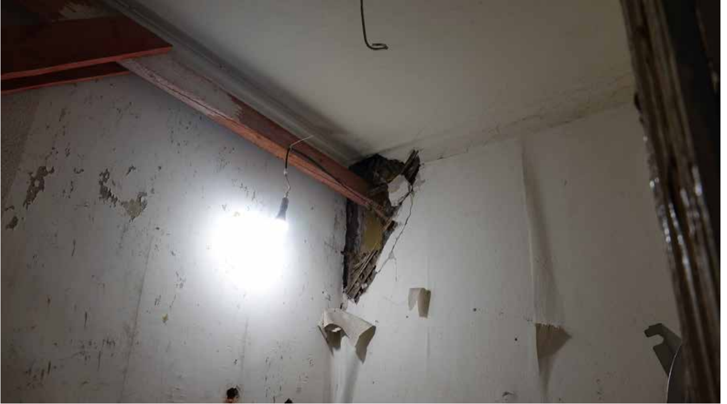
Фото 128. Помещение 46. Потолок, следы деструкции. Первый этаж. Дата фотофиксации: 01.03.24
