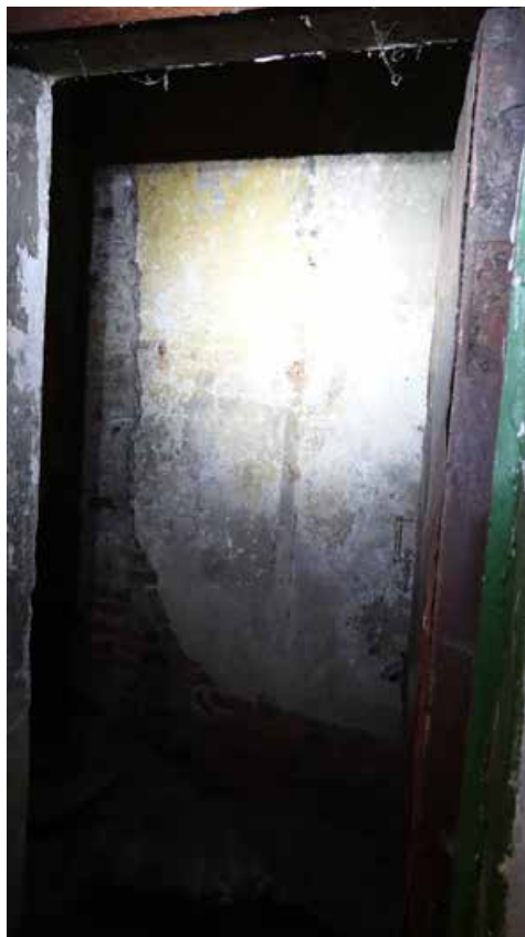
Фото 61. Вход в помещение 26 со стороны межэтажной площадки лестницы Л4. Первый этаж. Дата фотофиксации: 01.03.24
