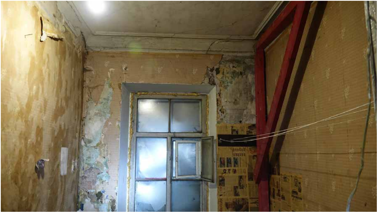
Фото 98. Помещение 8. Падуга и профилированный карниз советского времени. Следы деструкции. Первый этаж. Дата фотофиксации: 01.03.24
