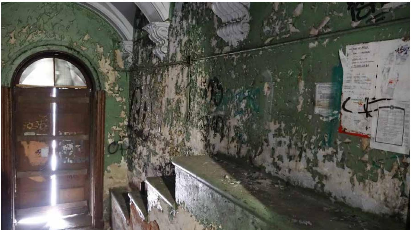
Фото 109. Помещение 1, парадный вестибюль. Кирпичные устои лестницы парадного вестибюля. Первый этаж. Дата фотофиксации: 01.03.24
