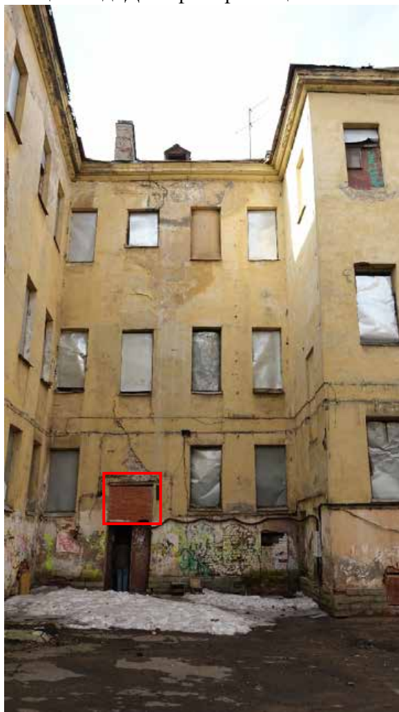
Фото 28. Заложённая фрамуга на дверь к лестнице Л4. Вид со стороны двора.
