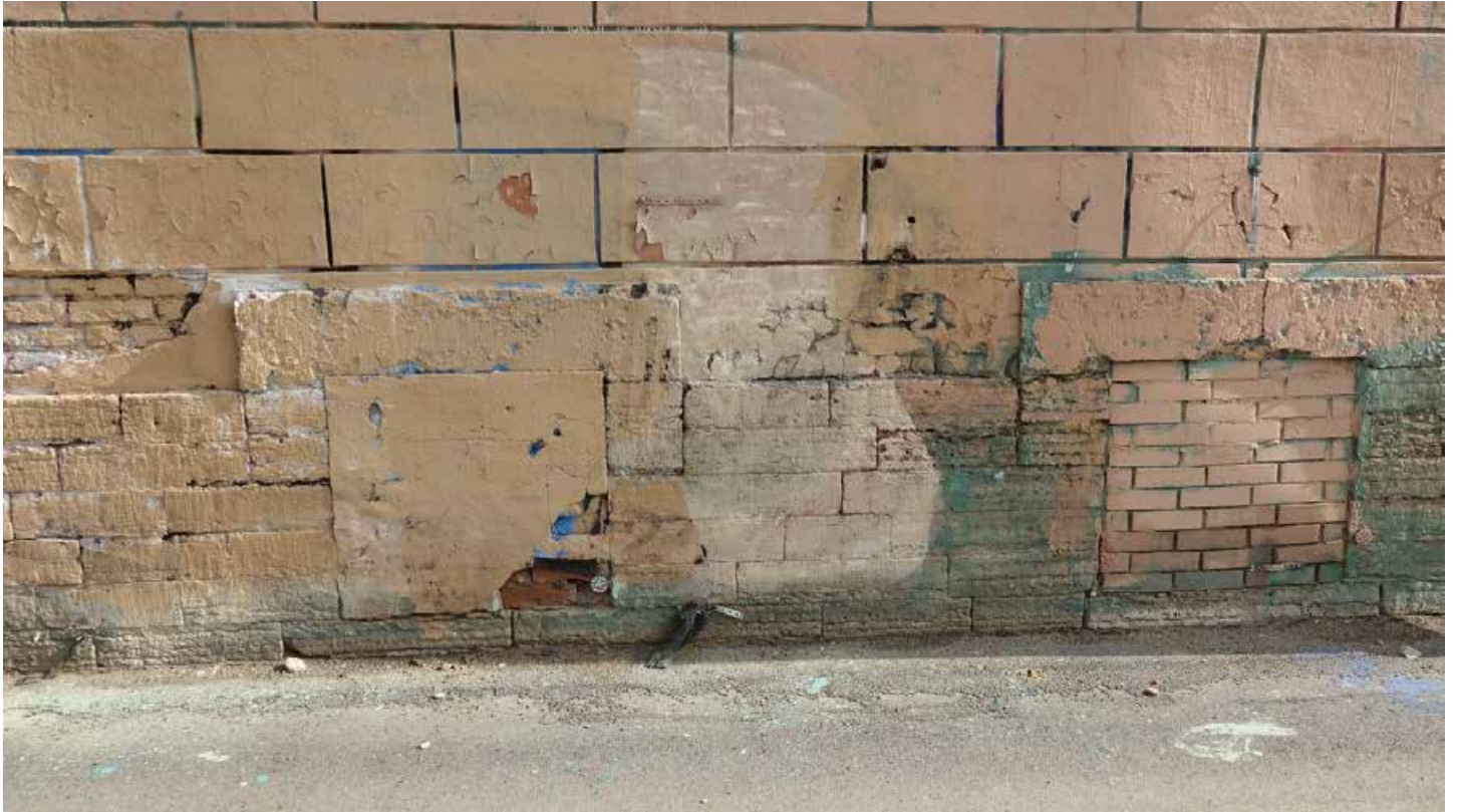
Фото 17. Замурованные оконные проёмы цокольного этажа западного фасада. Фрагмент. Дата фотофиксации: 01.03.24
