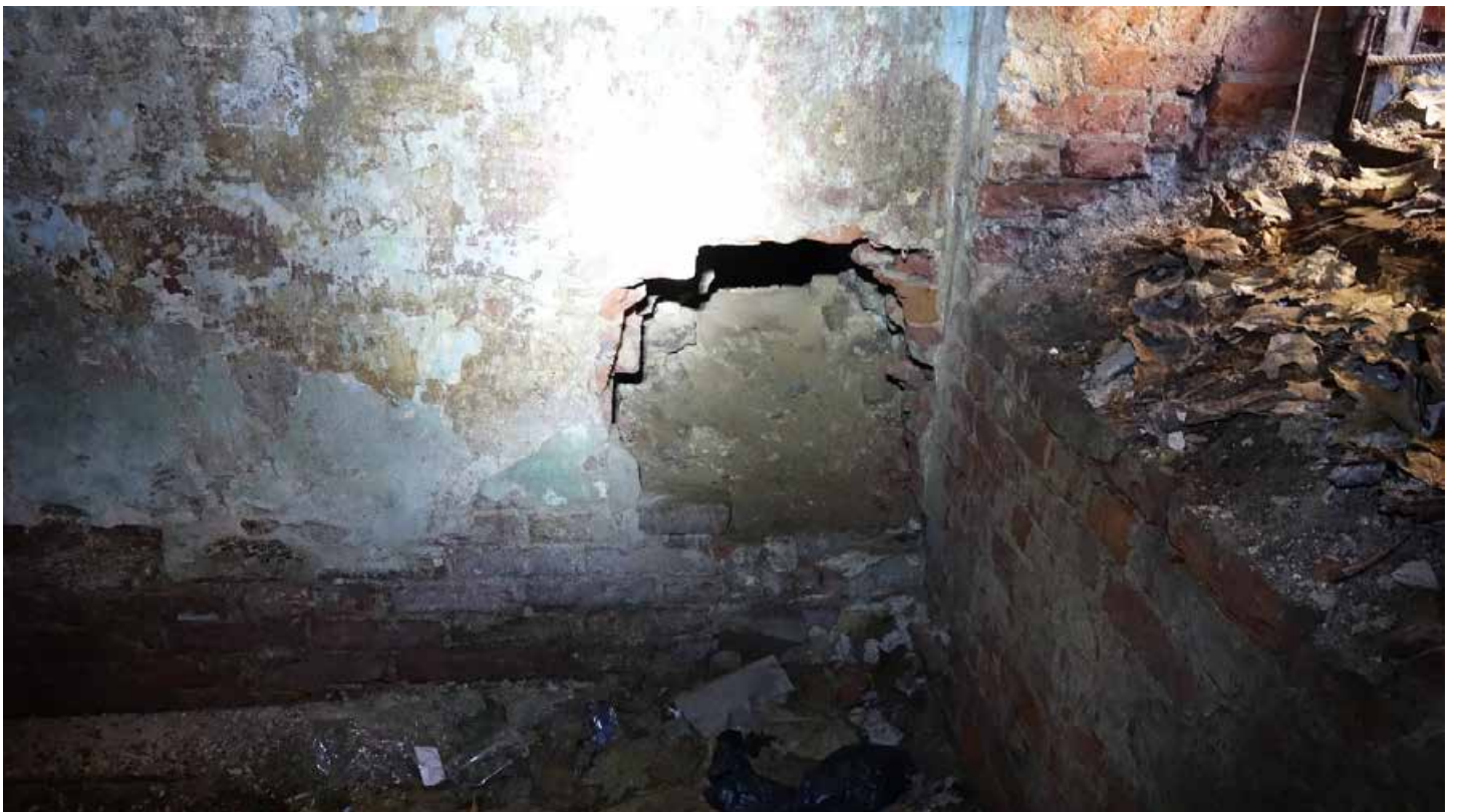
Фото 12. Помещение 154. Вид на пролом стене. Цокольный этаж. Дата фотофиксации: 01.03.24
