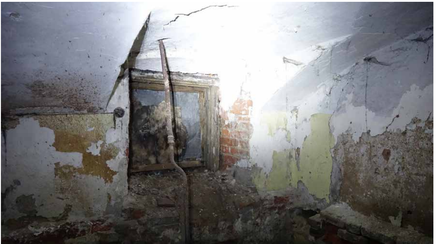
Фото 28. Помещение 146. Остатки трубопровода и оконные проем. Цокольный этаж. Дата фотофиксации: 01.03.24
