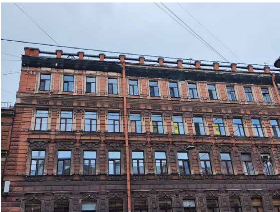
5. «Здание, где размещался ресторан «К.П. Палкин», Владимирский пр., д. 1/47, литера Б. Восточный фасад. Фрагмент. Фото 31.07.2024г.
