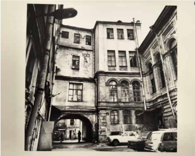
63. Приложение к описи архитектурного убранства памятника истории – дома № 47 по Невскому проспекту, №1 по Владимирскому проспекту, №4 по улице Рубинштейна. Фотограф Леонтьев С.Е. Северный фасад дворового флигеля, перпендикулярного лицевому корпусу по Владимирскому проспекту. 1995 г. Из архива ресторана «Палкинъ».
