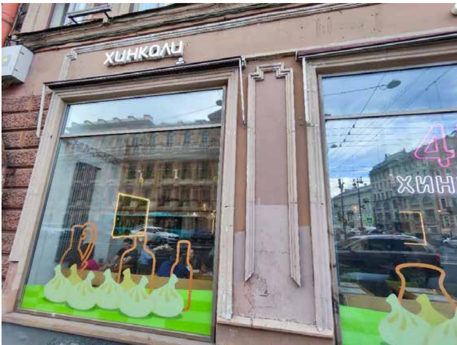
20. «Здание, где размещался ресторан «К.П. Палкин», Владимирский пр., д. 1/47, литера Б. Восточный фасад. Фрагмент. Фото 31.07.2024г.
