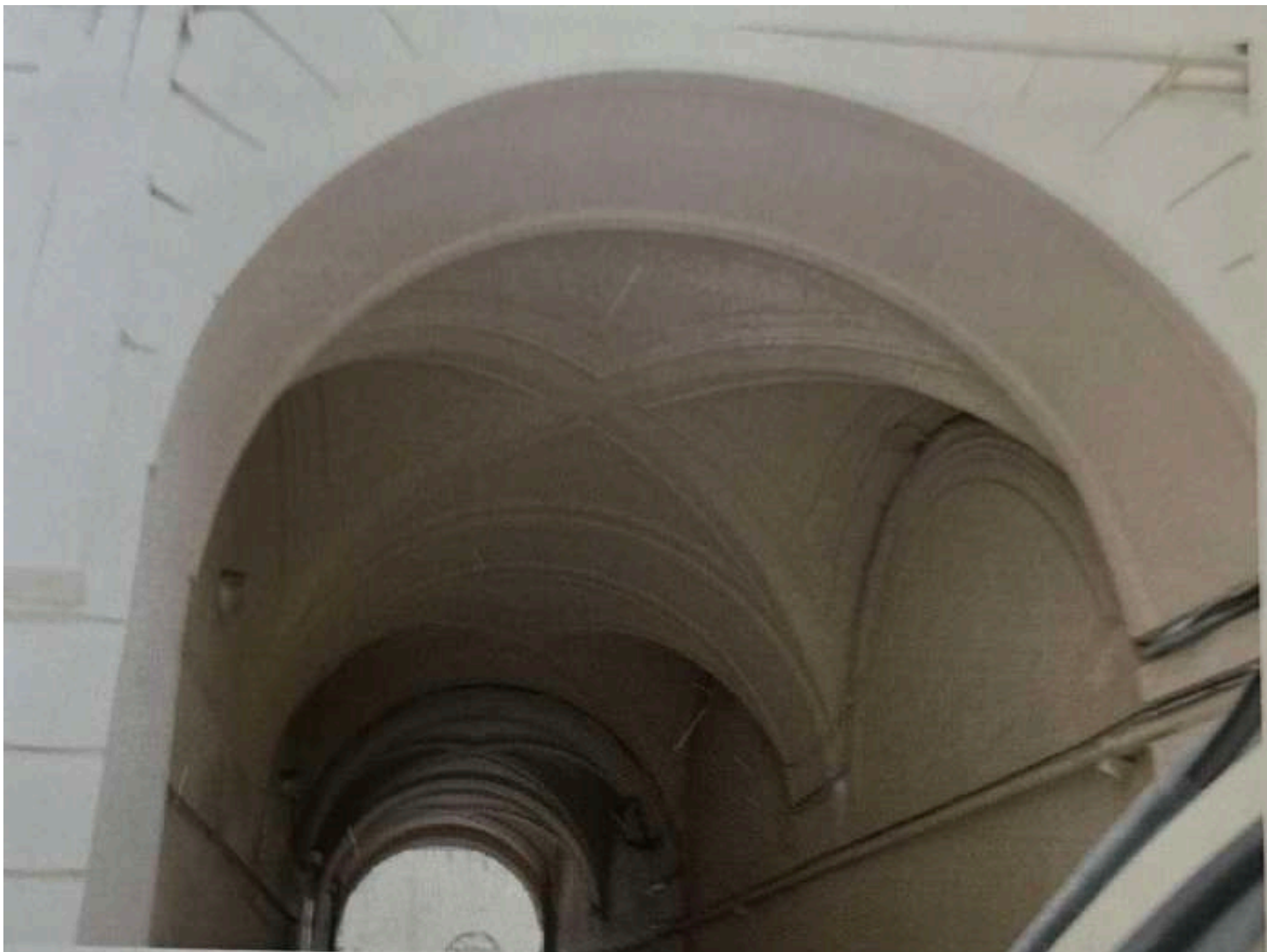
89. Перекрытие воротного проезда с лицевого фасада. Фотография. 2007 г. // Источник: Архив КГИОП. П.1500-Н. Пр.-105. Заключение по результатам обследования технического состояния основных несущих конструкций здания, расположенного по адресу: г. Санкт-Петербург, Невский пр., д.53. 2007 г.
