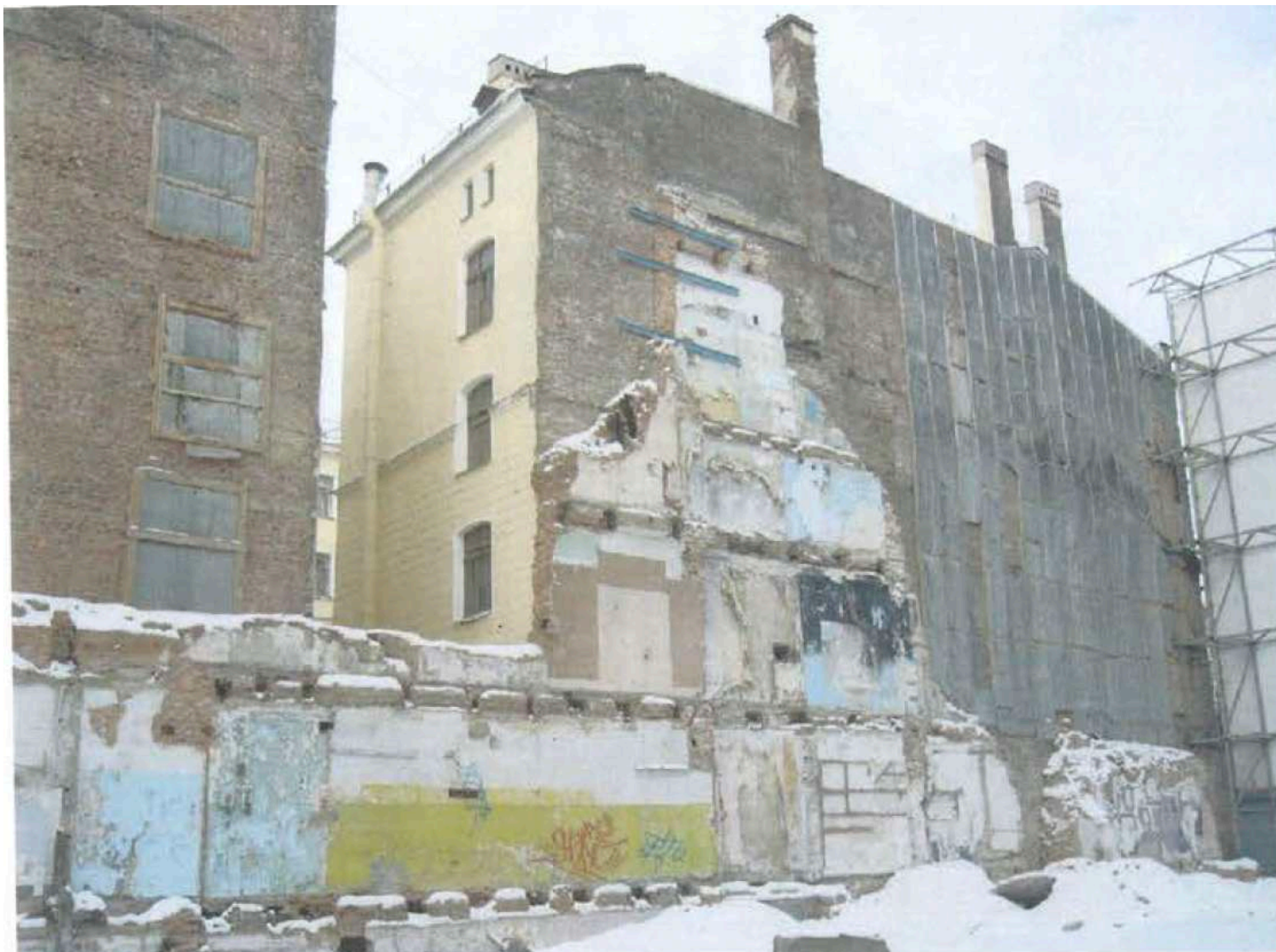
87. Часть стены соседнего демонтированного здания. Фотография. 2007 г. // Источник: Архив КГИОП. П.1500-Н. Пр.-105. Заключение по результатам обследования технического состояния основных несущих конструкций здания, расположенного по адресу: г. Санкт-Петербург, Невский пр., д.53. 2007 г.
