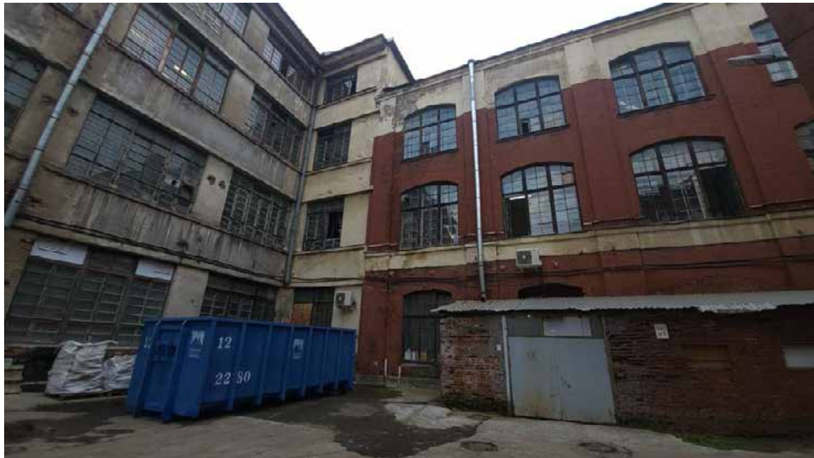
Фото 2. Объект культурного наследия регионального значения «Государственная типография» (Чкаловский пр., 15; Гатчинская ул., 26; Ораниенбаумская ул., 27) . Дата съемки:01.09.2024
