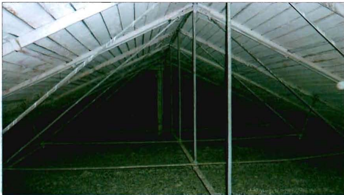
23. «Хлебный амбар» (наб. Обводного кан., 5а, лит. А). Чердак. Металлические фермы перекрытия.
