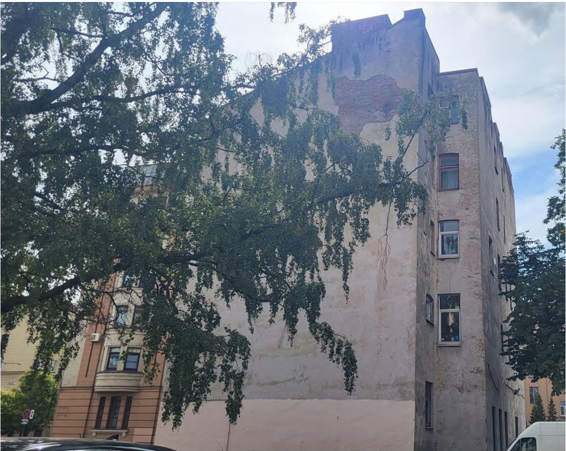
4. Выявленный объект культурного наследия «Дом Э.И. Гейдериха», расположенный по адресу: г. Санкт-Петербург, Сампсониевский Большой пр., 84. Дата: 01.09.24 г.
