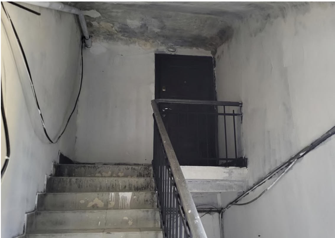
2. Выявленный объект культурного наследия «Дом Э.И. Гейдериха», расположенный по адресу: г. Санкт-Петербург, Сампсониевский Большой пр., 84. Дата: 01.09.24 г.
