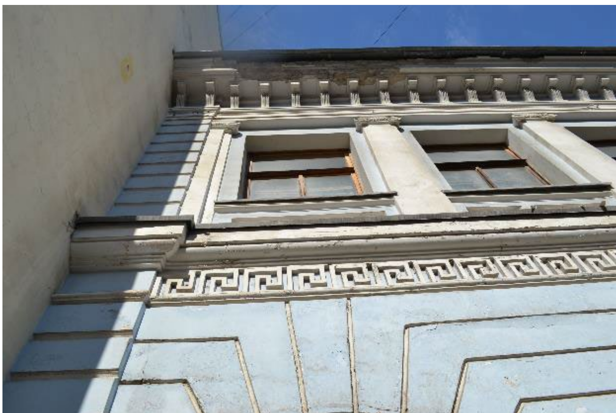
9. Юго-восточный лицевой фасад объекта культурного наследия федерального значения «Дом Демидова П.Н. (Гагариной В.Ф.)», расположенного по адресу: г. Санкт-Петербург, Большая Морская ул., д. 45, литера А. Фрагмент. 02.10.2024
