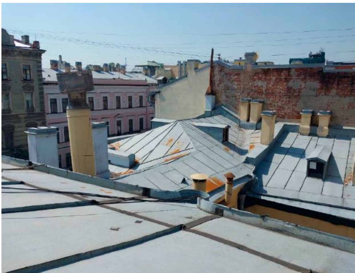
19. Кровля объекта культурного наследия федерального значения «Дом Демидова П.Н. (Гагариной В.Ф.)», расположенного по адресу: г. Санкт-Петербург, Большая Морская ул., д. 45, литера А. Фрагмент. 02.10.2024
