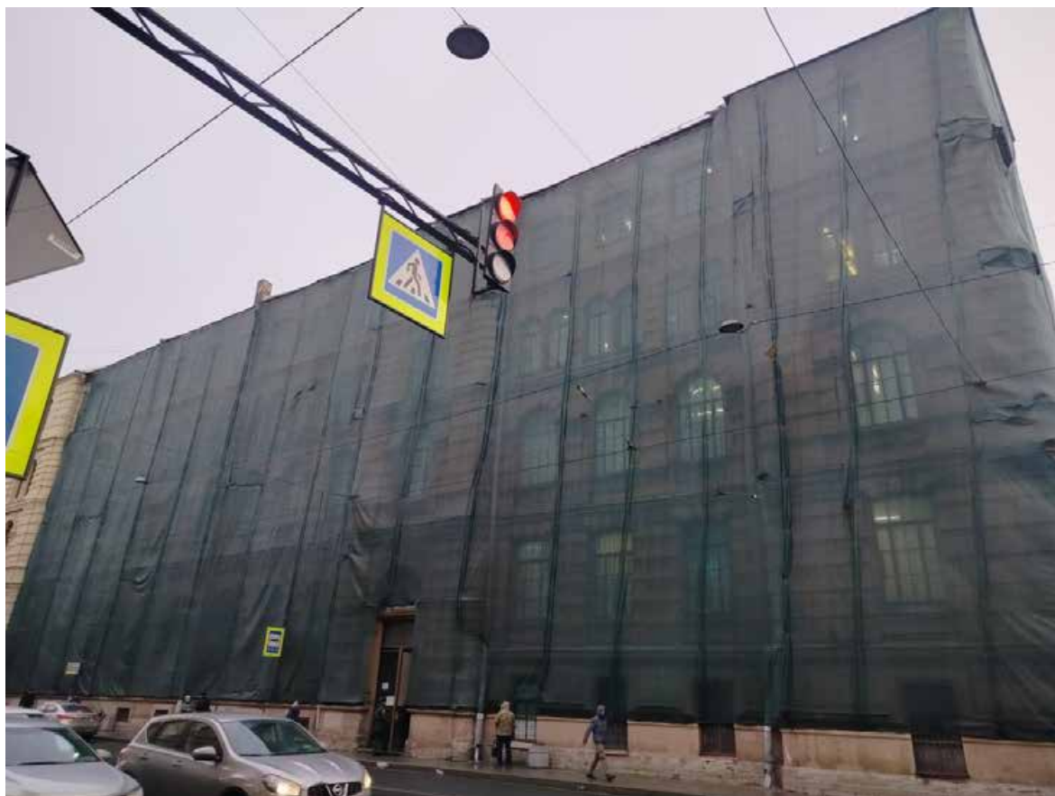
Фото 3. Фрагмент лицевого фасада выявленного объекта культурного наследия «Здание Третьей военной гимназии» (по Садовой ул.)
