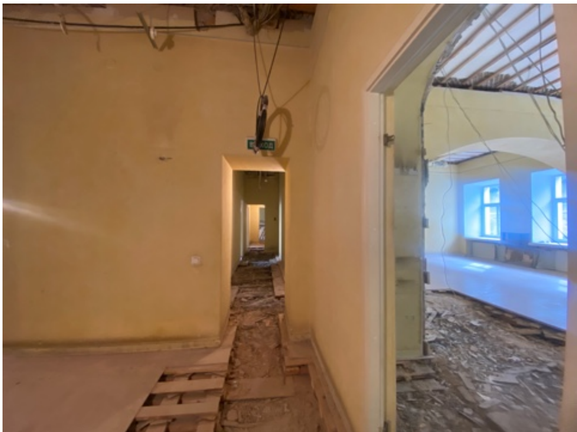
16. Здание по адресу: Санкт-Петербург, Невский проспект, д. 6, Лит. А. Интерьеры помещения 14-Н
