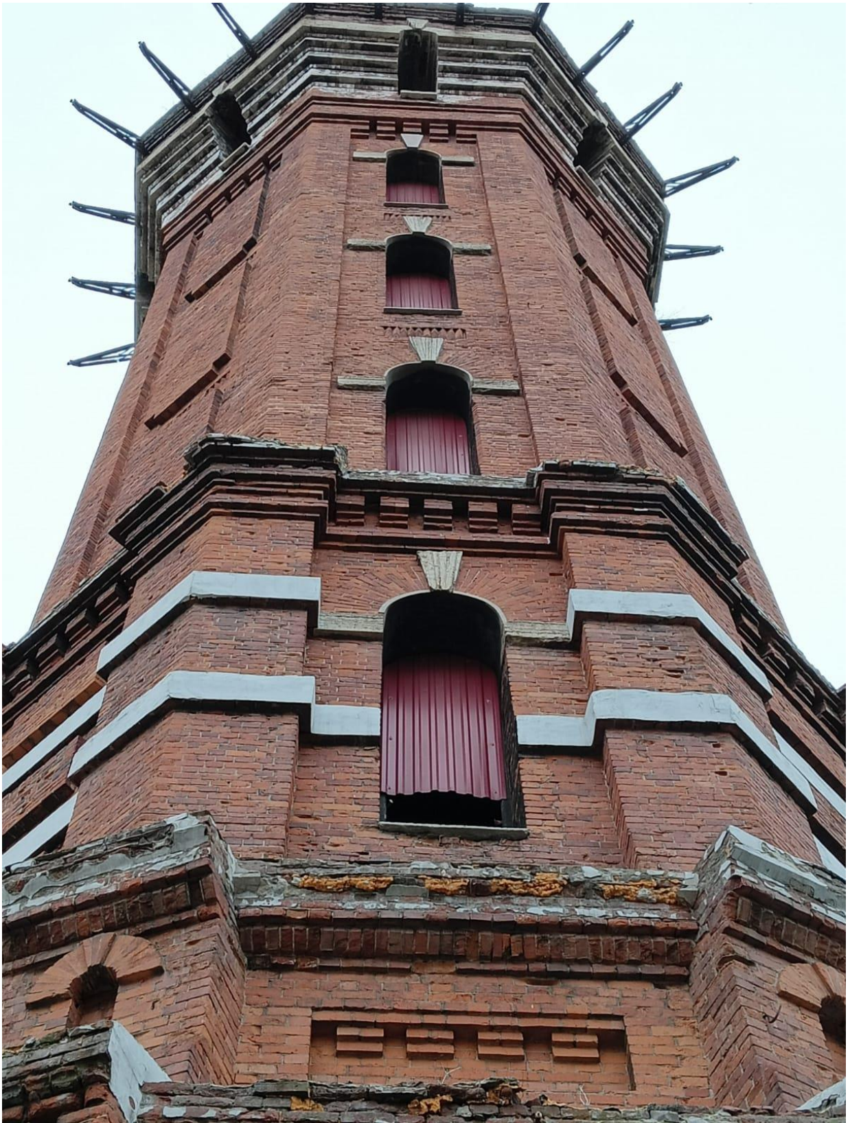
Фото 4. Выявленный объект культурного наследия «Водонапорная башня», расположенный по адресу: Санкт-Петербург, наб. Обводного канала, д. 118, литера Л, входящий в состав выявленного объекта культурного наследия «Комплекс построек Варшавского вокзала», расположенного по адресу: Санкт-Петербург, Обводного кан. наб., д. 118. Западная грань фасада (с оконными проемами).
