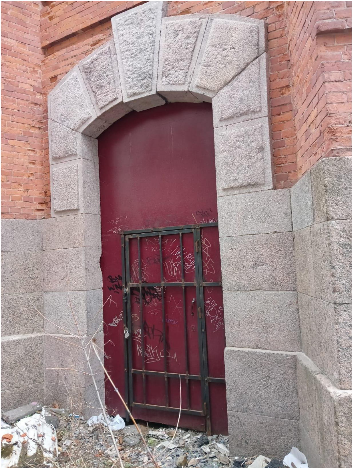
Фото 5. Выявленный объект культурного наследия «Водонапорная башня», расположенный по адресу: Санкт-Петербург, наб. Обводного канала, д. 118, литера Л, входящий в состав выявленного объекта культурного наследия «Комплекс построек Варшавского вокзала», расположенного по адресу: Санкт-Петербург, Обводного кан. наб., д. 118. Западная грань фасада, дверной проем под полуциркульной перемычкой оформлен фактурными гранитными блоками с замковым камнем.
