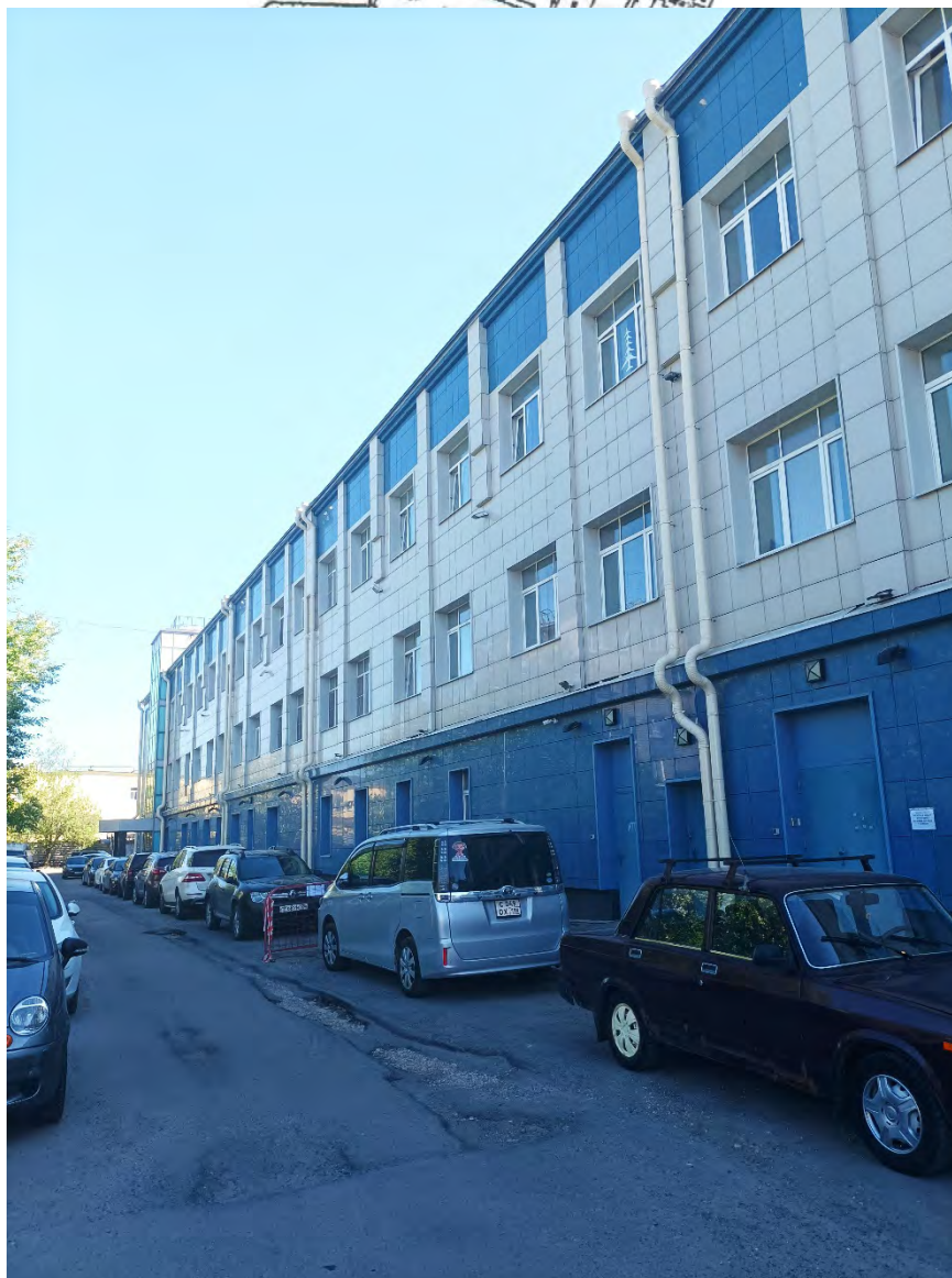
19. Объект культурного наследия регионального значения «Здание Института инженеров Гражданского воздушного флота». Вид объекта с северо-запада. Фрагмент фасада. Дата съемки: 02.05.2024г.
