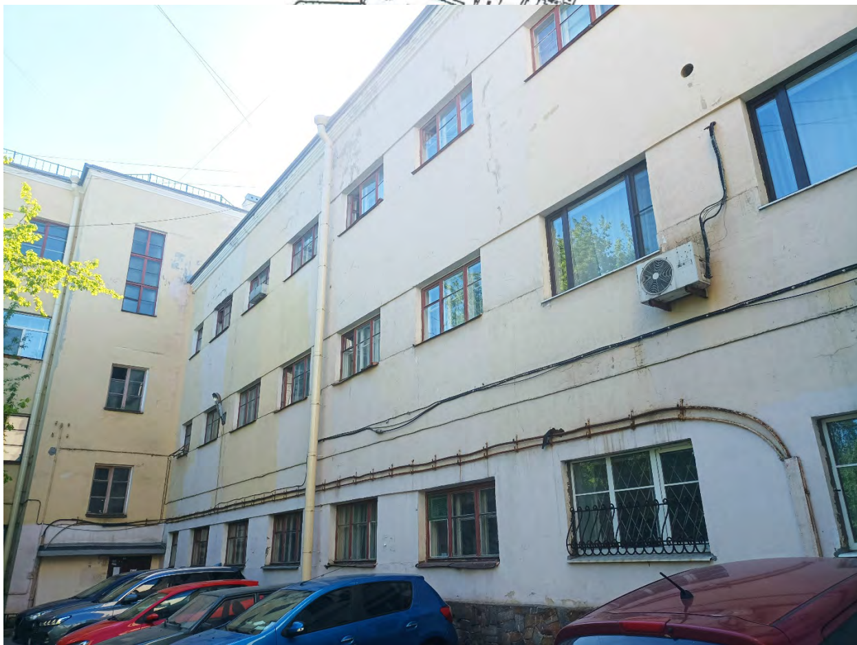
11. Объект культурного наследия регионального значения «Здание Института инженеров Гражданского воздушного флота». Вид объекта с северо-востока. Фрагмент фасада. Дата съемки: 02.05.2024г.
