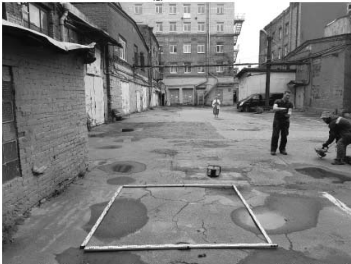
Рис. 73. Санкт-Петербург, Центральный р-н, Ул. Новгородская, д. 14, литера А. Шурф 2. Общий вид до начала работ. Вид на юго-восток.
