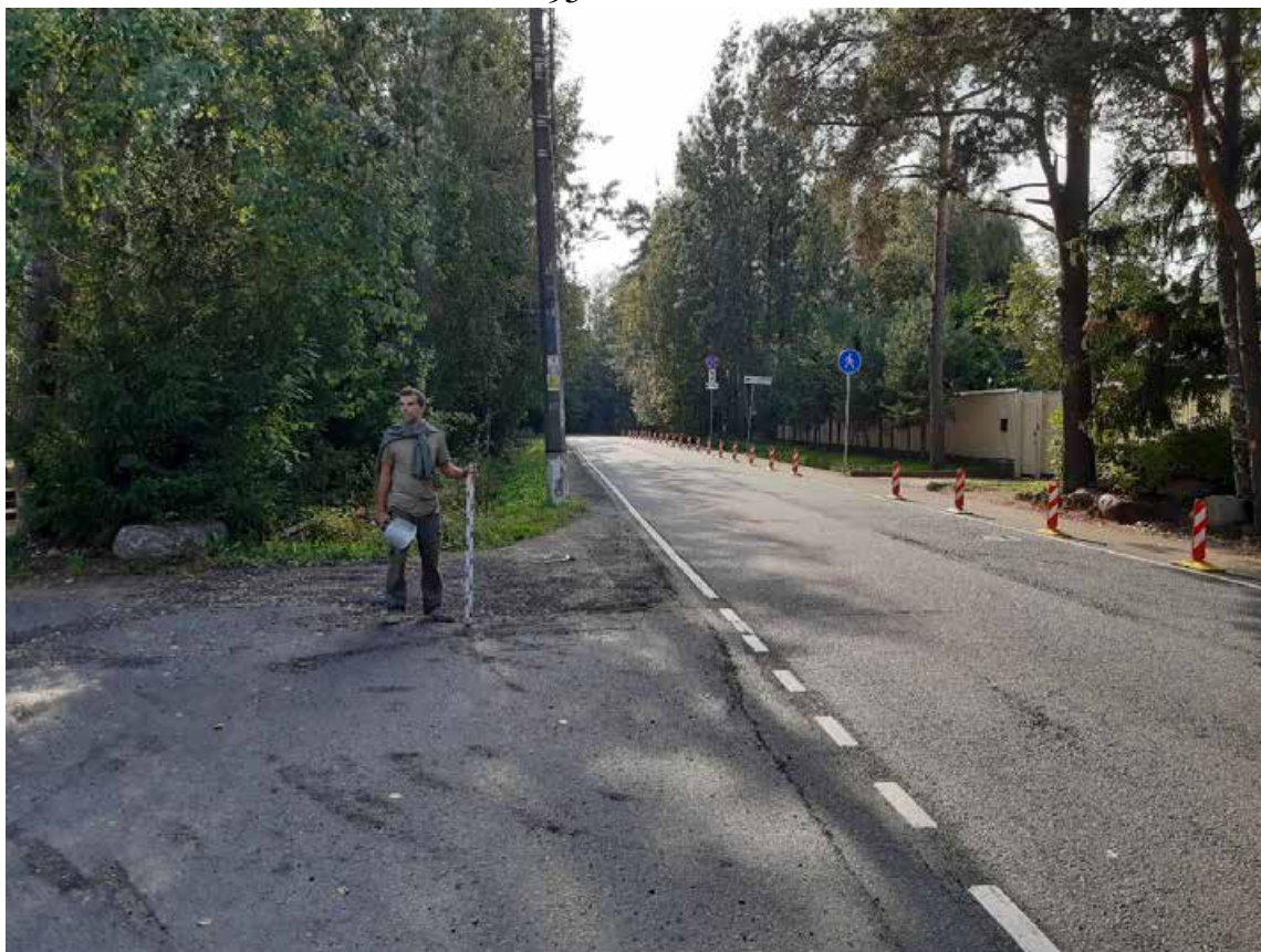
Рис. 32. Санкт-Петербург, Курортный район, Реконструкция Вокзальной ул. в пос. Солнечное. Общий вид трассы. Точка съемки 11. Вид на юго-запад.
