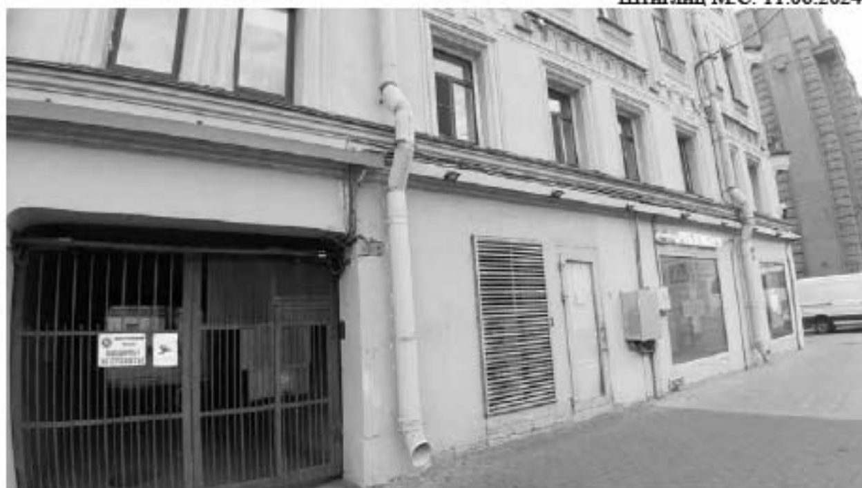
30. Доходные дома Н.И. Львовой (А.Д. Сивкова) (Московский пр., д. 63, лит. А). Лицевой фасад. Фото мест установки оборудования и прокладки кабельных трасс. Штиглиц М.С. 11.06.2024.
