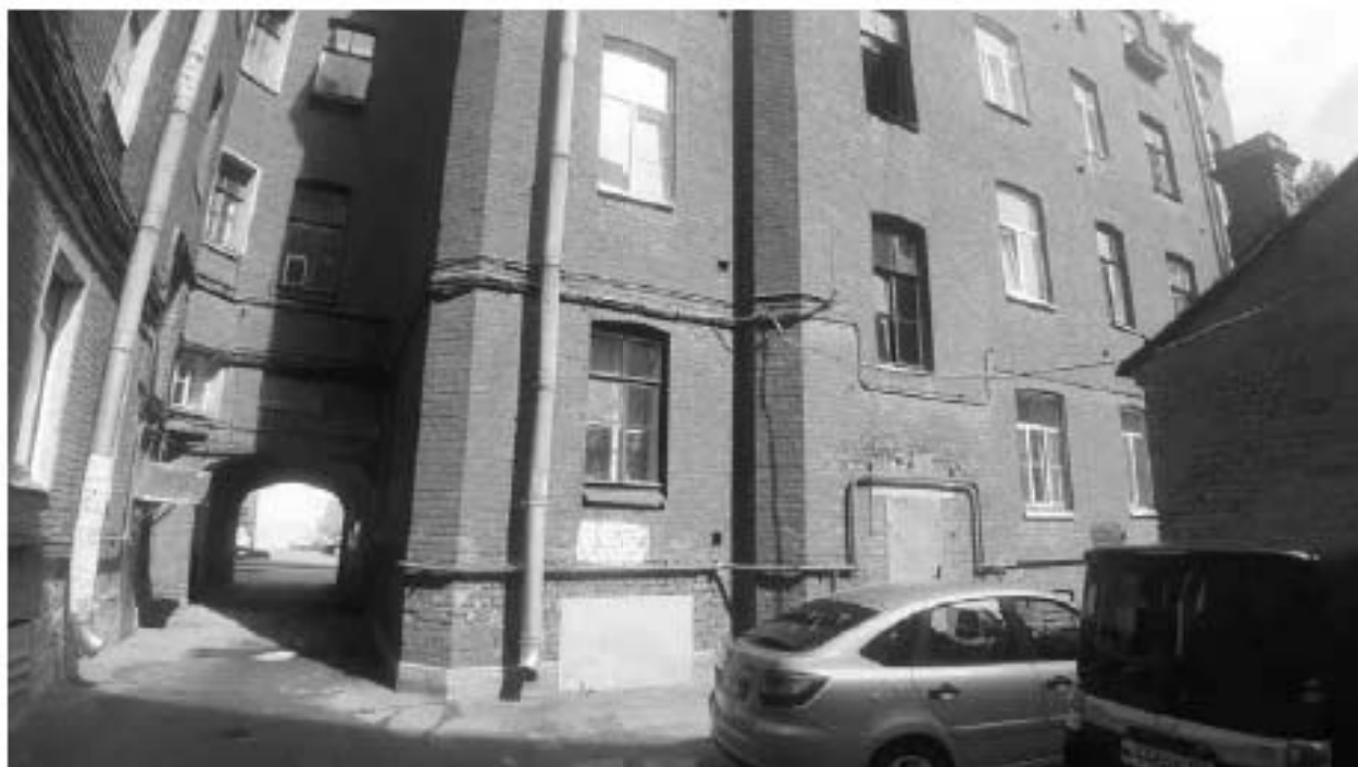
43. Доходный дом (в составе «Дом и фабрика шелковых изделий А.И.Ниссена») (наб. реки Фонтанки, д. 183, лит. А). Дворовый фасад. Фото мест установки оборудования и прокладки кабельных трасс. Штиглиц М.С. 11.06.2024.
