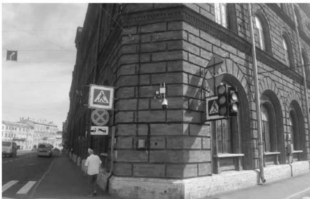
18. Съезжий дом 4-й Адмиралтейской (Коломенской) части (пл. Репина, 1/201, лит. А). Лицевой фасад. Фото мест установки оборудования и прокладки кабельных трасс. Штиглиц М.С. 11.06.2024.
