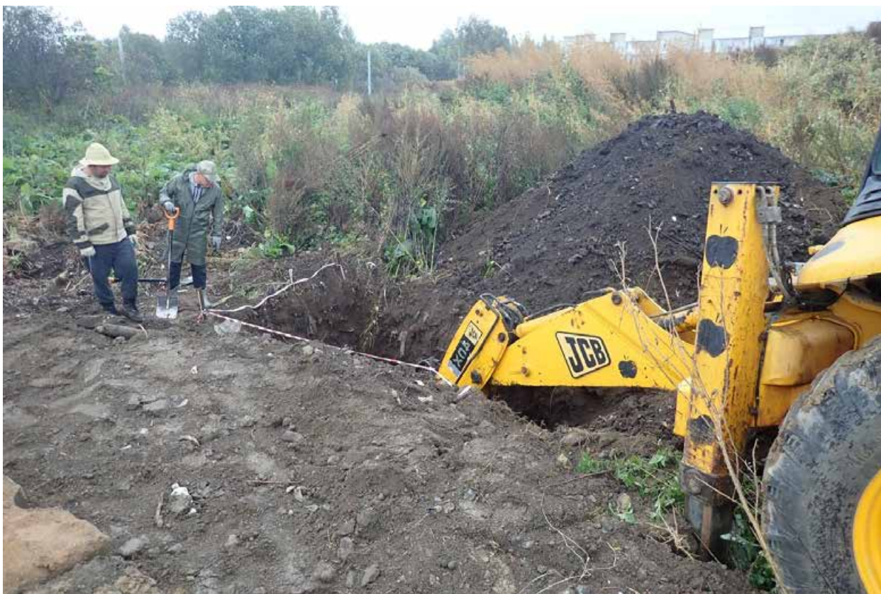
Рис. 12 Земельный участок по адресу Санкт-Петербург, п. Стрельна, ш. Красносельское. Рабочий момент. Выборка напластований бытового и строительного мусора землеройной техникой под наблюдением специалиста-археологов. Вид с юго-востока.
