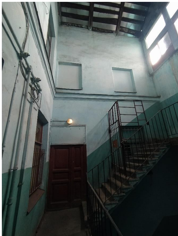
Фото 39. Вид на вход и окно, выходящие на лестничную клетку № 6, квартиры № 29, расположенной над квартирой № 25.
