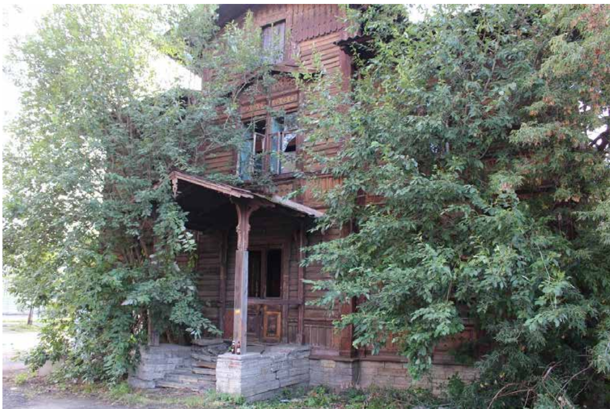
Фото 3. Вид на восточный фасад объекта культурного наследия регионального значения «Жилой дом (деревянный двухэтажный)».
