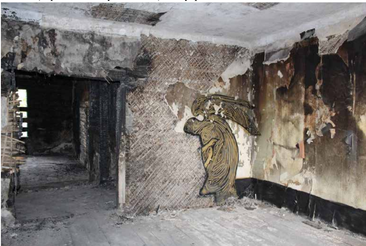
Фото 66. Объект культурного наследия регионального значения «Жилой дом (деревянный двухэтажный)». Внутренние помещения 2-го этажа.
