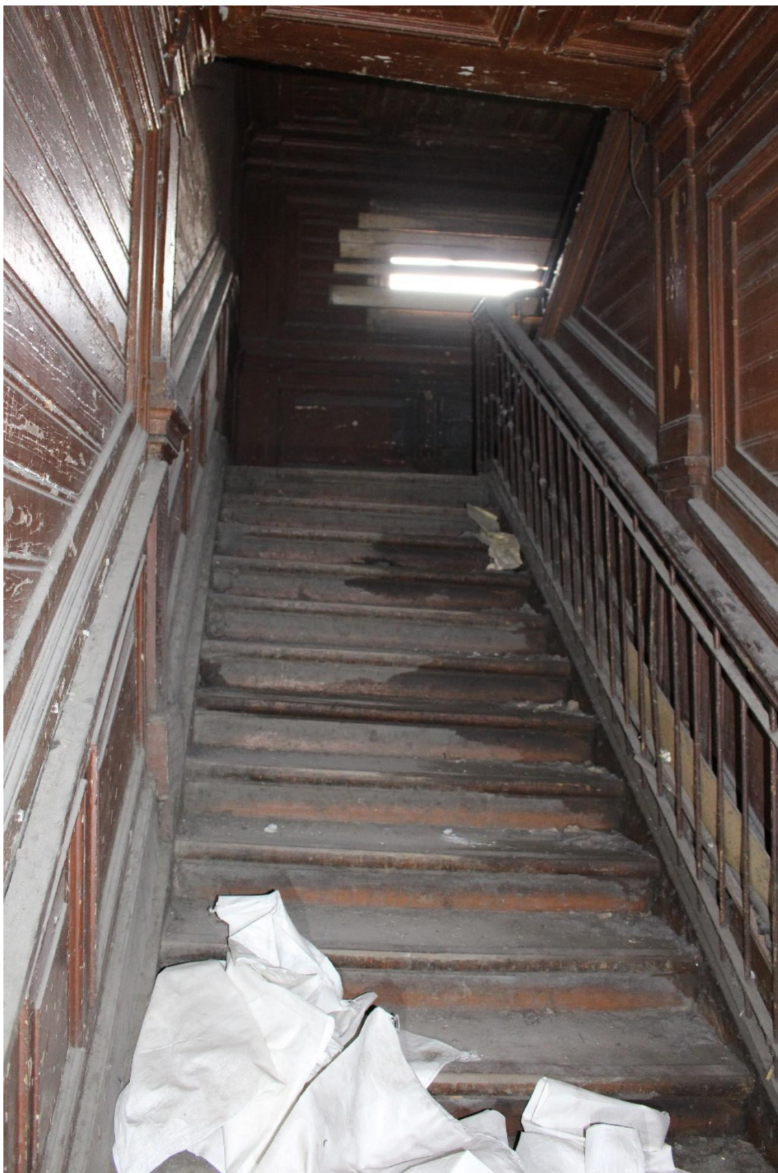
Фото 91. Объект культурного наследия регионального значения «Жилой дом (деревянный двухэтажный)». Лестничная клетка 2ЛК.
