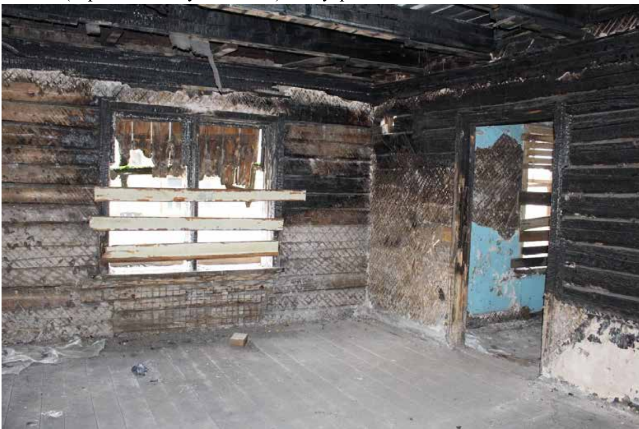
Фото 83. Объект культурного наследия регионального значения «Жилой дом (деревянный двухэтажный)». Внутренние помещения 2-го этажа.
