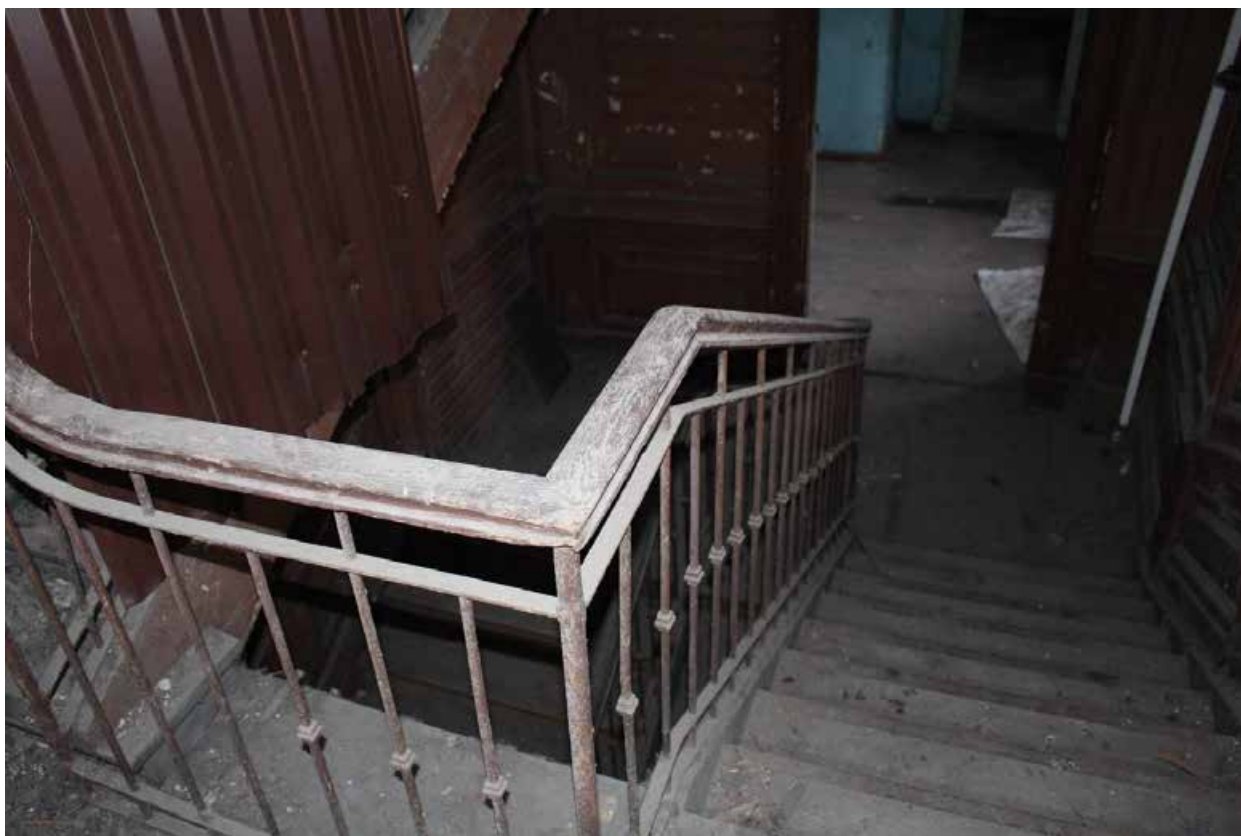
Фото 86. Объект культурного наследия регионального значения «Жилой дом (деревянный двухэтажный)». Лестничная клетка 2ЛК.
