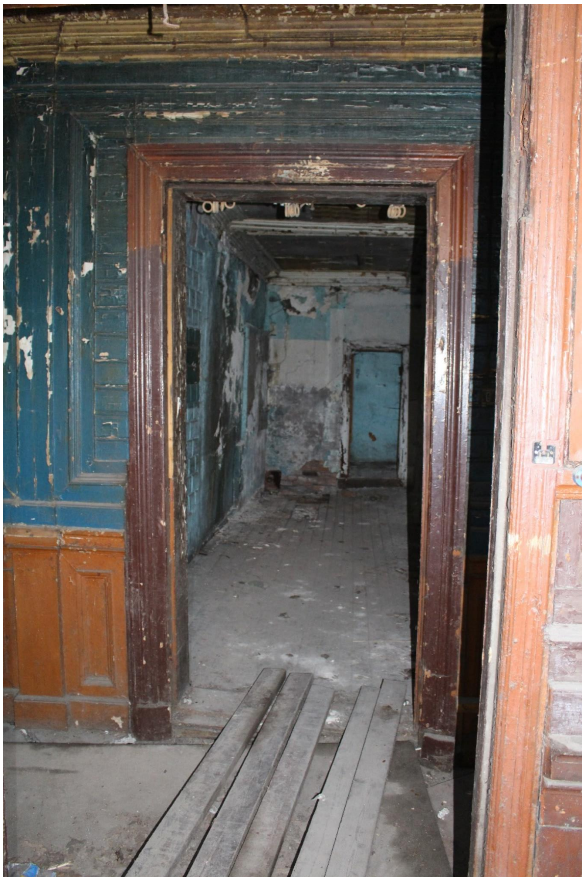
Фото 11. Объект культурного наследия регионального значения «Жилой дом (деревянный двухэтажный)». Внутренние помещения 1-го этажа.
