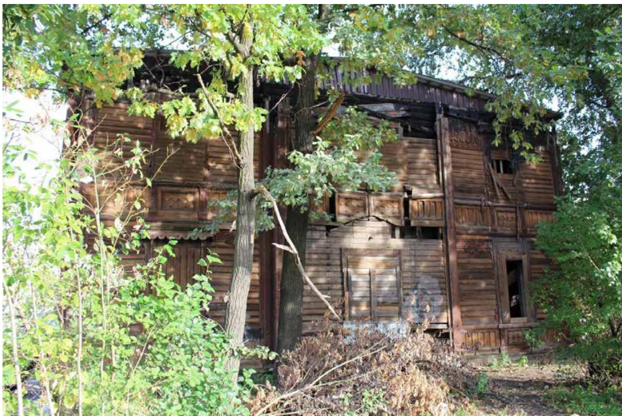
Фото 9. Вид на западный фасад объекта культурного наследия регионального значения «Жилой дом (деревянный двухэтажный)».
