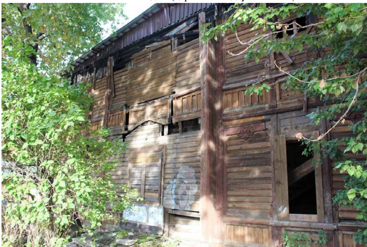
Фото 8. Вид на западный фасад объекта культурного наследия регионального значения «Жилой дом (деревянный двухэтажный)».
