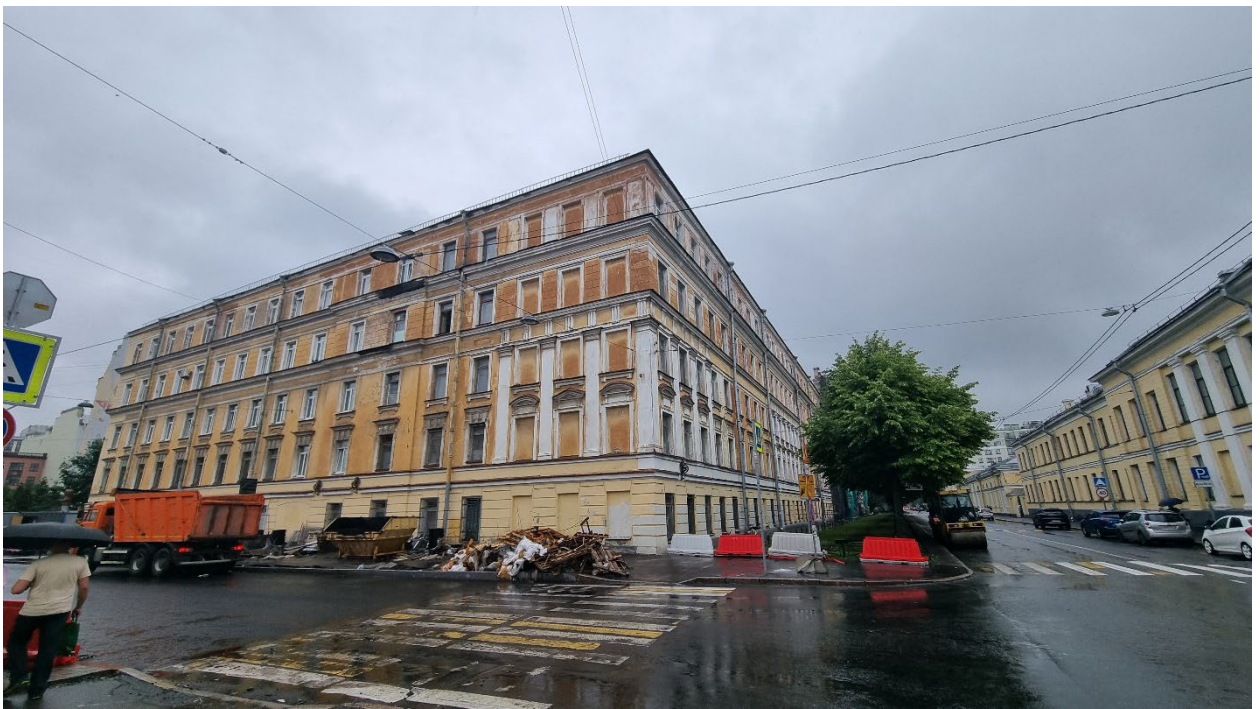
2. Вид на юго-западный и юго-восточный фасады объекта культурного наследия регионального значения «Здание, где с 1886 г. размещалось военно-топографическое училище, в котором преподавали Цингер Н.Я. и Витковский В.В.» расположенный по адресу: г. Санкт-Петербург, Пионерская ул., д. 20, литера Б. 14.06.2024
