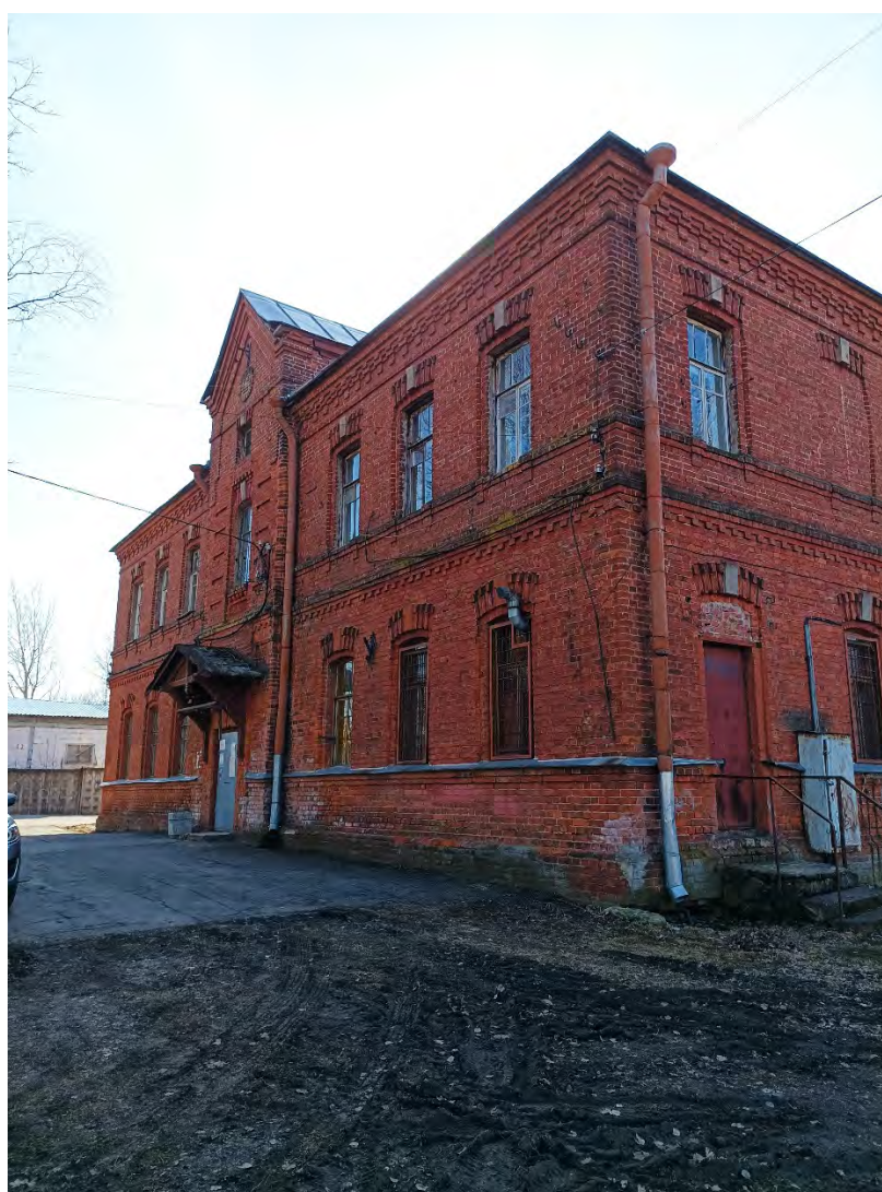
6. «Мастерские», по адресу: Санкт-Петербург, г. Павловск, Динамо, Клубная пл., д. 1, лит. А. Фасад восточный. Дата съемки: 25.03.2024 г.
