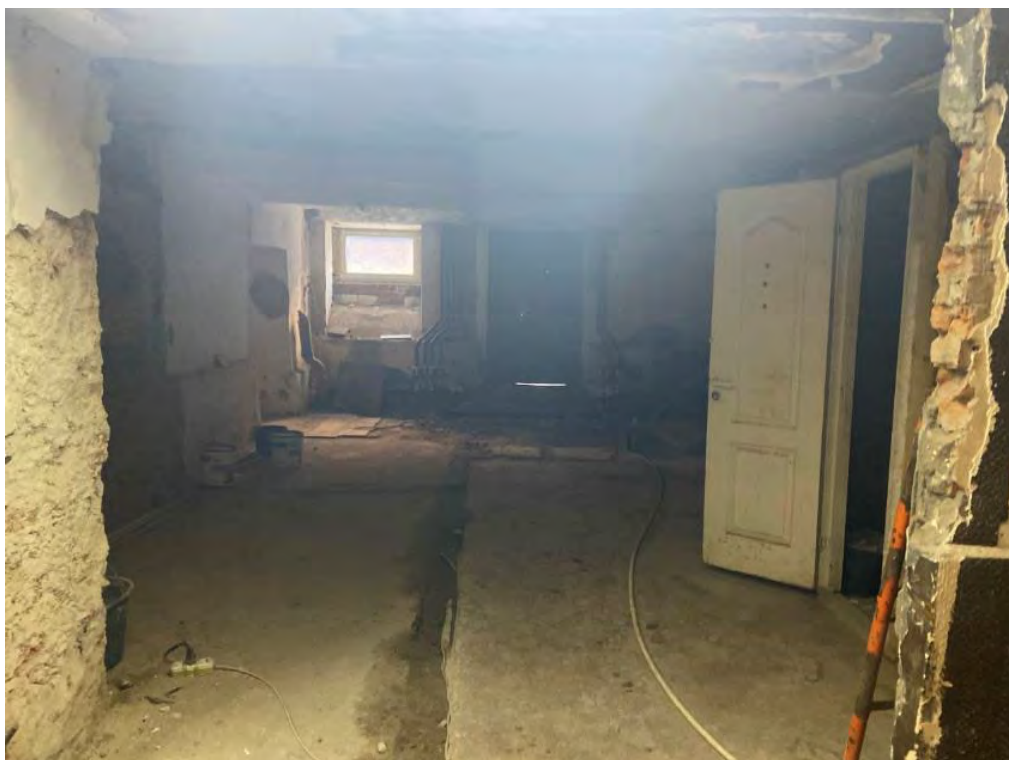
Фото №46. Помещение цокольного этажа. Сентябрь 2024г.
