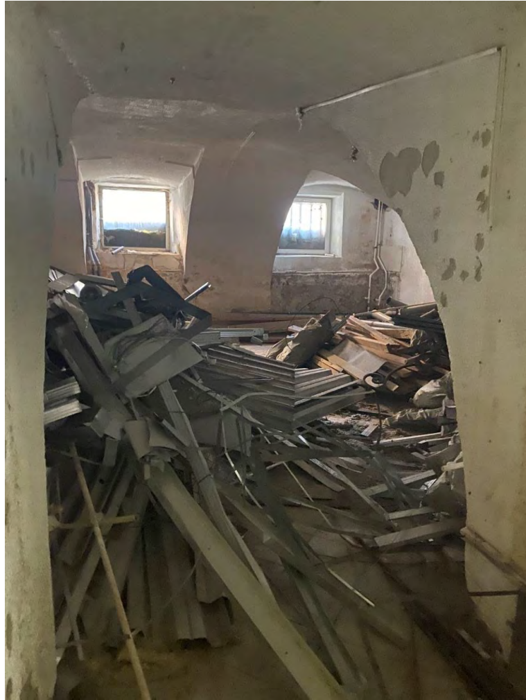
Фото №48. Помещение цокольного этажа. Сентябрь 2024г.
