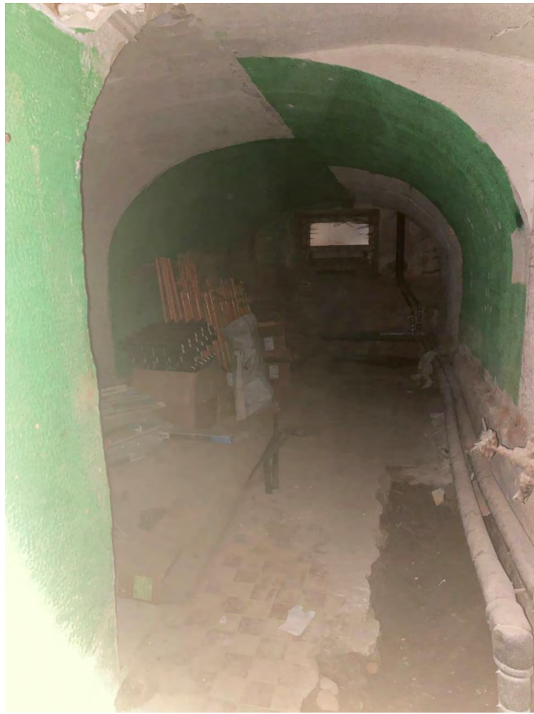
Фото №49. Помещение цокольного этажа. Сентябрь 2024г.
