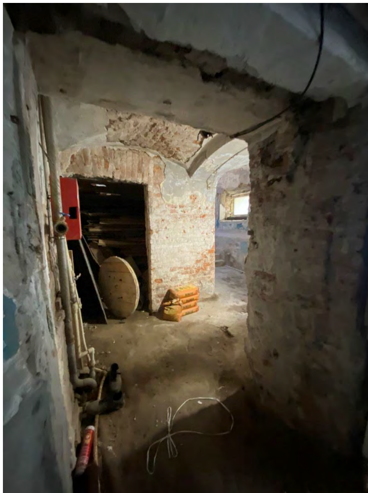
Фото №50. Помещение цокольного этажа. Сентябрь 2024г.
