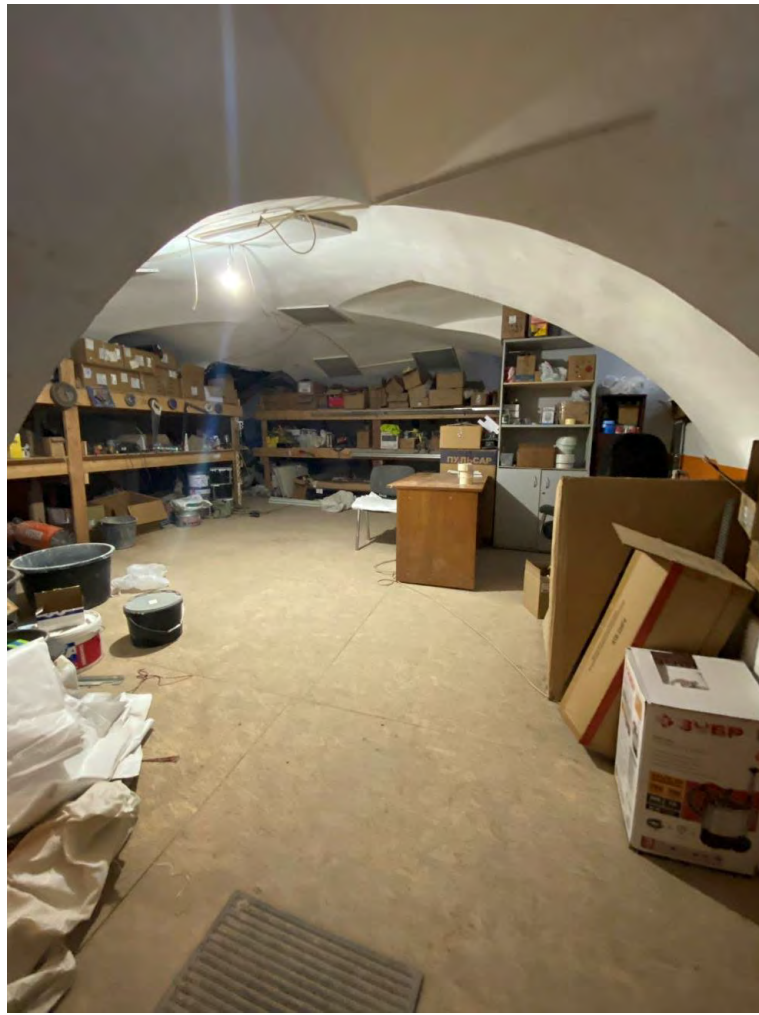
Фото №51. Помещение цокольного этажа. Сентябрь 2024г.
