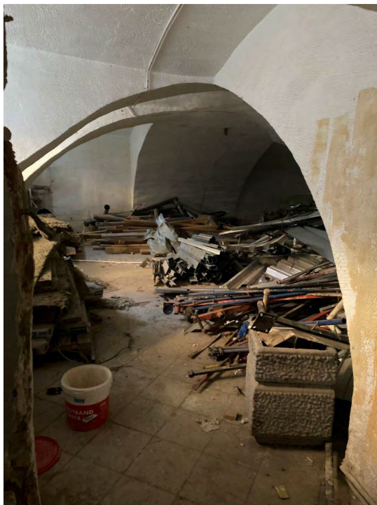
Фото №47. Помещение цокольного этажа. Сентябрь 2024г.
