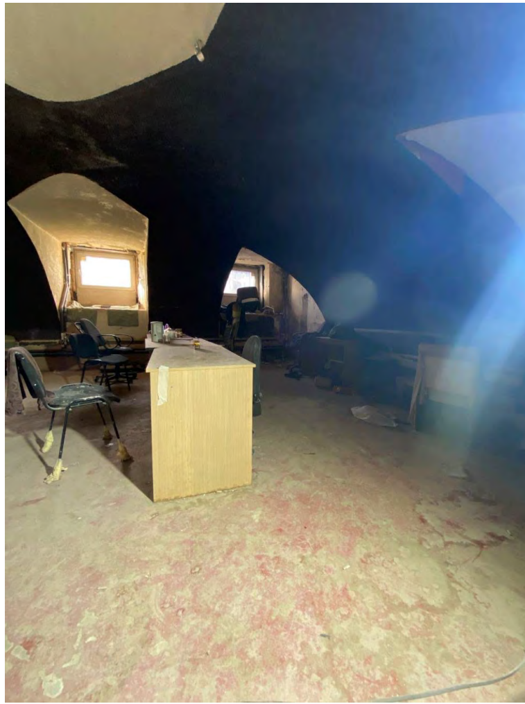
Фото №44. Помещение цокольного этажа. Сентябрь 2024г.
