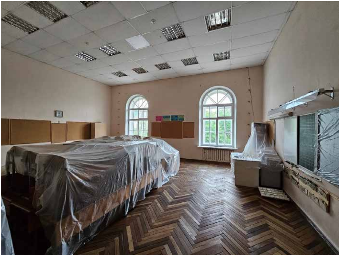
169. Объект культурного наследия регионального значения «Павловский институт с территорией, садом и оградой», по адресу: г. Санкт-Петербург, ул. Восстания, д. 8, лит. А. Общий вид пом. 11-Н (32) в уровне 3-го этажа.
