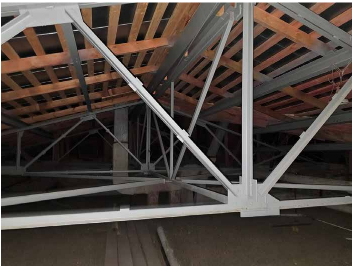
218. Объект культурного наследия регионального значения «Павловский институт с территорией, садом и оградой», по адресу: г. Санкт-Петербург, ул. Восстания, д. 8, лит. А. Фрагмент конструкции крыши северного корпуса.
