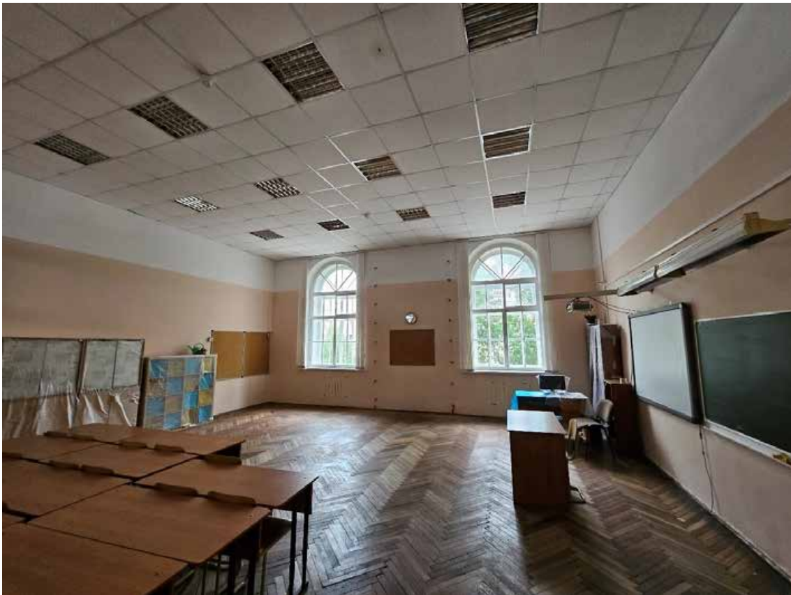
112. Объект культурного наследия регионального значения «Павловский институт с территорией, садом и оградой», по адресу: г. Санкт-Петербург, ул. Восстания, д. 8, лит. А. Общий вид пом. 7-Н (37) в уровне 2-го этажа.
