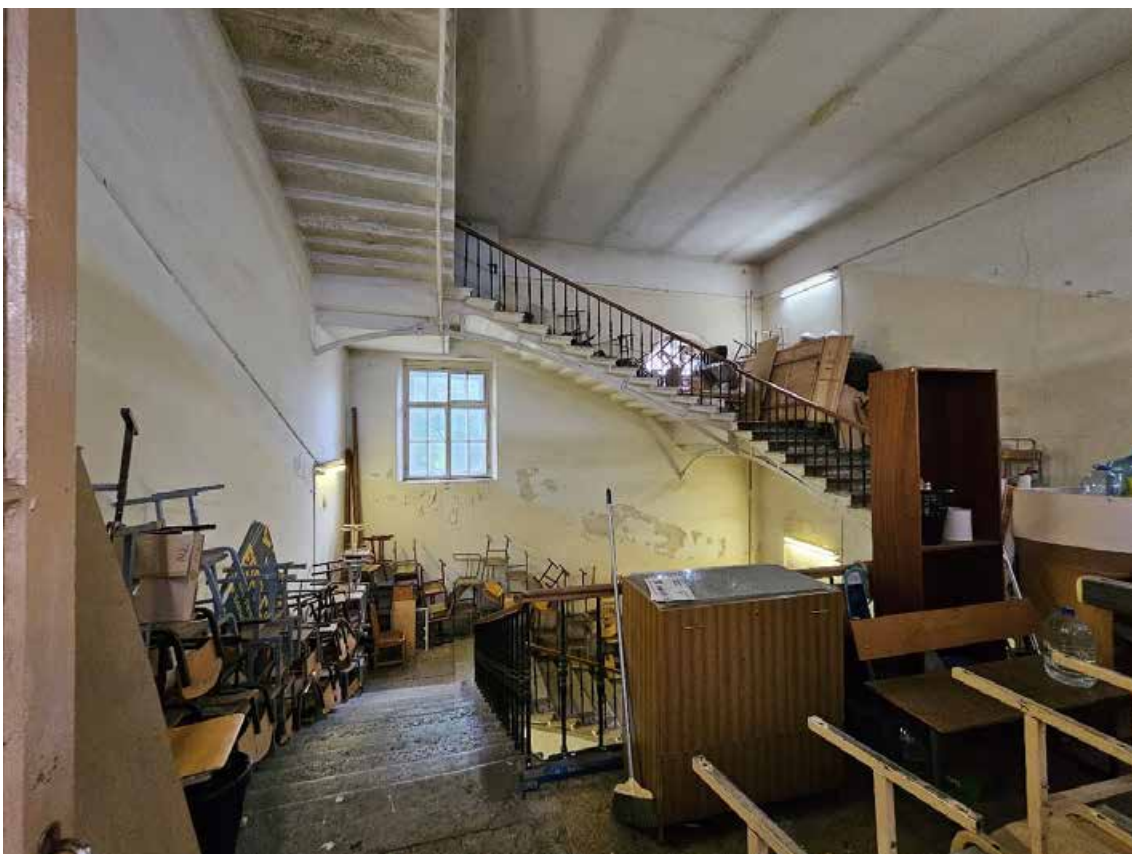
197. Объект культурного наследия регионального значения «Павловский институт с территорией, садом и оградой», по адресу: г. Санкт-Петербург, ул. Восстания, д. 8, лит. А. Общий вид четырехмаршевой лестницы в пом. 2ЛК (4) в уровне 3-го этажа.
