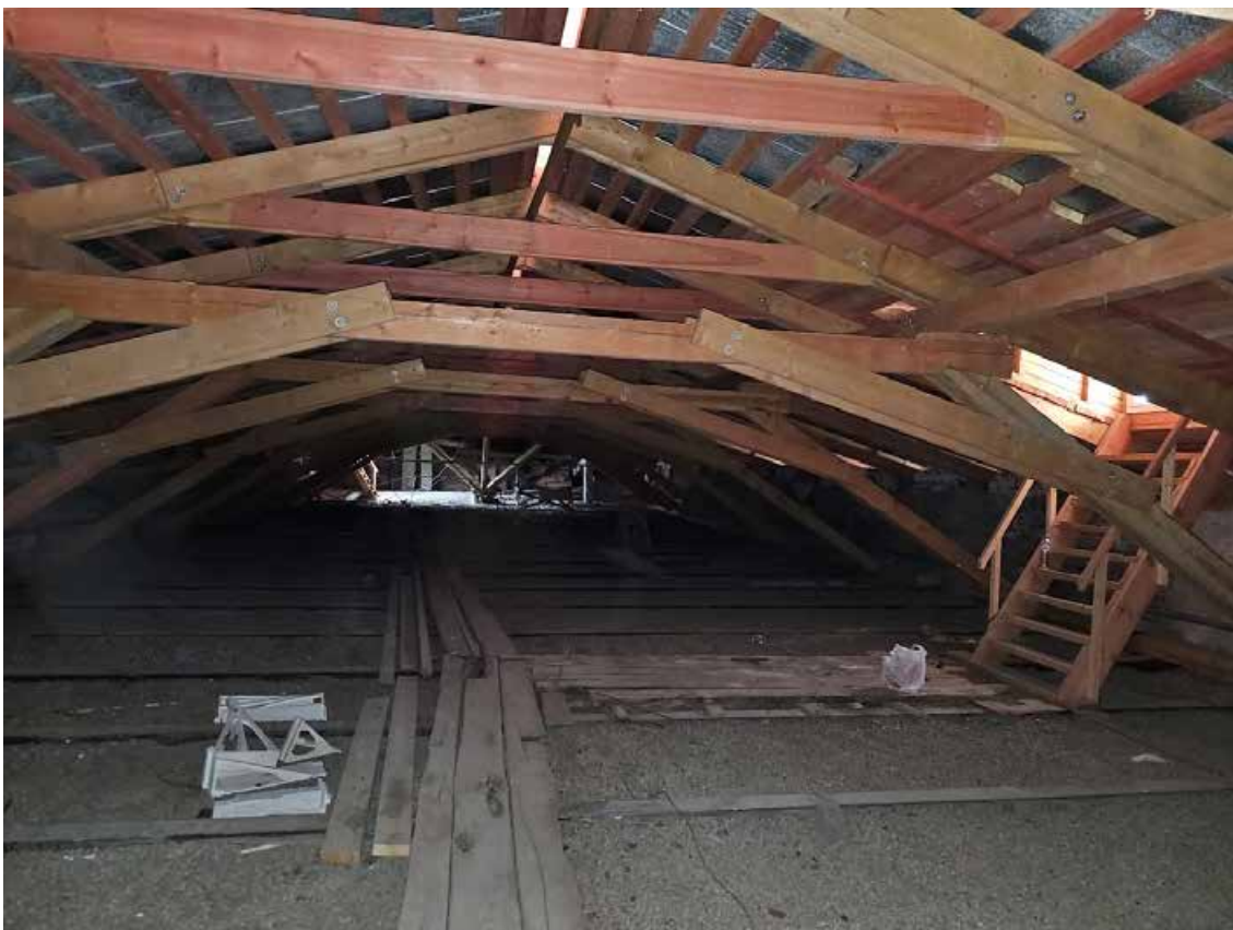
209. Объект культурного наследия регионального значения «Павловский институт с территорией, садом и оградой», по адресу: г. Санкт-Петербург, ул. Восстания, д. 8, лит. А. Фрагмент конструкции крыши южного корпуса.
