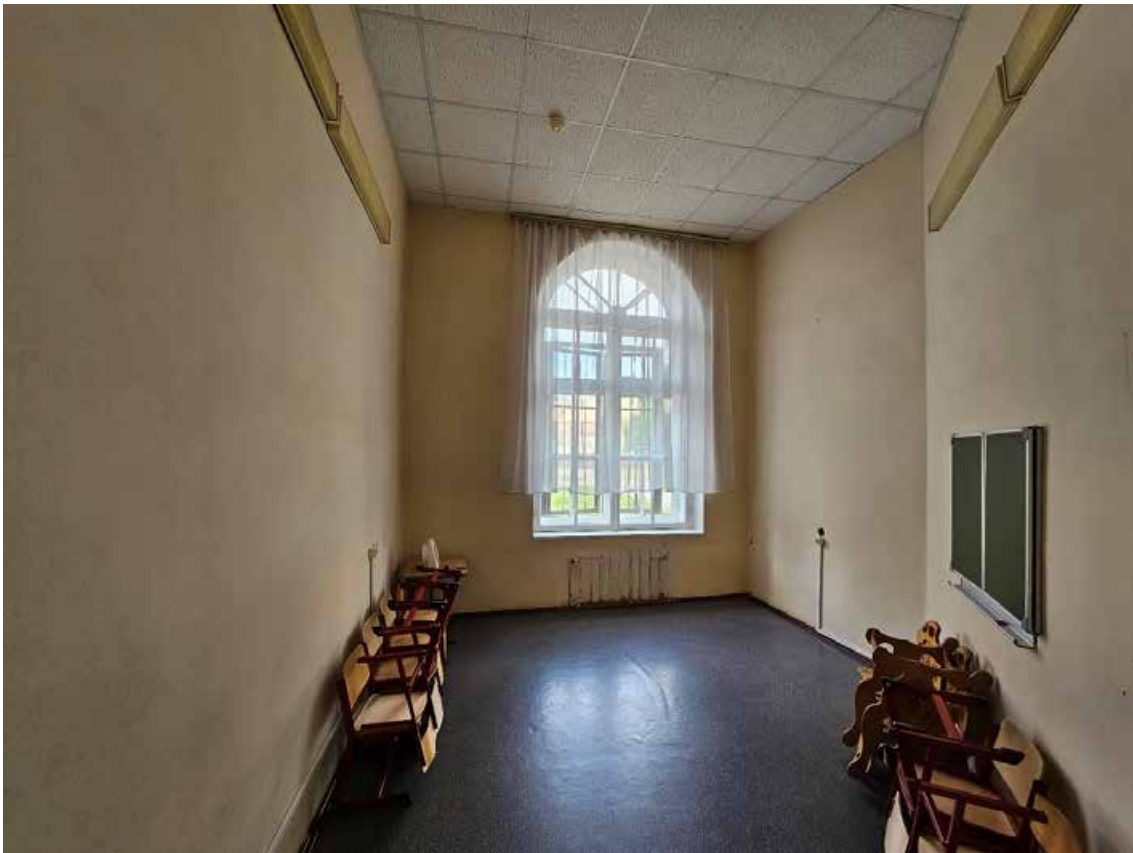
93. Объект культурного наследия регионального значения «Павловский институт с территорией, садом и оградой», по адресу: г. Санкт-Петербург, ул. Восстания, д. 8, лит. А. Общий вид пом. 5-Н (47) в уровне 1-го этажа.
