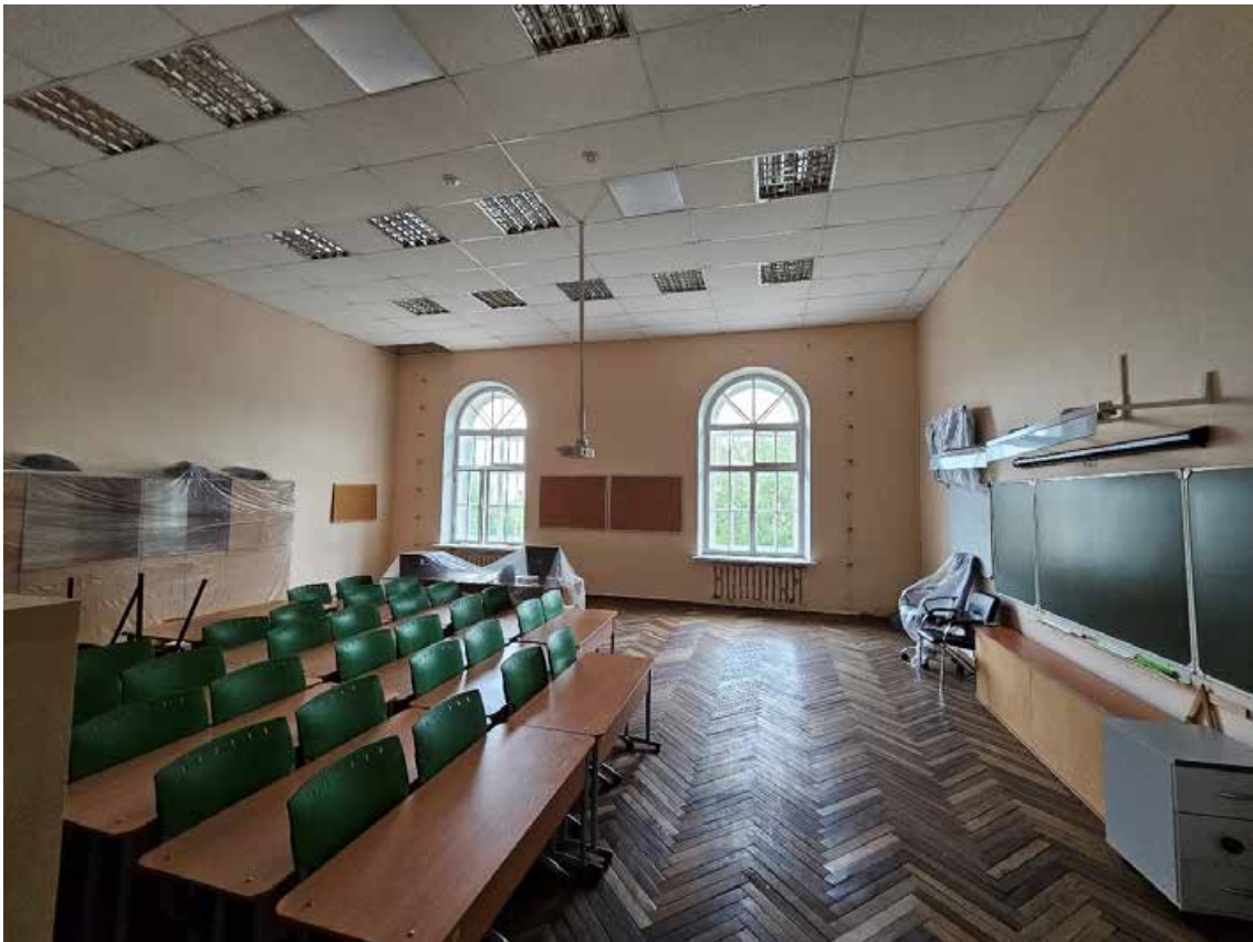
165. Объект культурного наследия регионального значения «Павловский институт с территорией, садом и оградой», по адресу: г. Санкт-Петербург, ул. Восстания, д. 8, лит. А. Общий вид пом. 11-Н (29) в уровне 3-го этажа.
