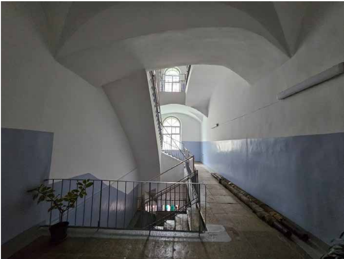
117. Объект культурного наследия регионального значения «Павловский институт с территорией, садом и оградой», по адресу: г. Санкт-Петербург, ул. Восстания, д. 8, лит. А. Общий вид трехмаршевой лестницы в пом. 6ЛК (3) в уровне 2-го этажа.
