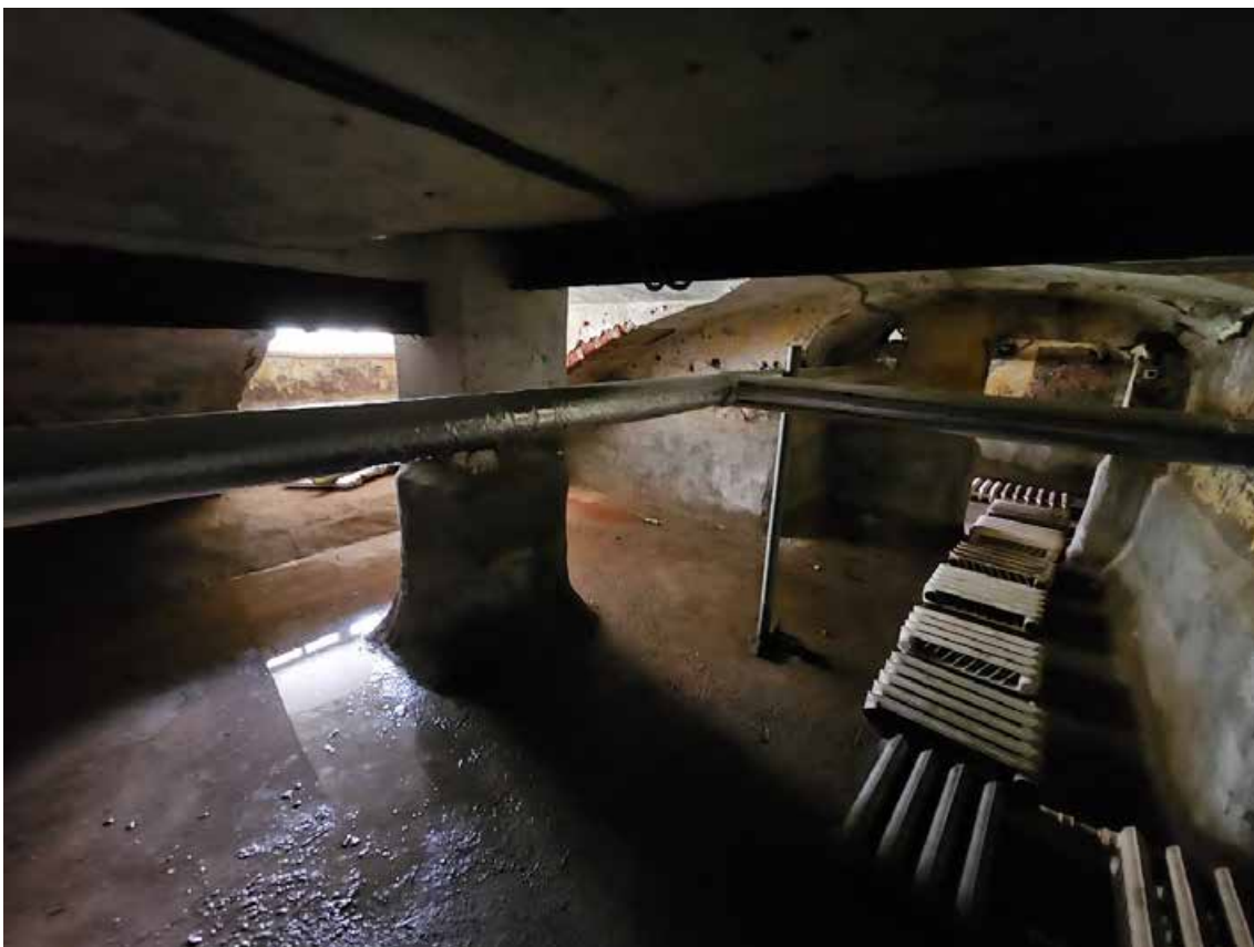
22. Объект культурного наследия регионального значения «Павловский институт с территорией, садом и оградой», по адресу: г. Санкт-Петербург, ул. Восстания, д. 8, лит. А. Общий вид пом. 4-Н (13) в уровне подвала.
