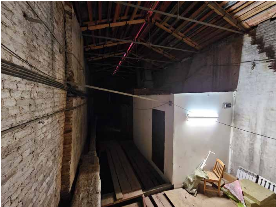
212. Объект культурного наследия регионального значения «Павловский институт с территорией, садом и оградой», по адресу: г. Санкт-Петербург, ул. Восстания, д. 8, лит. А. Фрагмент пространства чердака лицевого корпуса.
