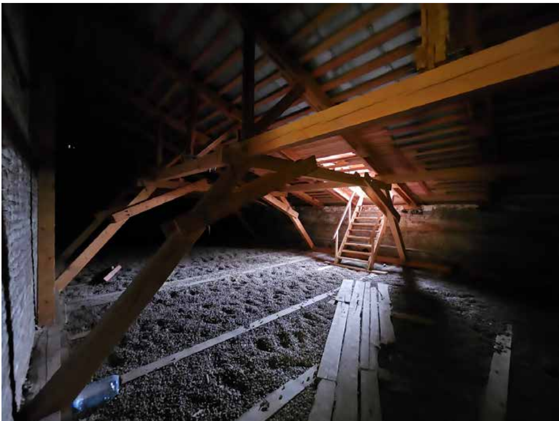
216. Объект культурного наследия регионального значения «Павловский институт с территорией, садом и оградой», по адресу: г. Санкт-Петербург, ул. Восстания, д. 8, лит. А. Фрагмент конструкции крыши в северной части лицевого корпуса.
