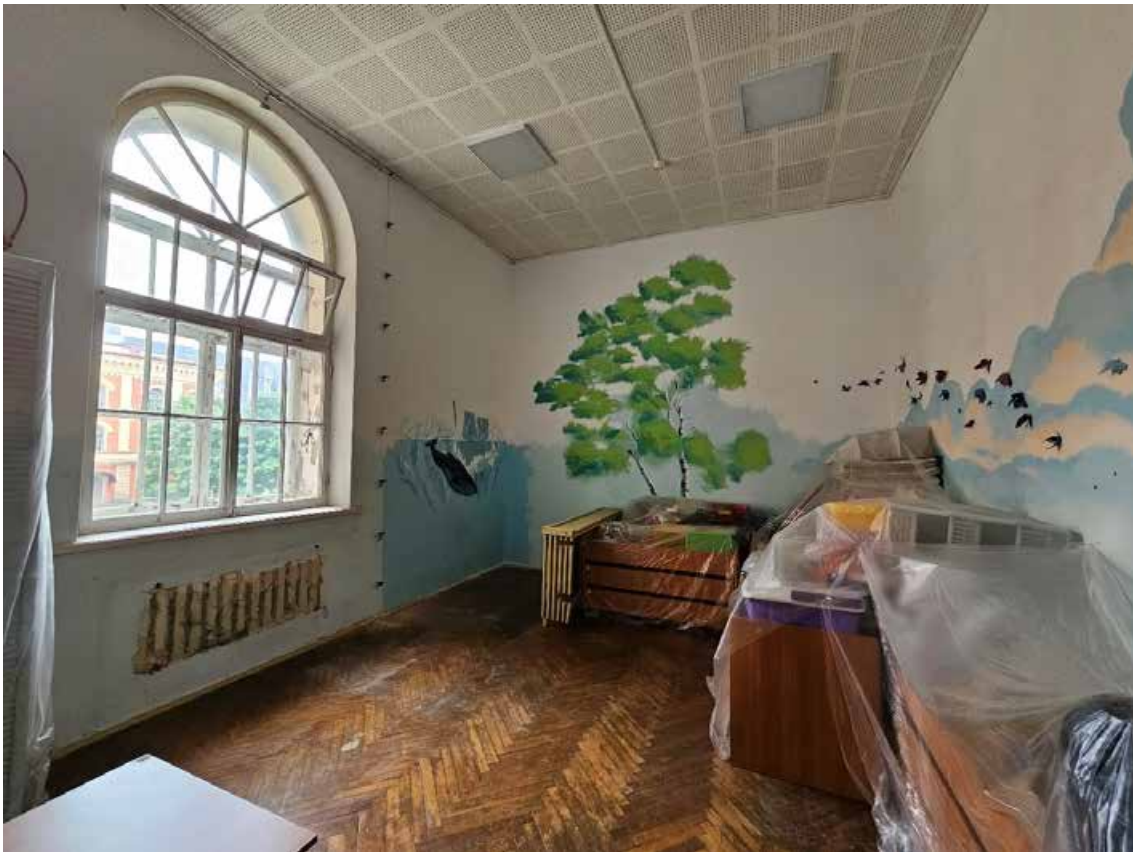
122. Объект культурного наследия регионального значения «Павловский институт с территорией, садом и оградой», по адресу: г. Санкт-Петербург, ул. Восстания, д. 8, лит. А. Общий вид пом. 13-Н (9) в уровне 2-го этажа.
