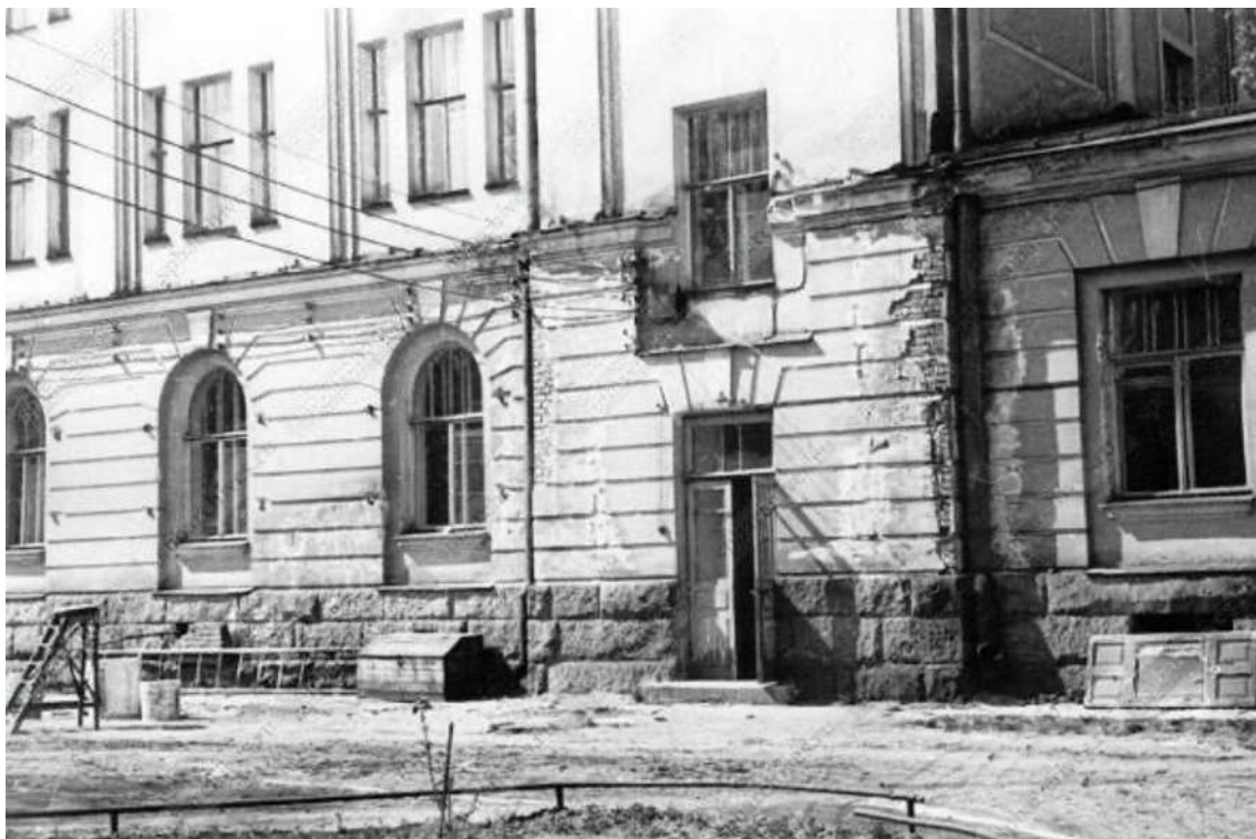
Илл. 82. Повреждённый угол здания гербария. Автор съёмки: Лаптев Сергей Дмитриевич. Дата съёмки: май 1945 г. Источник: ЦГАКФФД СПб Ар 202686
