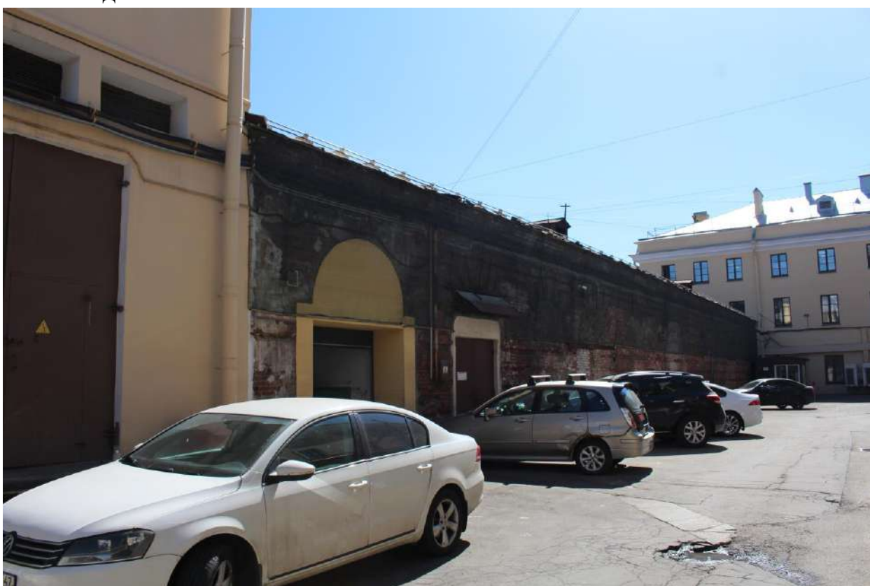
59. Вид на юго-восточный дворовый фасад объекта культурного наследия федерального значения «Казармы (Трехэскадронный корпус)».
