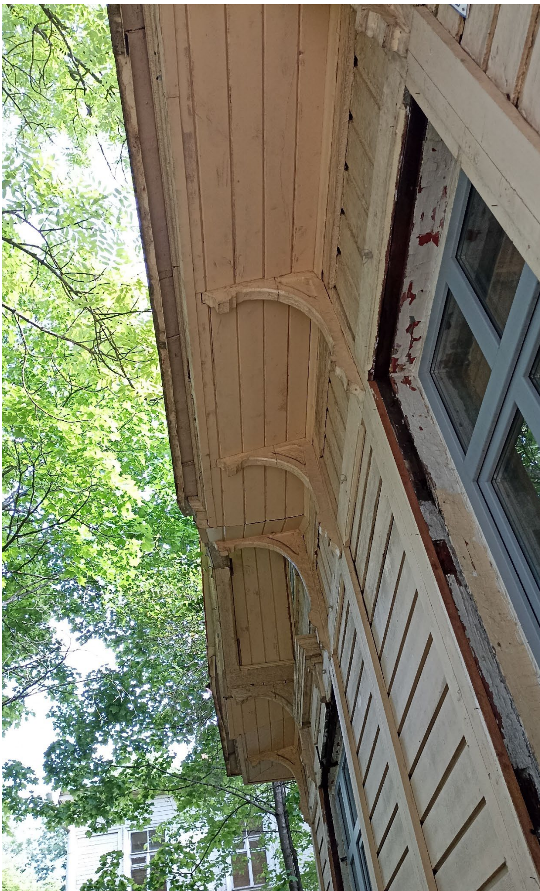
15. Вид снизу на деревянную подшивку с кобылками свесов кровли северного фасада деревянной части здания.
