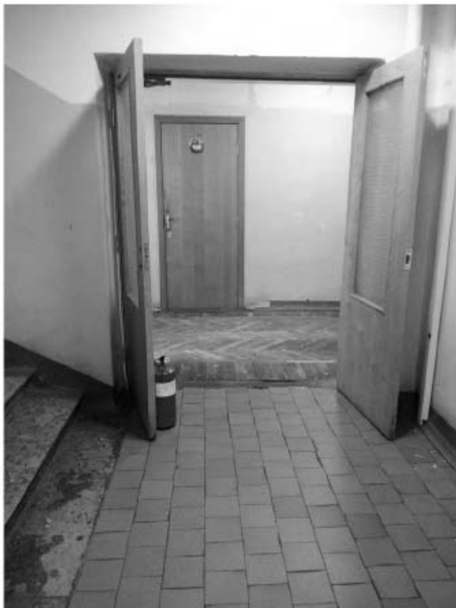
20. Южная часть корпуса. 2ЛК. Площадка в уровне 4 этажа (отделка типовая для этажных площадок данной лестницы).
