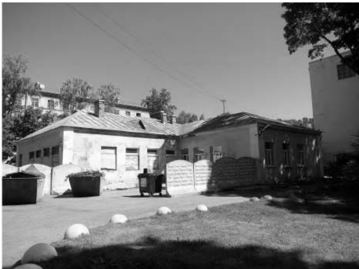
5. Общий вид здания с юго-запада. Оконные проёмы частично заложены. Имеются утраты фрагментов штукатурного карниза, в плоскости фасада – утраты окрасочного и штукатурного слоя, трещины, намокание.
