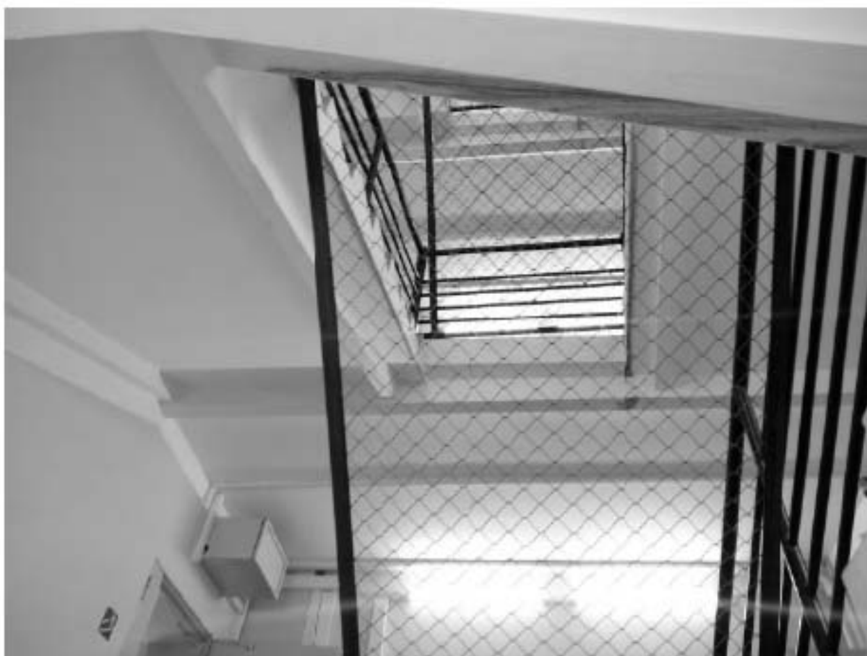
14. Лестница на стыке центрального и южного объёма. Общий вид с площадки 1 этажа.
