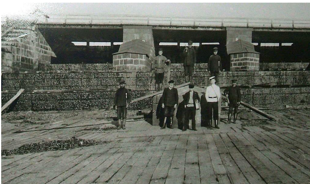
18. Работы по ремонту водосливной плотины Гаусмана. Фото нач. XX в. Источник - https://pastvu.com/p/209196 .
