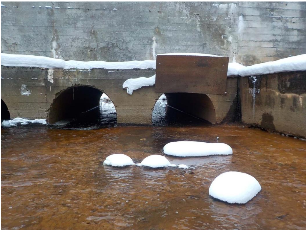
4. «Соляной канал», в составе объекта культурного наследия регионального значения «Ансамбль Сестрорецкого оружейного завода», г. Санкт-Петербург, г. Сестрорецк, ул. Воскова, д. 2, лит. А, сооружение 3. Фрагмент канала. Фото 01.02.2024г.
