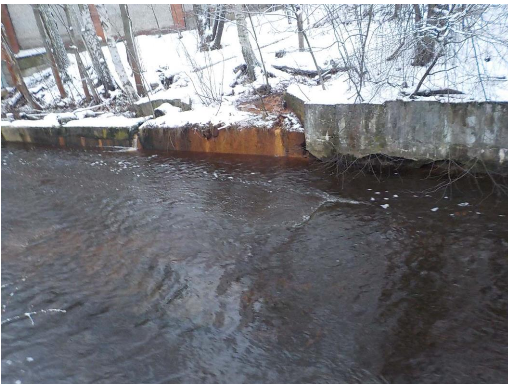
14. «Соляной канал», в составе объекта культурного наследия регионального значения «Ансамбль Сестрорецкого оружейного завода», г. Санкт-Петербург, г. Сестрорецк, ул. Воскова, д. 2, лит. А, сооружение 3. Фрагмент канала. Фото 01.02.2024г.
