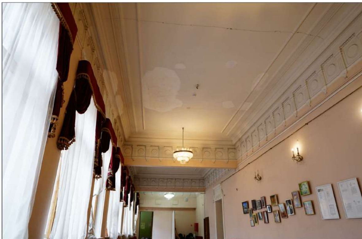
47. Объект культурного наследия федерального значения «Дом собрания рабочих и служащих» по адресу: Санкт-Петербург, Рижский проспект, дом 3, литера Л (Санкт-Петербург, Рижский просп., 3, лит. Д), входящий в состав объекта культурного наследия федерального значения «Экспедиция заготовления государственных бумаг» Помещения 2-го этажа.
