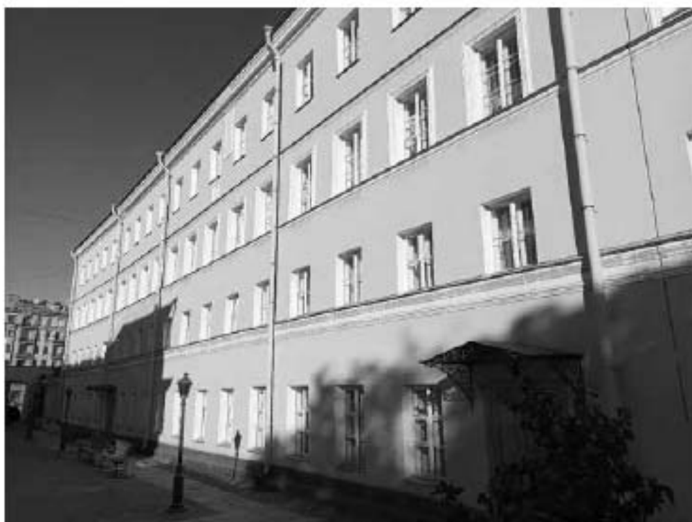
13. Объект культурного наследия федерального значения «Усадьба Державина Г.Р.», по адресу: Санкт-Петербург, наб. реки Фонтанки, д. 118. Флигель (Гостевой корпус). Фрагмент фасада. Дата съемки: 10.10.2022г.
