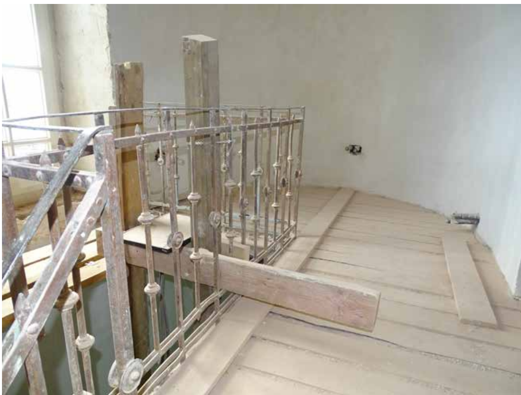
Фото 23. Юго-западная лестница. 2-й этаж. Съемка 01.10.2024 г. Полетайкин В.В.
