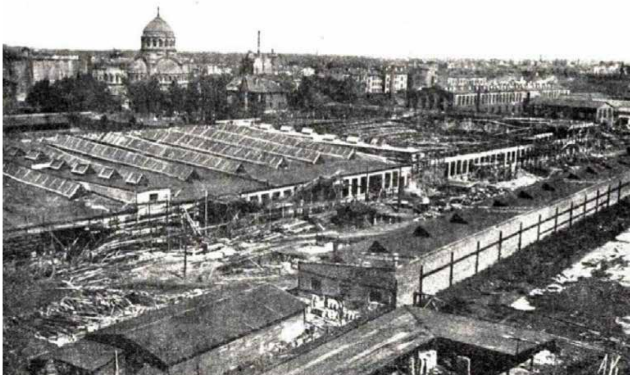
38. Завод «Севкабель». Стройка нового резинового корпуса. На заднем плане - церковь Милующей Божьей Матери в Галерной гавани. Фотография 1932 г. Источник: http://pastvu.com .
