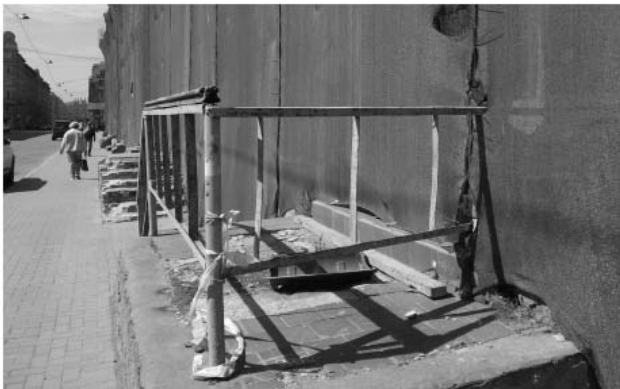
Фото 4. Фрагмент лицевого фасада восточного корпуса со стороны пр. Бакунина. Поздние крыльца. Подлежит восстановлению в исторической конфигурации и материале – известняк.
