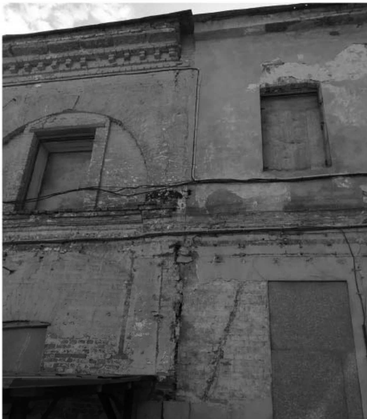
Фото 11. Фрагмент дворовых фасадов восточного и западного корпусов. Граница архитектурно-художественного решения фасадов. В настоящее время фасады здания находятся в не удовлетворительном состоянии: многочисленные трещины кирпичной кладки, деструкция штукатурного и красочного слоев, многочисленные утраты штукатурного слоя по всем фасадам.
