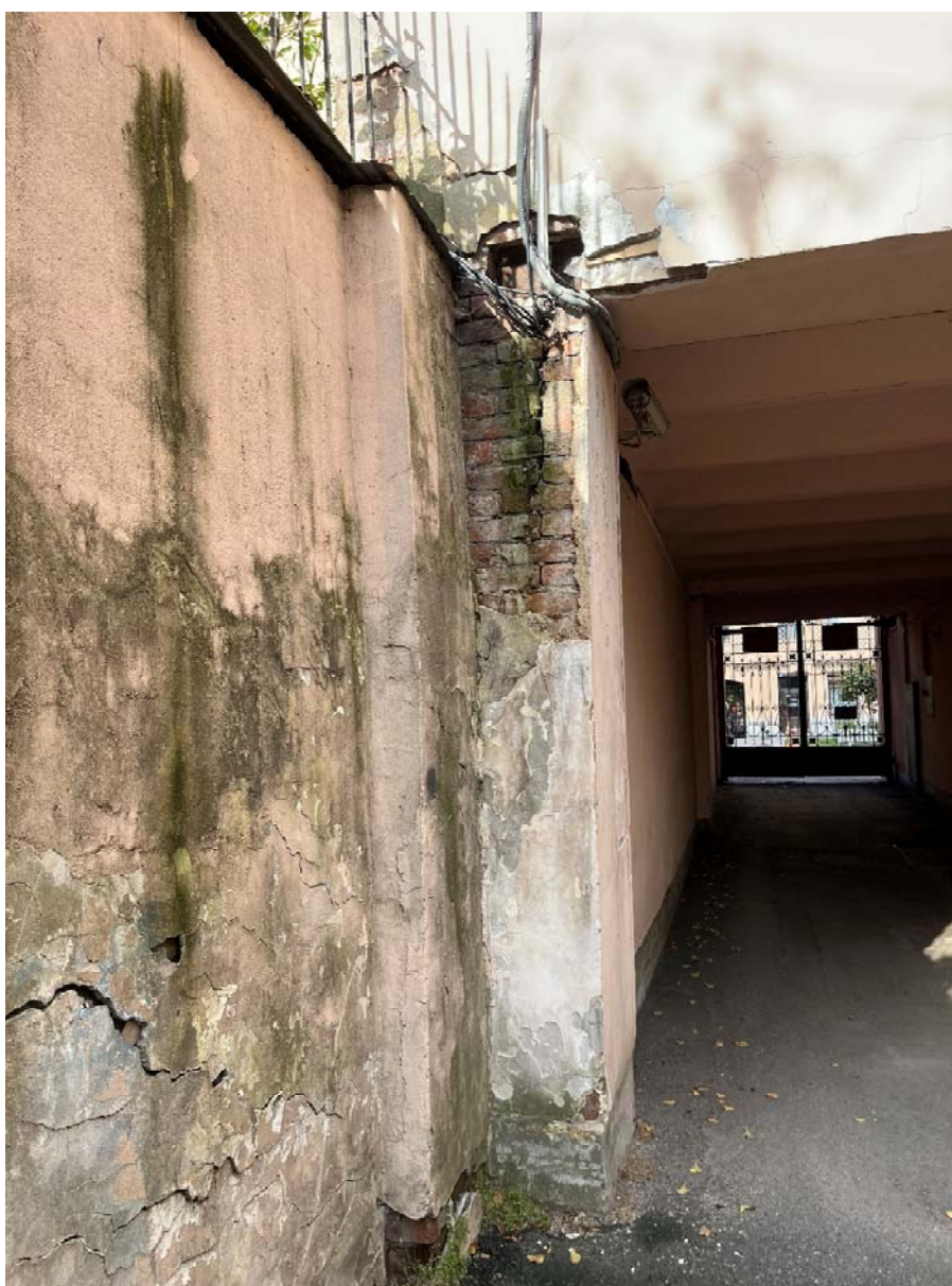
Фото №9. Фрагмент восточного дворового фасада, воротный проезд, трещина в стене в месте прохода сетей.
