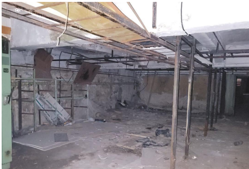
15. Объект культурного наследия регионального значения «Тяговая подстанция “Центральная” (№ 11), обеспечившая восстановление трамвайного движения в блокадном Ленинграде» по адресу: г. Санкт-Петербург, набережная реки Фонтанки, дом 3а, лит. А. Подвал. Общий вид.
