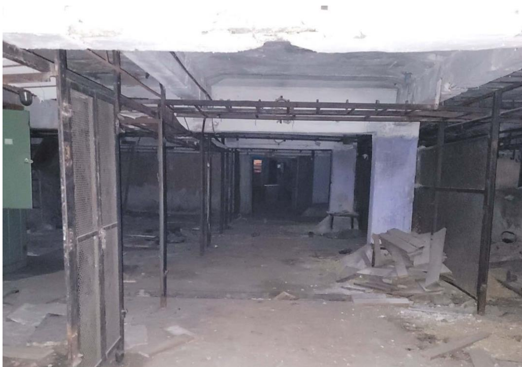
14. Объект культурного наследия регионального значения «Тяговая подстанция “Центральная” (№ 11), обеспечившая восстановление трамвайного движения в блокадном Ленинграде» по адресу: г. Санкт-Петербург, набережная реки Фонтанки, дом 3а, лит. А. Подвал. Общий вид.
