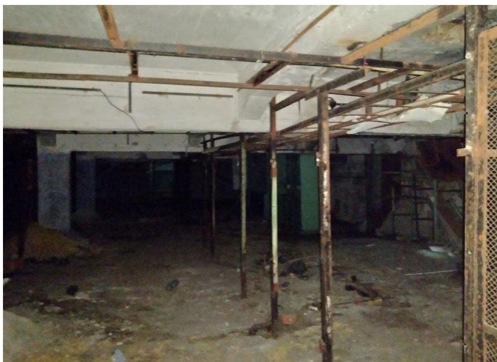
17. Объект культурного наследия регионального значения «Тяговая подстанция “Центральная”» (№ 11), обеспечившая восстановление трамвайного движения в блокадном Ленинграде» по адресу: г. Санкт-Петербург, набережная реки Фонтанки, дом 3а, лит. А. Подвал. Фрагмент интерьера. Перекрытие.
