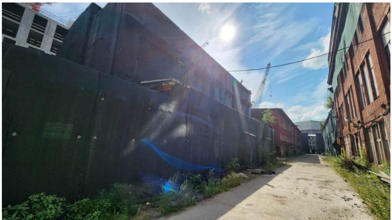
6. Вид на выявленный объект культурного наследия «Кожевенный завод А.А. Парамонова. Котельная», по адресу: г. Санкт-Петербург, Кожевенная линия, д. 1-3, литера Д, и зону производства работ. 14.08.2024
