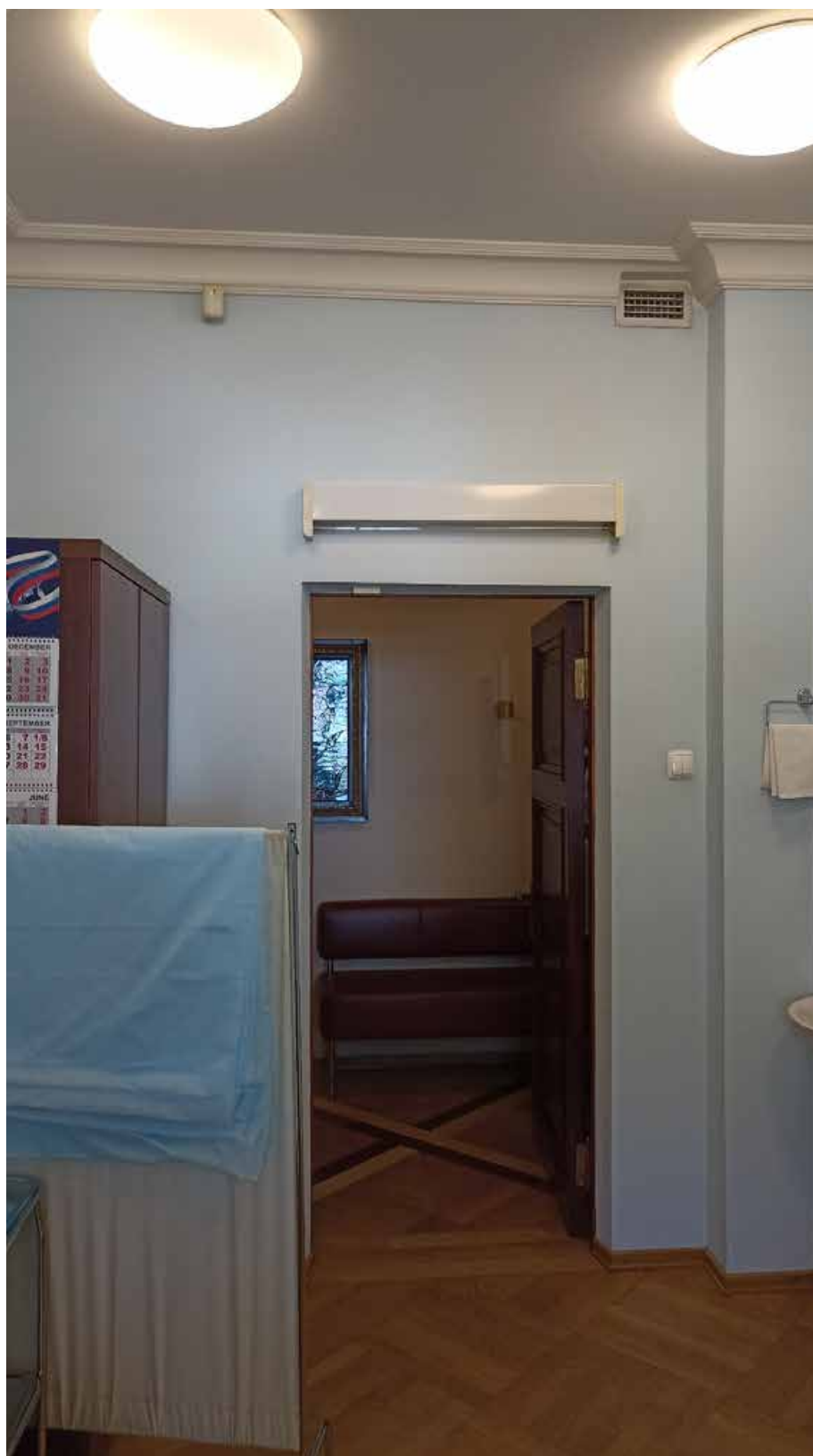
13. 1-й этаж, помещение 111. Вид на место предполагаемой установки кондиционера (над дверным проемом).
