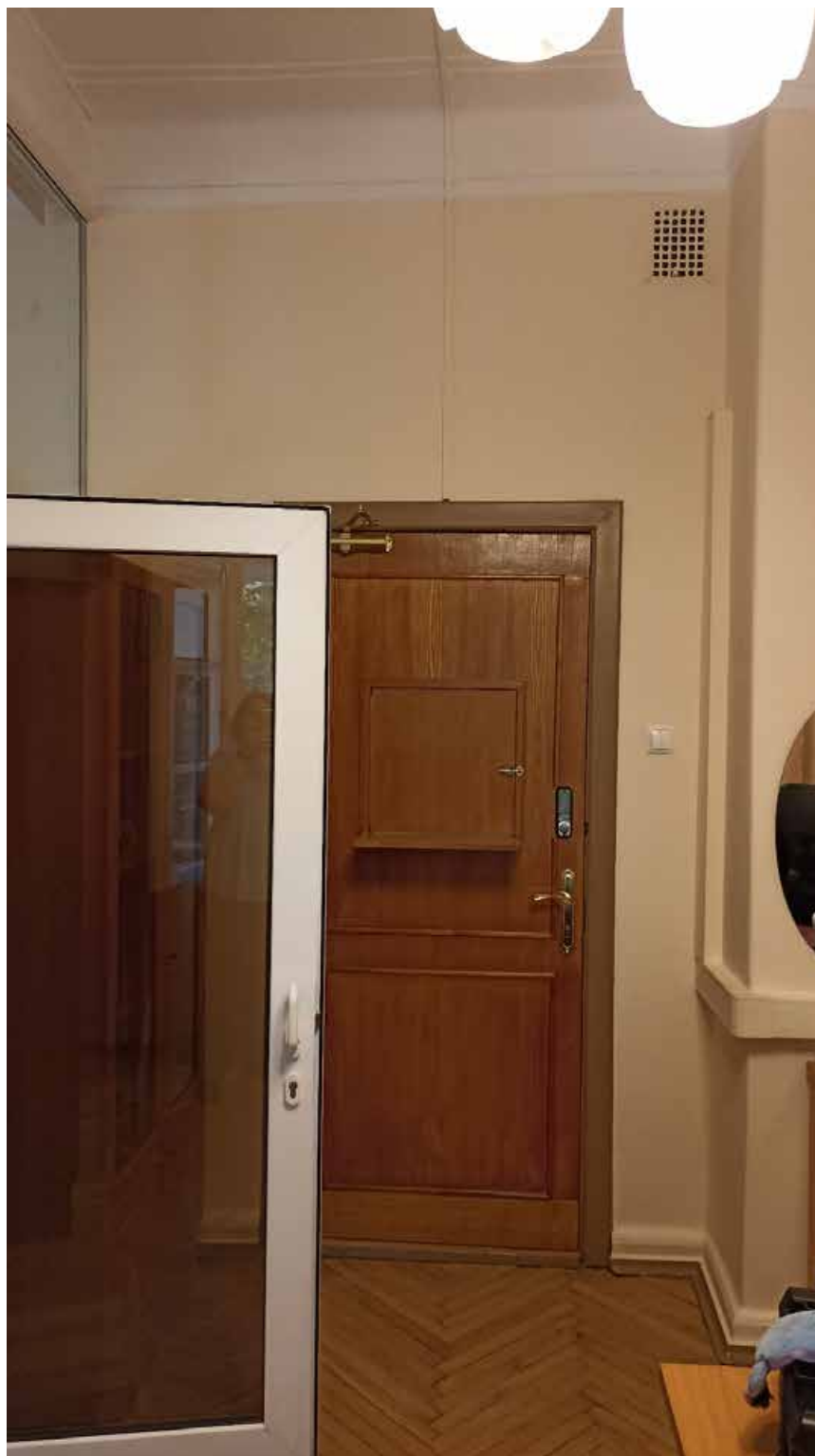
49. 4-й этаж, помещение 403. Вид на место предполагаемой установки кондиционера (над дверным проемом).
