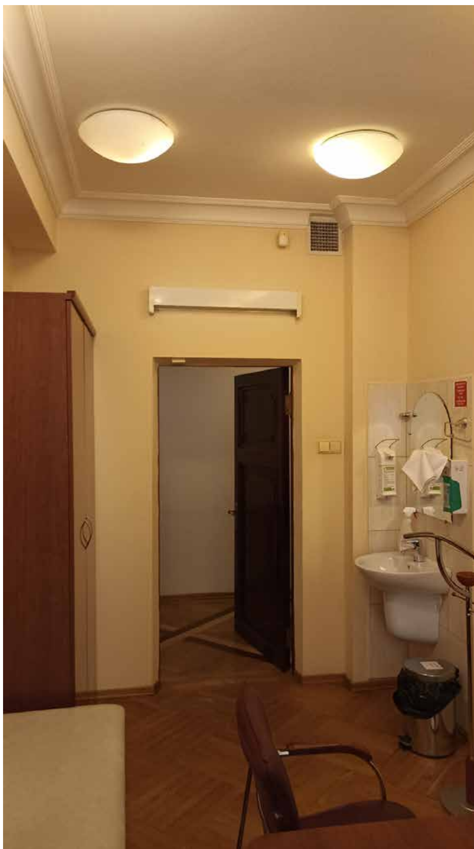
16. 1-й этаж, помещение 114. Вид на место предполагаемой установки кондиционера (над дверным проемом).
