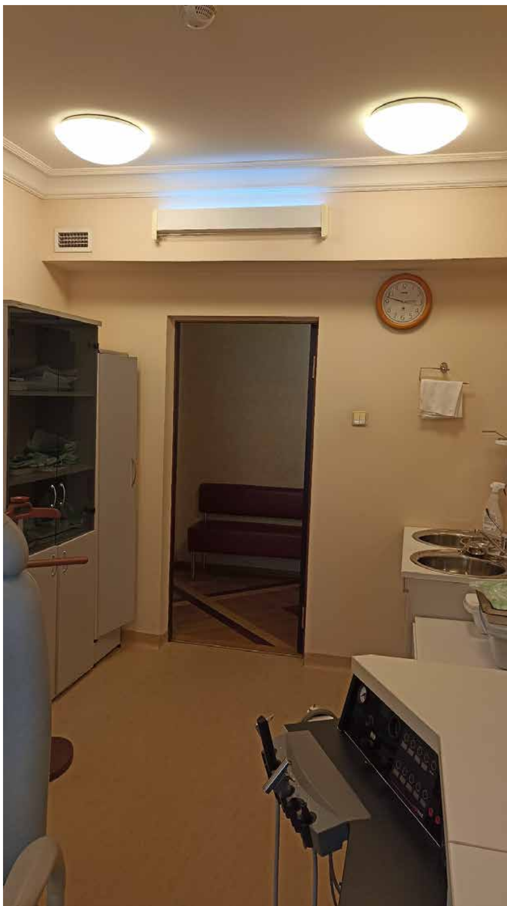
24. 2-й этаж, помещение 205. Вид на место предполагаемой установки кондиционера (над дверным проемом).
