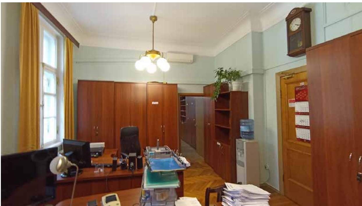
65. 5-й этаж, помещение 502. Вид на место предполагаемой установки кондиционера (над дверным проемом).
