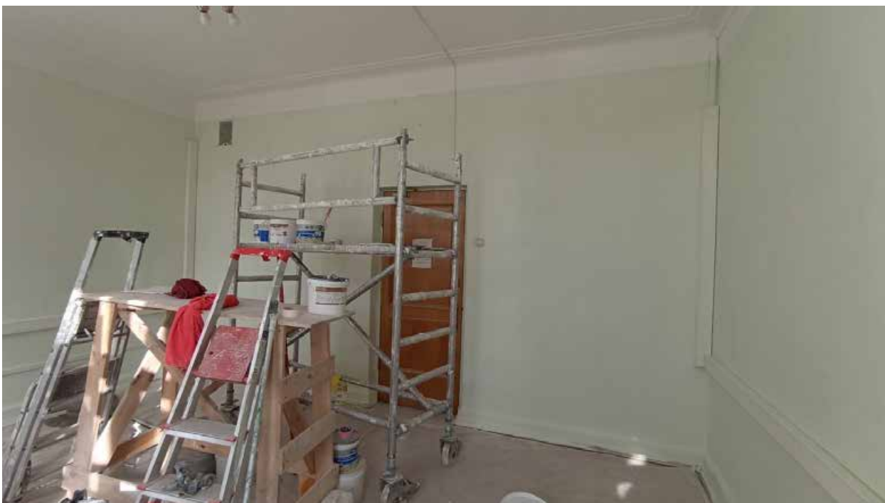
61. 4-й этаж, помещение 429. Вид на место предполагаемой установки кондиционера (над дверным проемом).
