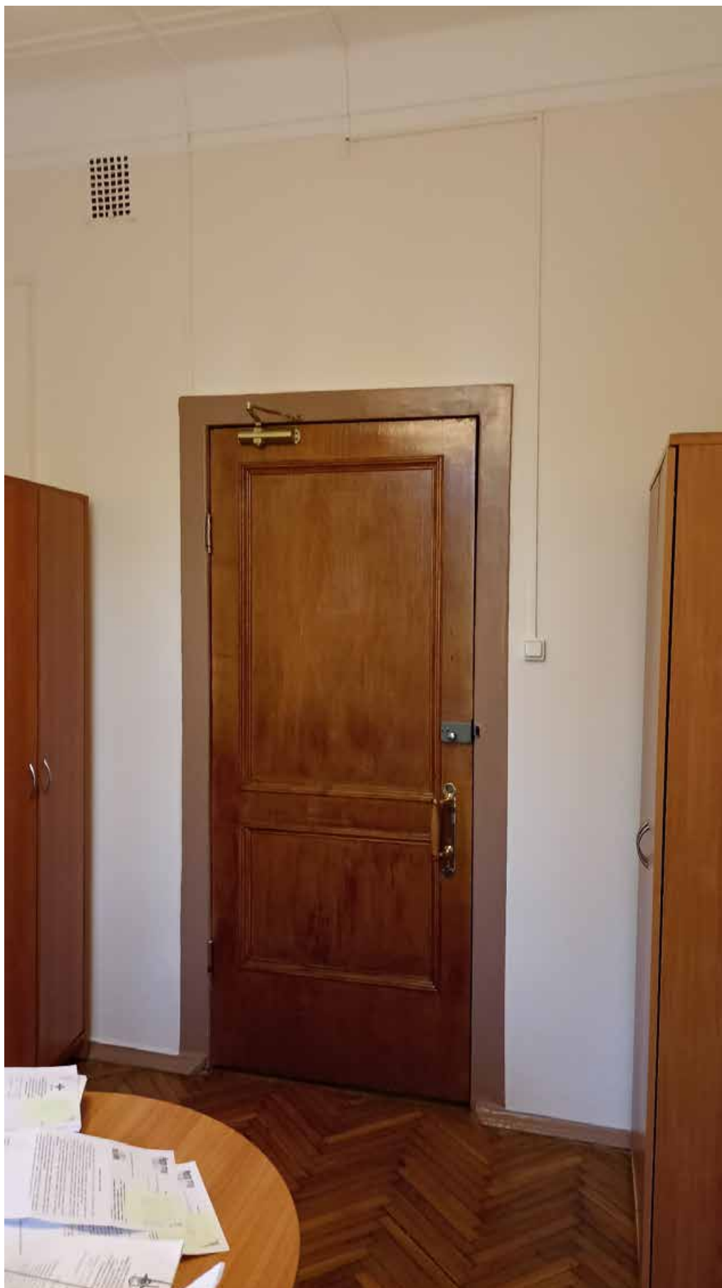
56. 4-й этаж, помещение 414. Вид на место предполагаемой установки кондиционера (над дверным проемом).
