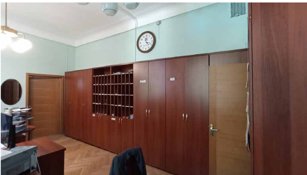
66. 5-й этаж, помещение 503. Вид на место предполагаемой установки кондиционера (над дверным проемом).
