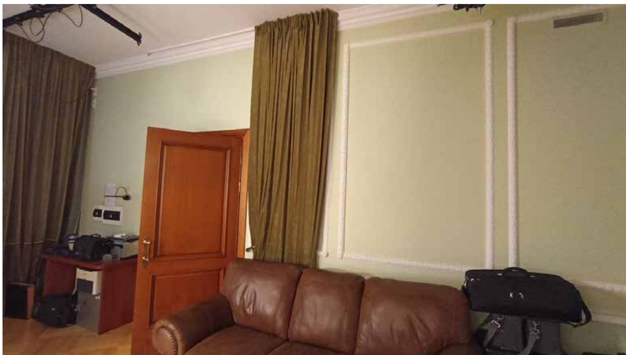
75. 5-й этаж, помещение 515. Вид на место предполагаемой установки кондиционера (над дверным проемом).
