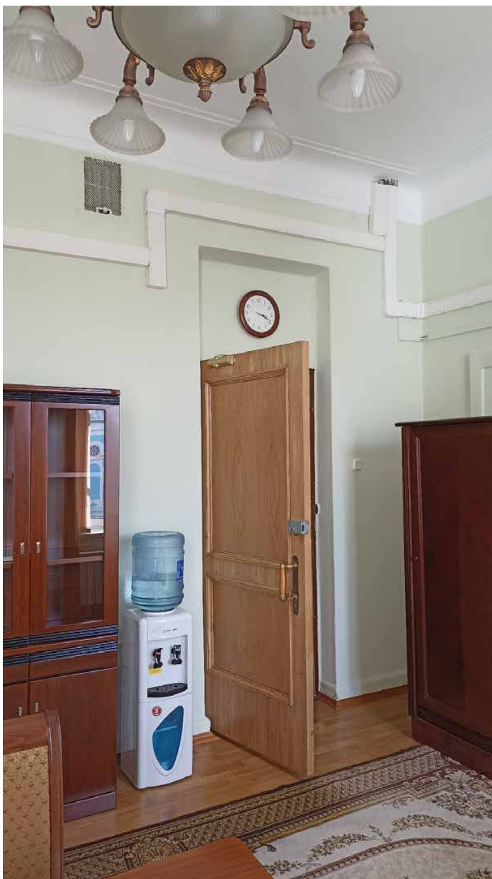
47. 3-й этаж, помещение 329. Вид на место предполагаемой установки кондиционера (над дверным проемом).
