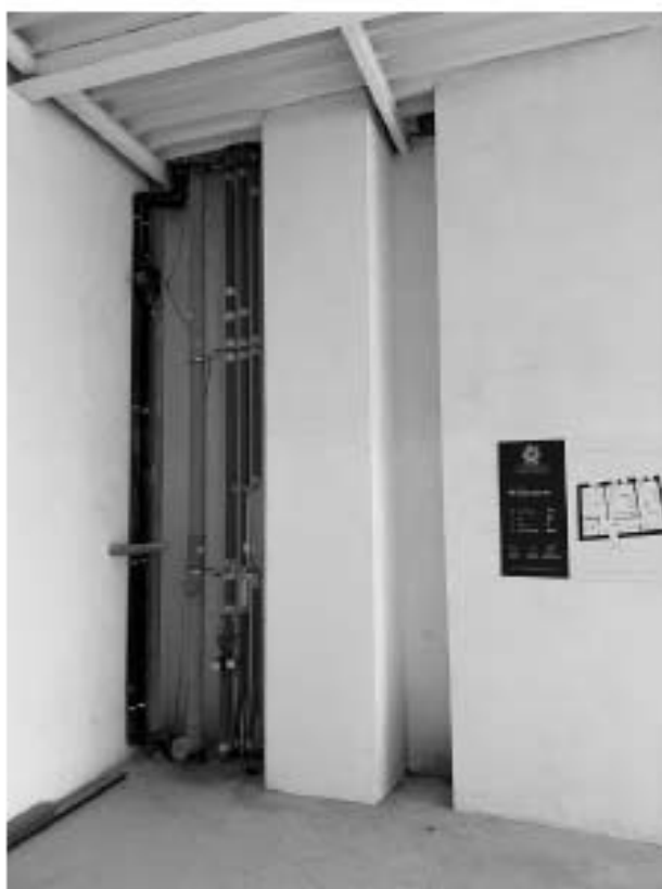
Фото 9. Интерьер пом. 7-Н объекта культурного наследия регионального значения «Доходный дом и издательство С.М. Прошера»
