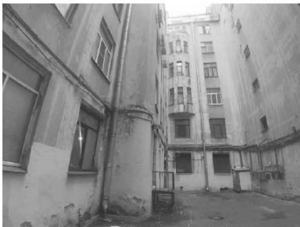
37. «Дом А.Д. Дальберга и И.А. Кохендерфер» (Большой пр. П.С., д. 106, лит. А). Дворовый фасад с показанием проектируемых мест установки оборудования и кабельных трасс. Штиглиц М.С. 07.11.2024.
