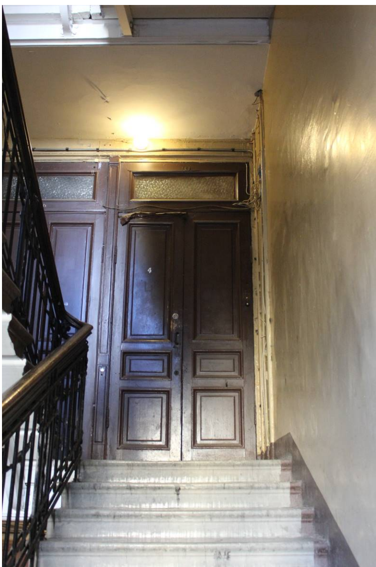
9. Выявленный объект культурного наследия «Дом И.И. Боргмана», по адресу: г. Санкт-Петербург, Съезжинская улица, дом 4, литера А. Общий вид лестничной клетки. Дата фотофиксации: 28 августа 2021 г.
