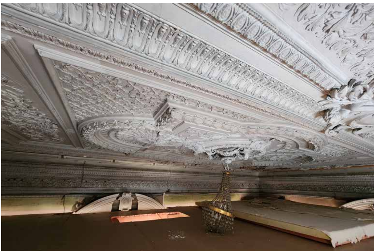
Фото 11. Аванзал. Помещение 24-Н (19). Потолок. Вид со стороны окон.
