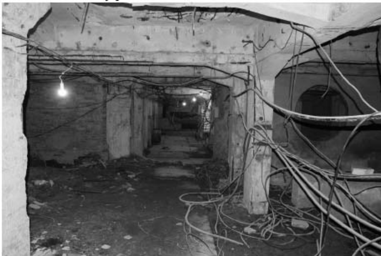
Фото 40. Объект культурного наследия регионального значения «Производственные корпуса трикотажной фабрики «Красное знамя». Внутренние помещения цокольного этажа.
