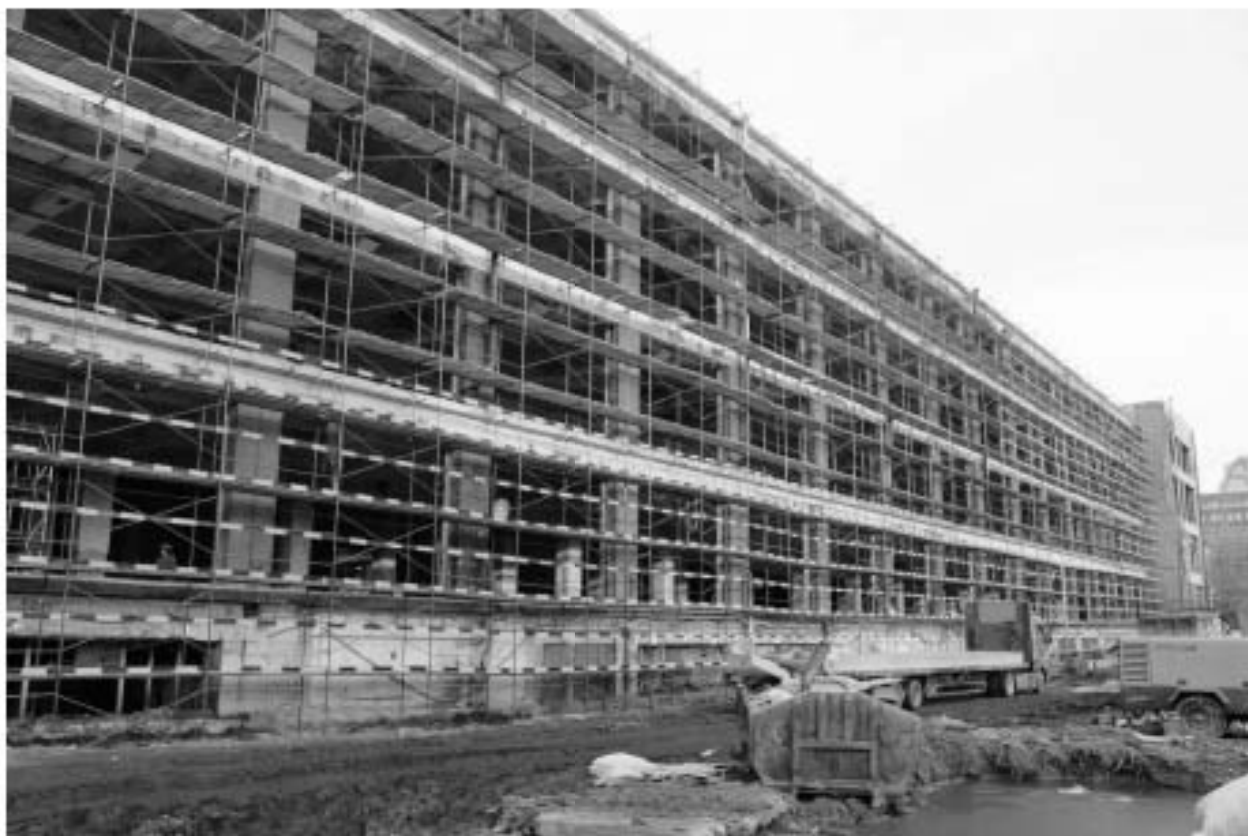
Фото 3. Вид на юго-восточный фасад Главного трикотажного цеха (1 очередь) объекта культурного наследия регионального значения «Производственные корпуса трикотажной фабрики «Красное знамя».
