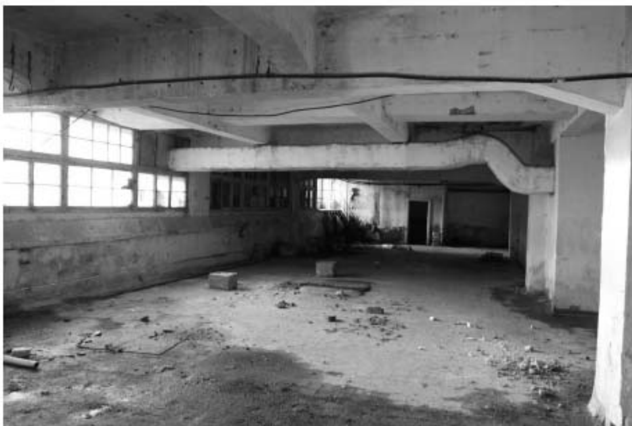
Фото 21. Объект культурного наследия регионального значения «Производственные корпуса трикотажной фабрики «Красное знамя». Внутренние помещения цокольного этажа.
