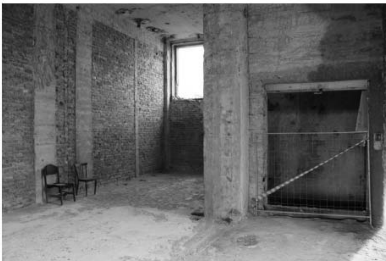
Фото 99. Объект культурного наследия регионального значения «Производственные корпуса трикотажной фабрики «Красное знамя». Внутренние помещения 3-го этажа.
