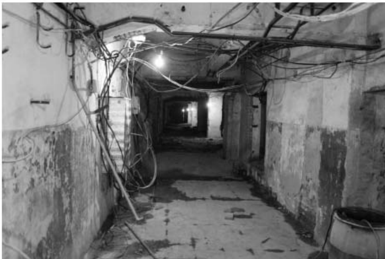
Фото 33. Объект культурного наследия регионального значения «Производственные корпуса трикотажной фабрики «Красное знамя». Внутренние помещения цокольного этажа.
