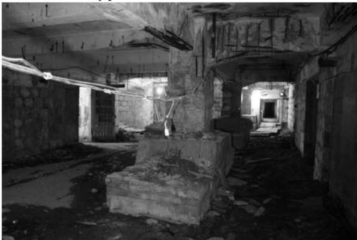
Фото 62. Объект культурного наследия регионального значения «Производственные корпуса трикотажной фабрики «Красное знамя». Внутренние помещения цокольного этажа.
