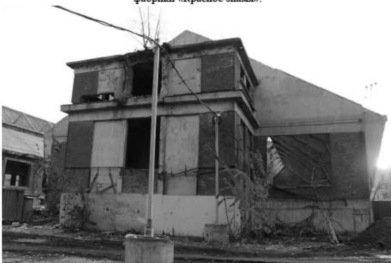
Фото 6. Вид на северо-западный фасад Красильного цеха объекта культурного наследия регионального значения «Производственные корпуса трикотажной фабрики «Красное знамя».
