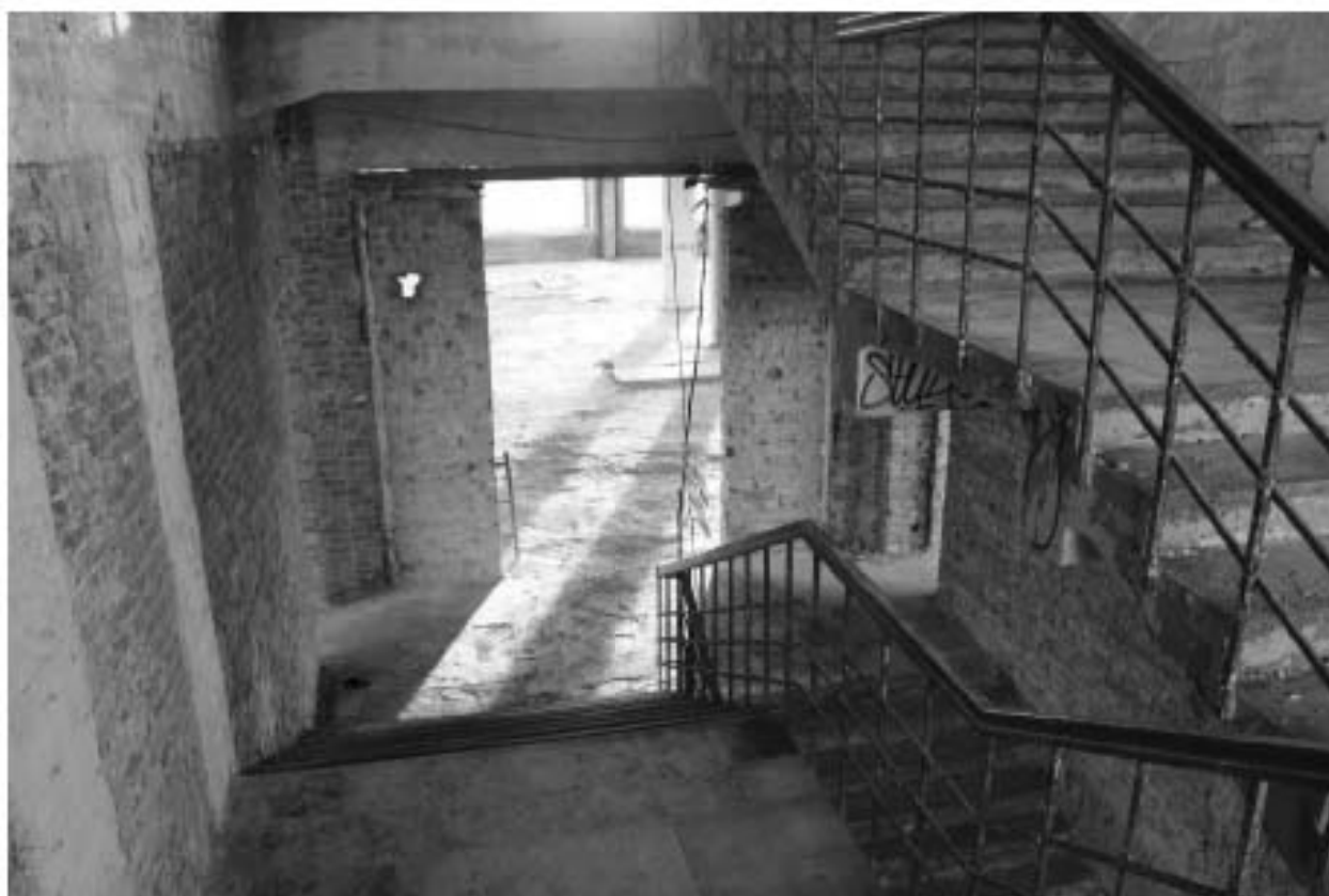
Фото 111. Объект культурного наследия регионального значения «Производственные корпуса трикотажной фабрики «Красное знамя». Лестничная клетка Л-2 в уровне 4-го - 5-го этажей.
