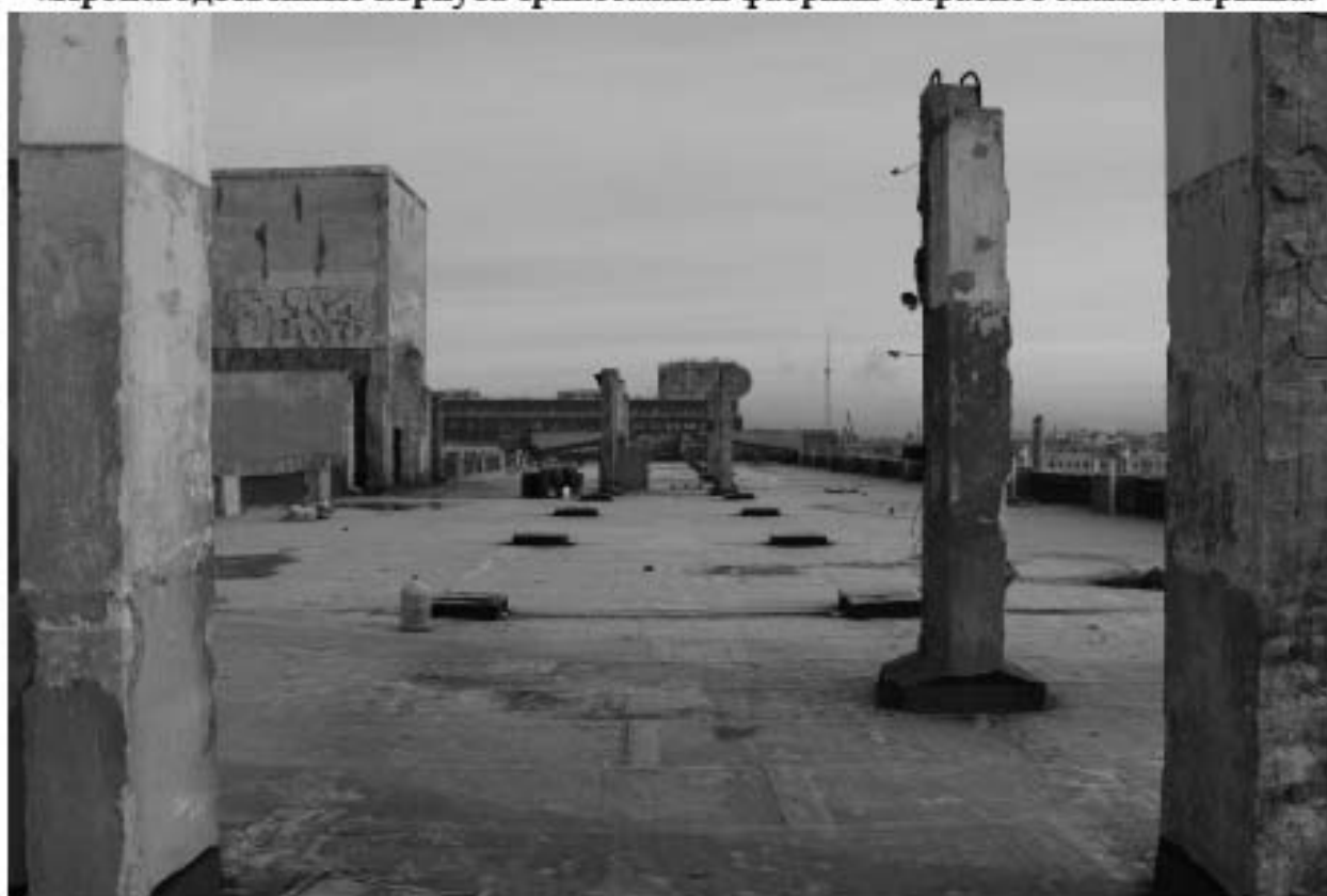
Фото 116. Объект культурного наследия регионального значения «Производственные корпуса трикотажной фабрики «Красное знамя». Крыша.
