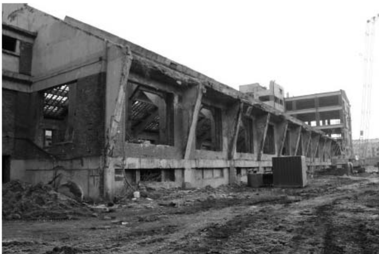
Фото 5. Вид на юго-западный фасад Красильного цеха объекта культурного наследия регионального значения «Производственные корпуса трикотажной фабрики «Красное знамя».
