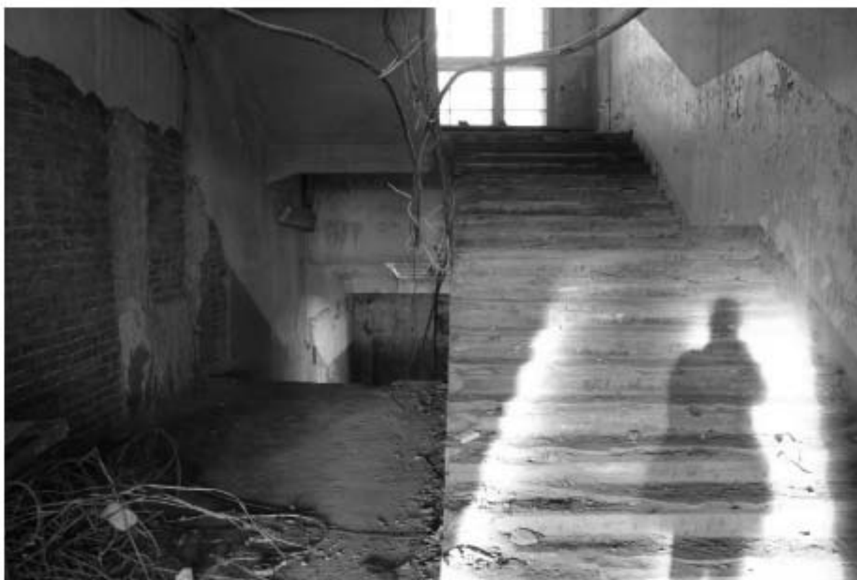
Фото 83. Объект культурного наследия регионального значения «Производственные корпуса трикотажной фабрики «Красное знамя». Лестничная клетка Л-3 в уровне 2-го этажа.
