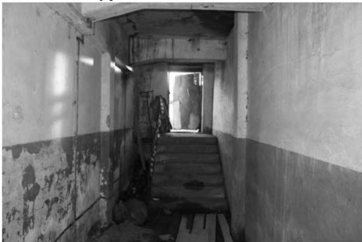
Фото 46. Объект культурного наследия регионального значения «Производственные корпуса трикотажной фабрики «Красное знамя». Лестница Л-3 в уровне цокольного - 1-го этажа.
