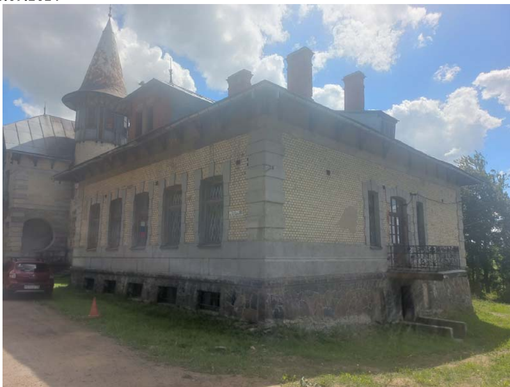
Фото 2. ОКН «Больница общины Святого Георгия» по адресу: г. Санкт-Петербург, г. Красное Село, пр. Двадцать Пятого Октября, д. 105, лит.А, Северный и Западный фасад. Дата съемки 10.09.2024
