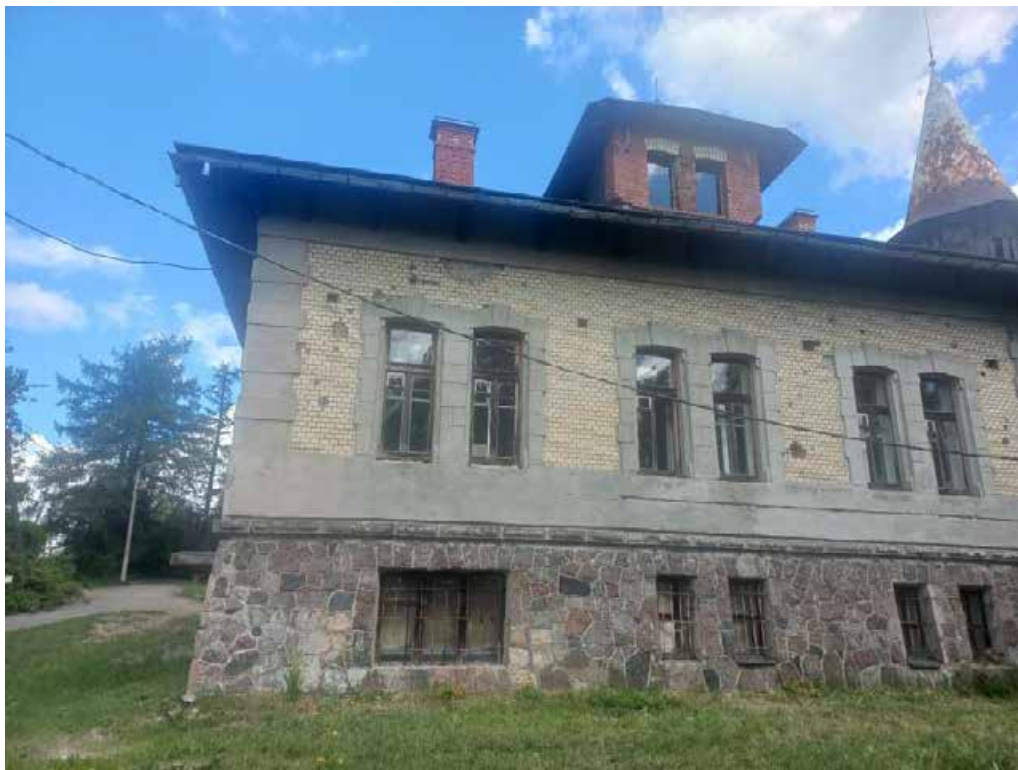
Фото 5. ОКН «Больница общины Святого Георгия» по адресу: г. Санкт-Петербург, г. Красное Село, пр. Двадцать Пятого Октября, д. 105, лит.А, Южный фасад. Дата съемки 10.09.2024
