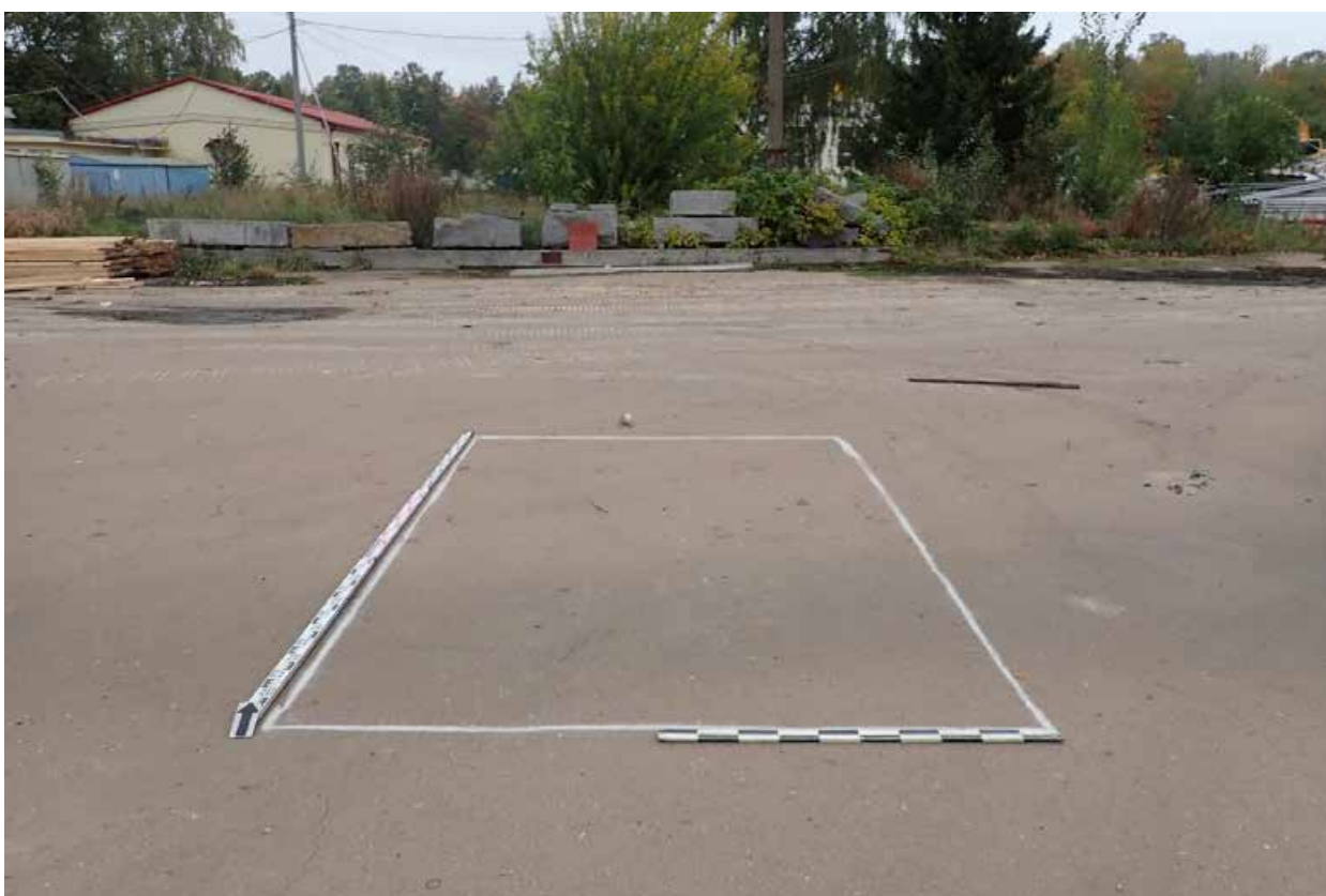
Рис. 30. Санкт-Петербург, Калининский район, муниципальный округ Пискаревка проспект Мечникова, дом 40, литера А, участок к/н 78:10:0005142:1456. Шурф 2 до начала работ. Вид с Ю.
