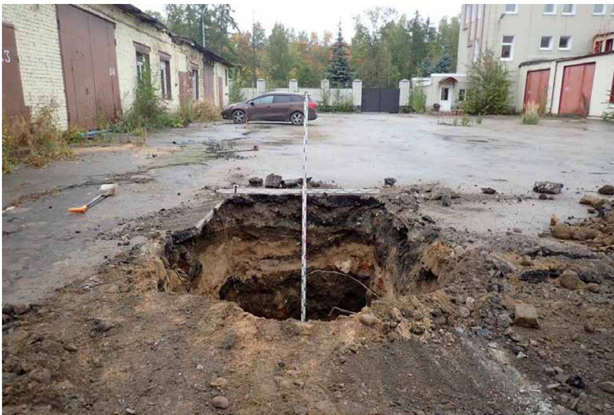
Рис. 19. Санкт-Петербург, Калининский район, муниципальный округ Пискаревка проспект Мечникова, дом 40, литера А, участок к/н 78:10:0005142:1456. Шурф 1. Выкопанный шурф с включением окружающего пейзажа. Вид с Ю.
