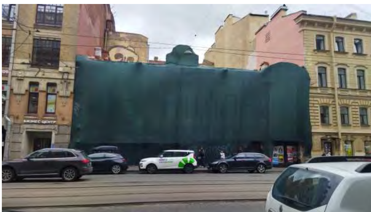
Фото 28. Объект культурного наследия регионального значения «Особняк В.И. Турчаниновой» (Санкт-Петербург, Средний пр. В.О., 40, литера А). Общий вид с северной стороны.
