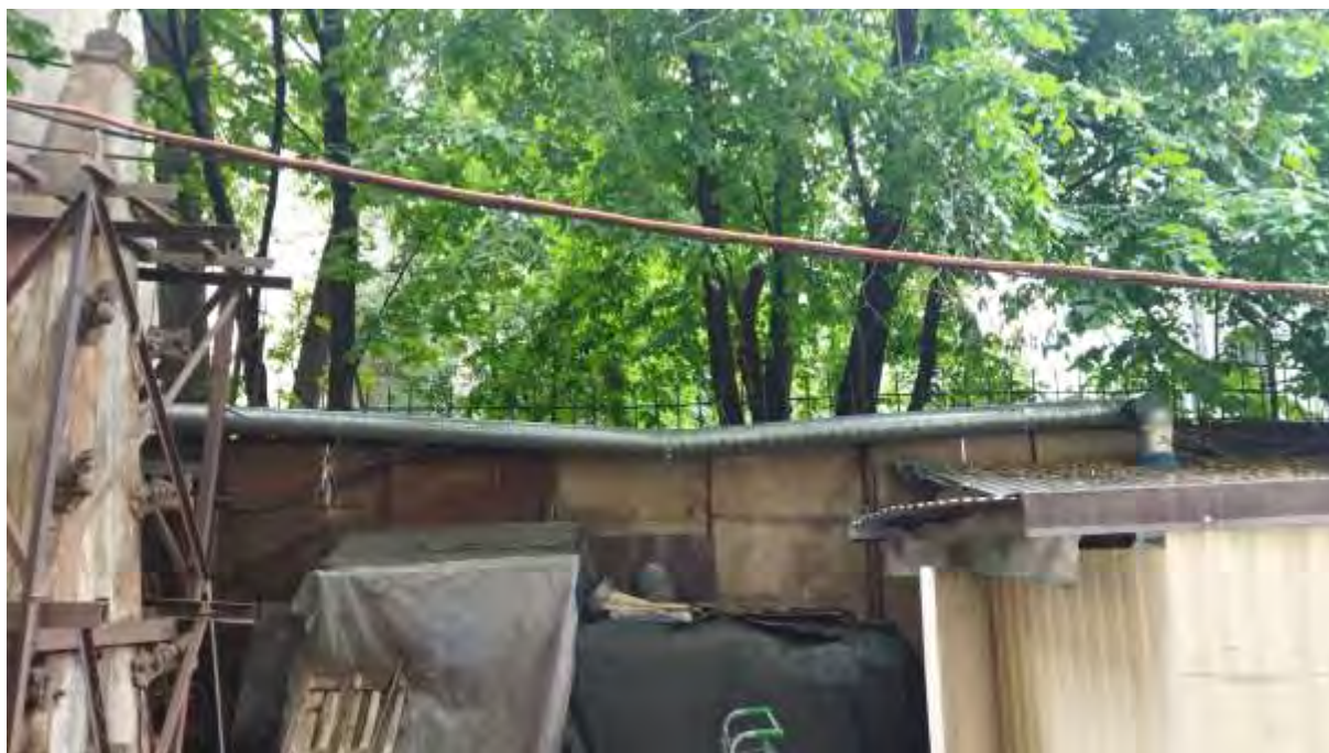
Фото 42. Объект культурного наследия регионального значения «Здание женской рукодельной хозяйственной школы им. А.Г. Елисеева» (Санкт-Петербург, 4-я линия В.О., д. 27/20, литера А). Общий вид с восточной стороны.
